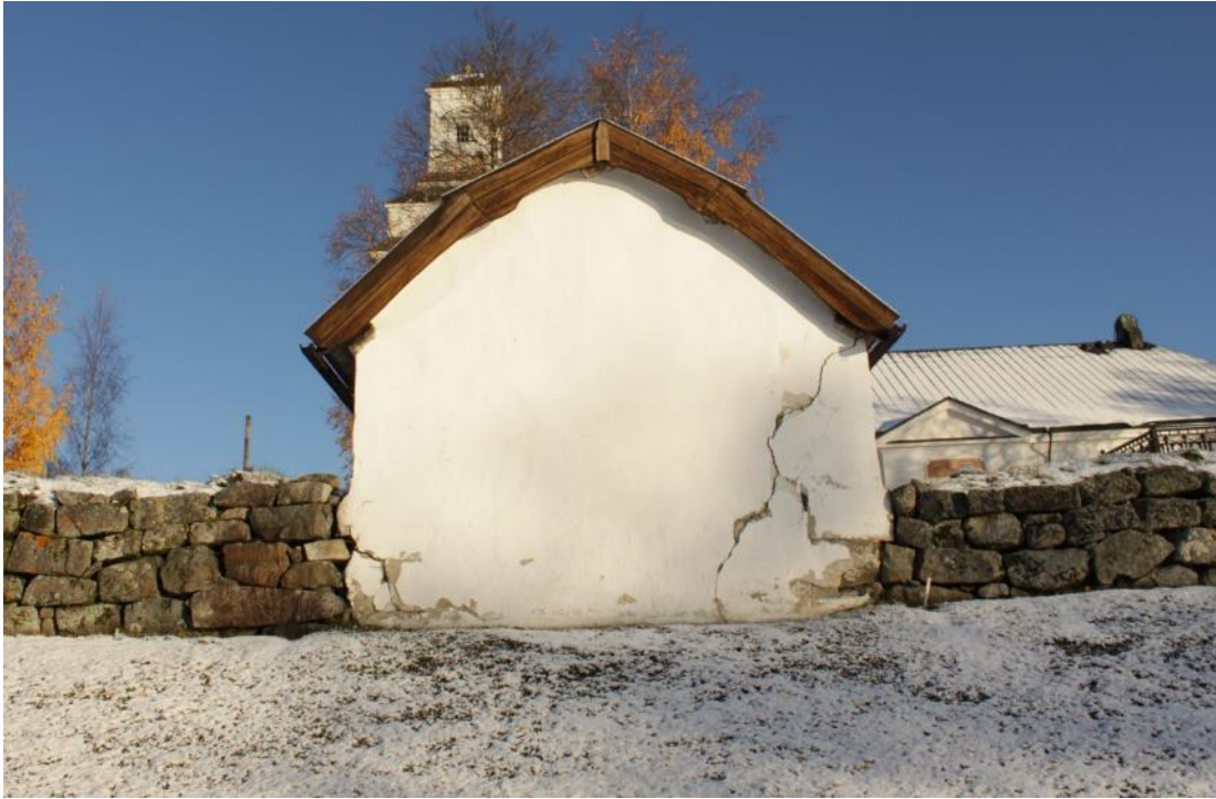
Figur 44 Skador på "Hofverbergska gravhuset".
