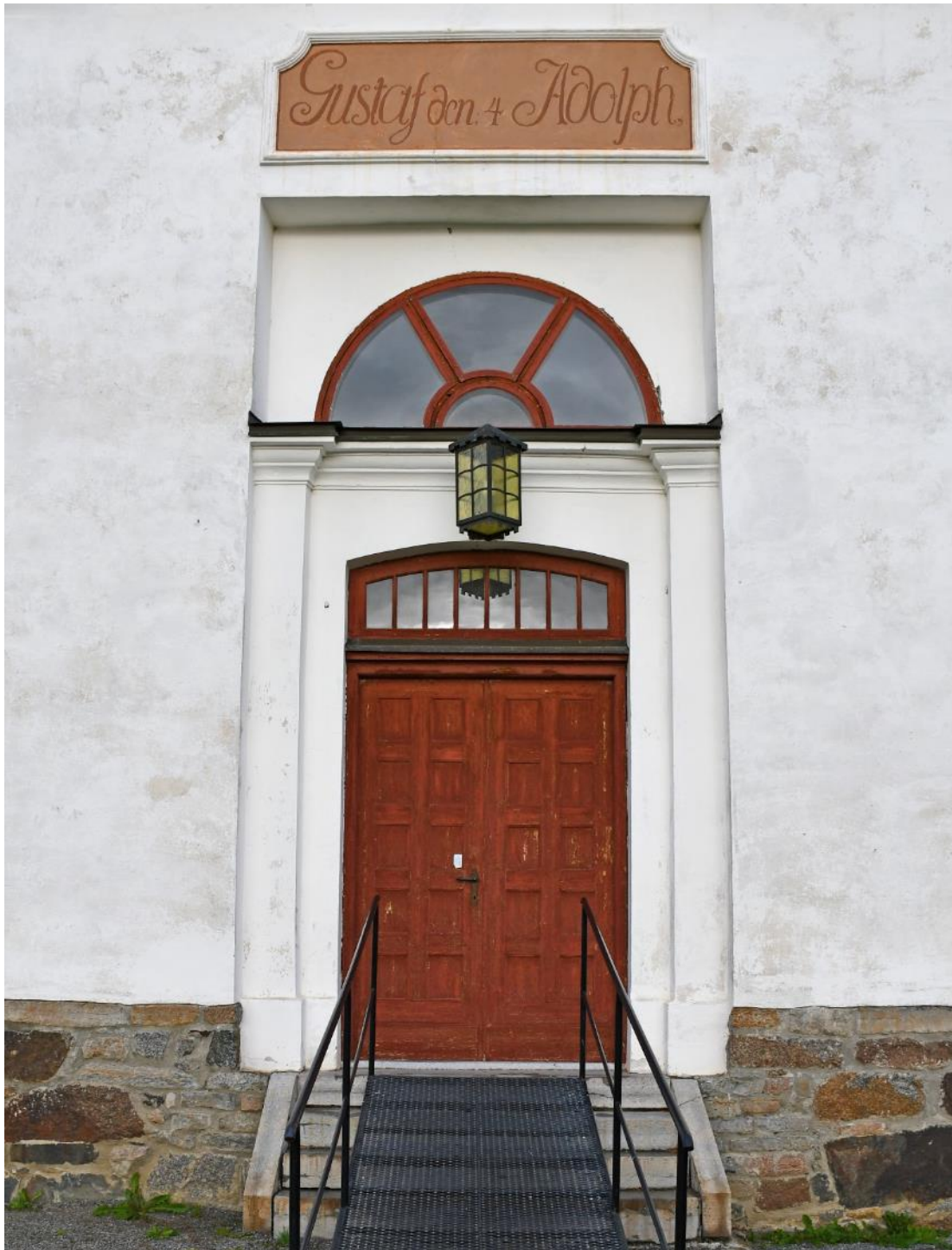
Figur 21 På södra fasaden finns en mittportal placerad på en svagt framspringande risalit. Ovanför portalen finns ett brunt fält innanför ett ramverk i puts med texten Gustaf den 4 Adolph, målad med linoljafärg direkt på putsen.
