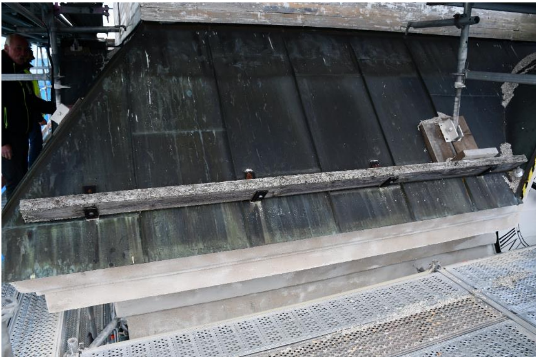
Figur 35 På västra sidan av tornet satt snörasskydd i två nivåer. Vinkeljärnsprofiler fungerat som konsoler för snörasskyddet. Konsolerna var fästade med bult genom plåten. Snörasskydden utgjordes av plank.
