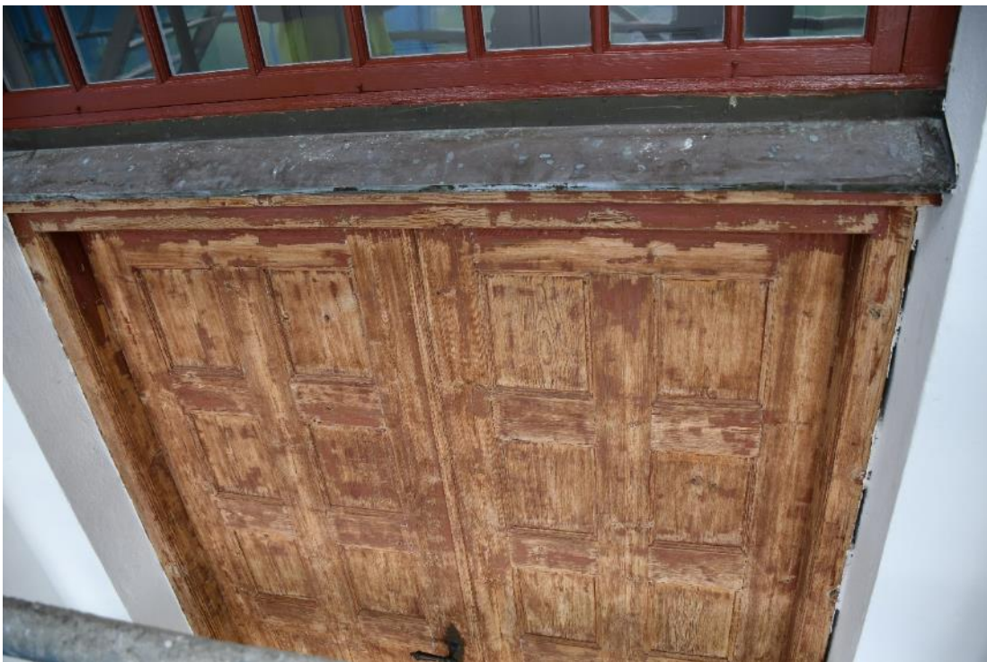
Figur 23 Dörr efter skrapning.
