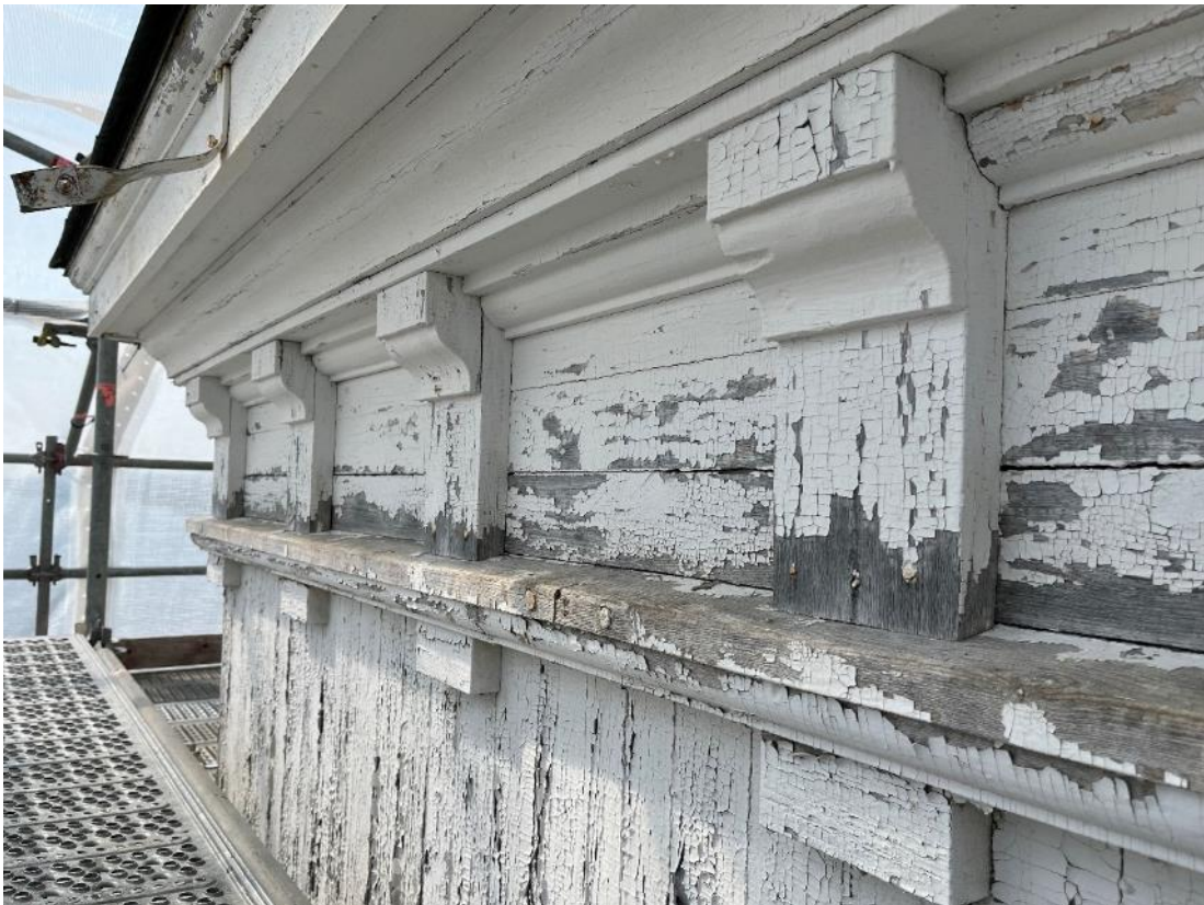
Figur 14 Listverk på lanterninen före åtgärd.
