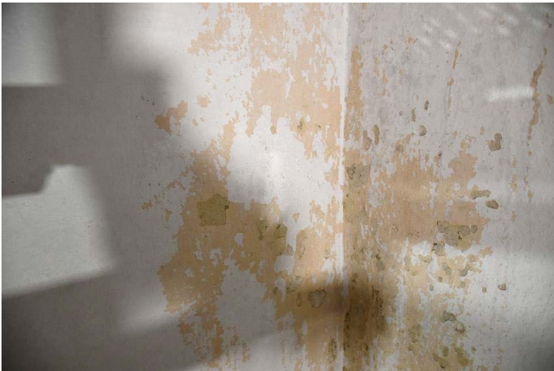
Figur 39 I vapenhuset flagade den vita avfärgningen på väggarna.
