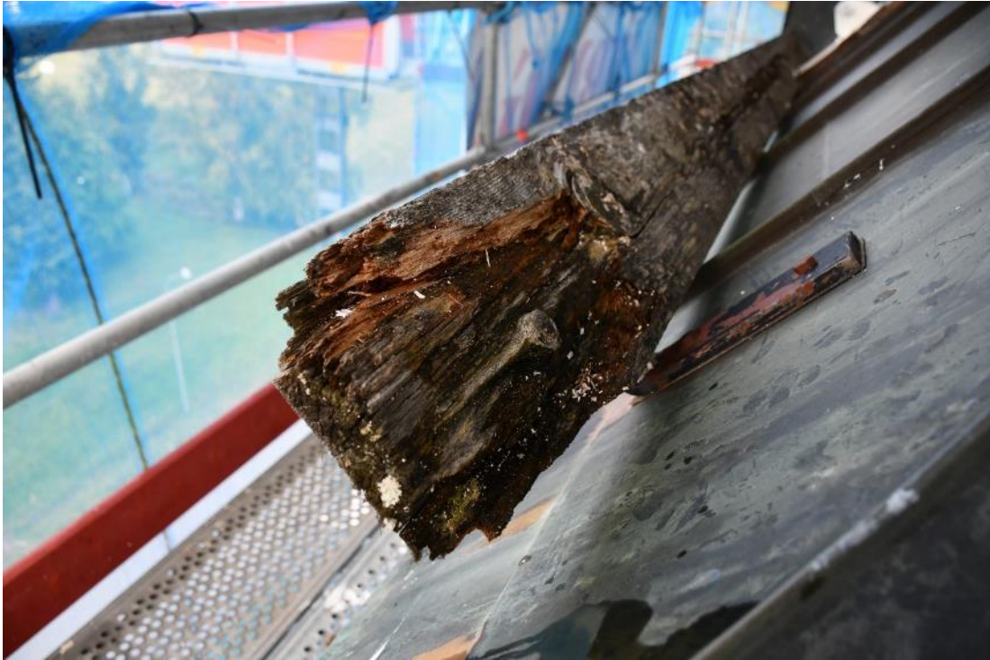
Figur 36 Planken var rötskadade och mjuka.
