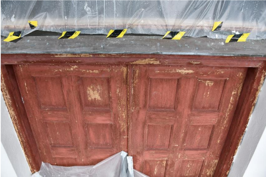
Figur 22 Dörr före åtgärd.
