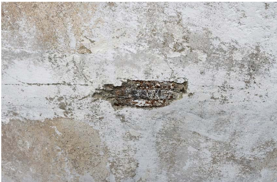
Figur 6 Ankarjärn stack fram här och var på fasaden. Dessa ligger delvis så pass ytligt att det inte ansågs lämpligt att putsa över dem.
