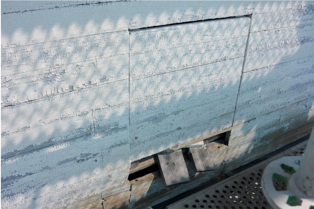
Figur 13 På flera ställen på lanterninen finns små luckor. På två av luckorna saknades den nedersta brädan.
