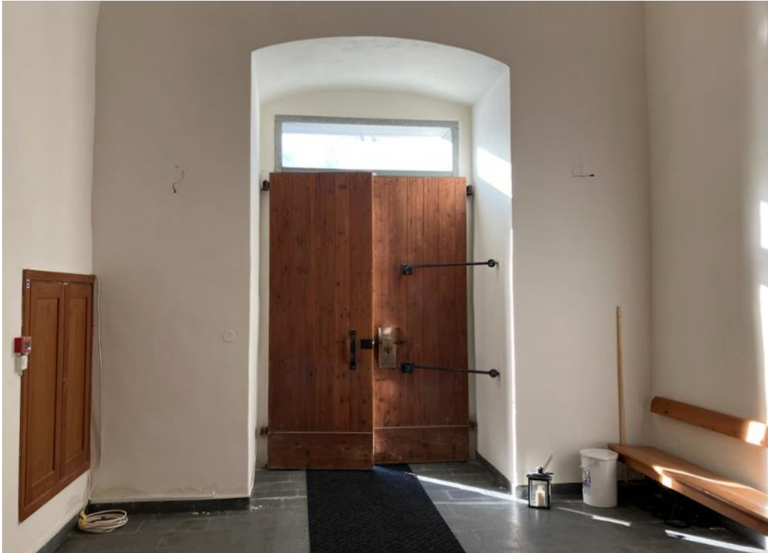
Figur 42 Vapenhus efter åtgärd. Färgsläpp förekom nedtill mot sockeln till vänster om dörren (foto: Cristofer Said).
