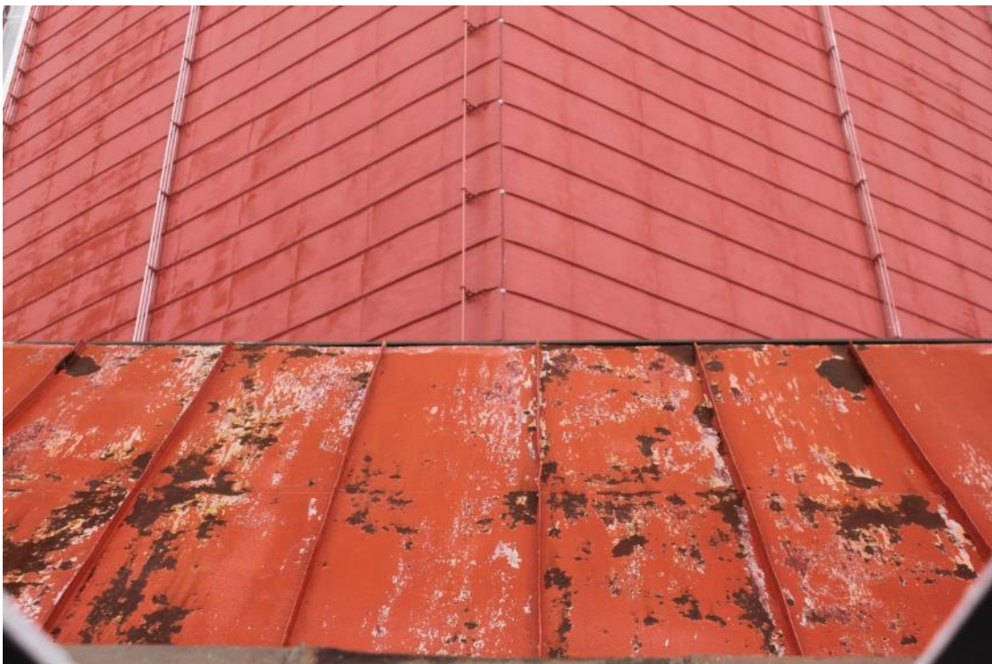
Figur 5 Tornhuvens färgskikt flagade och plåten var rostangripen.
