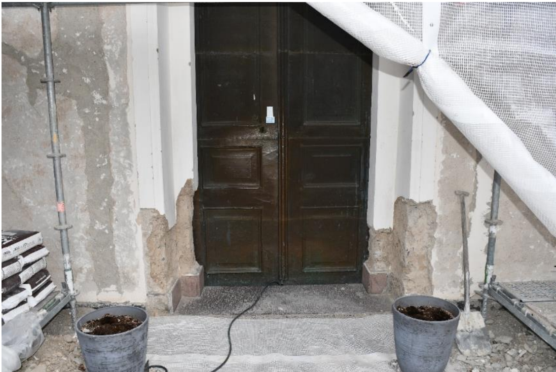
Figur 43 Den putsade inramningen till entrépartiet på tornet avslutas neråt med en kalkstenslist. Delar av kalkstenslisten saknades före åtgärd.
