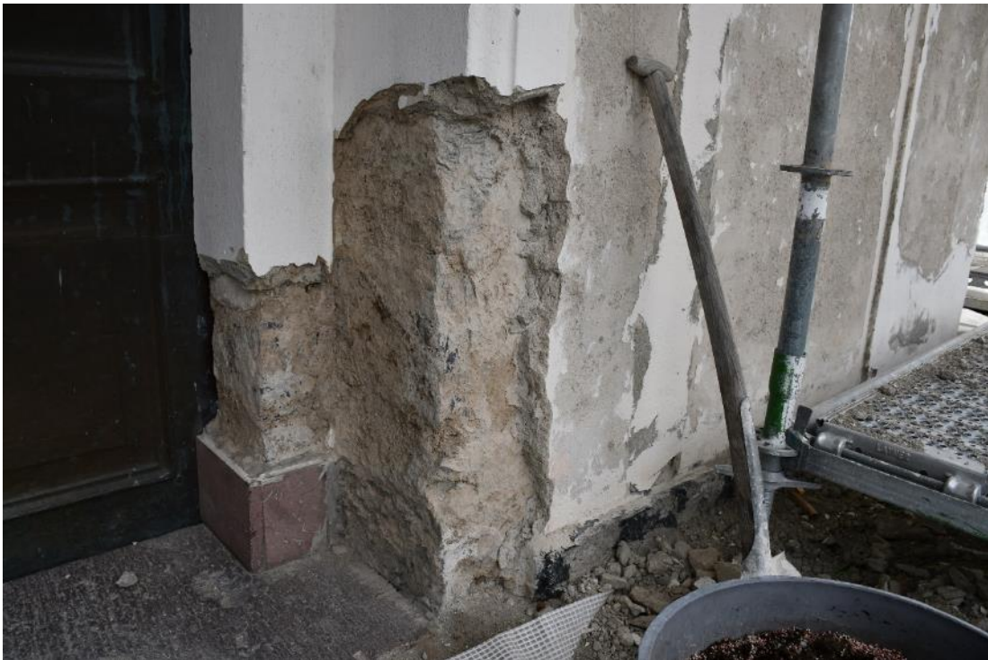
Figur 45 Nedknackad puts på portomfattning söder om entrén.
