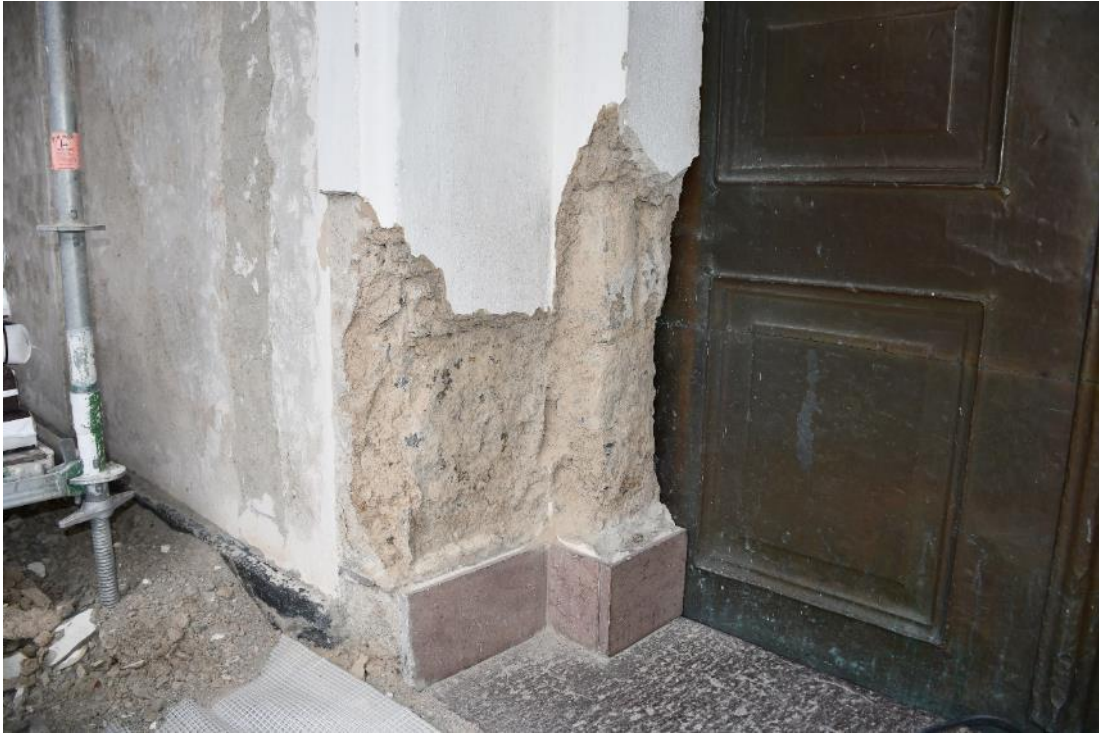
Figur 44 Nedtill på båda sidor om entrén kom putsen att knackas ner till stommen.
