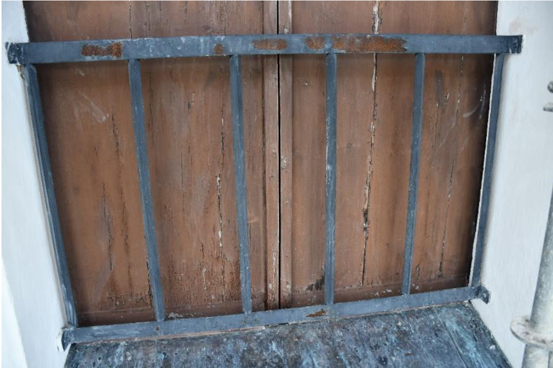
Figur 48 Framför ljudluckorna sitter räcken. Rostfläckar förekom.
