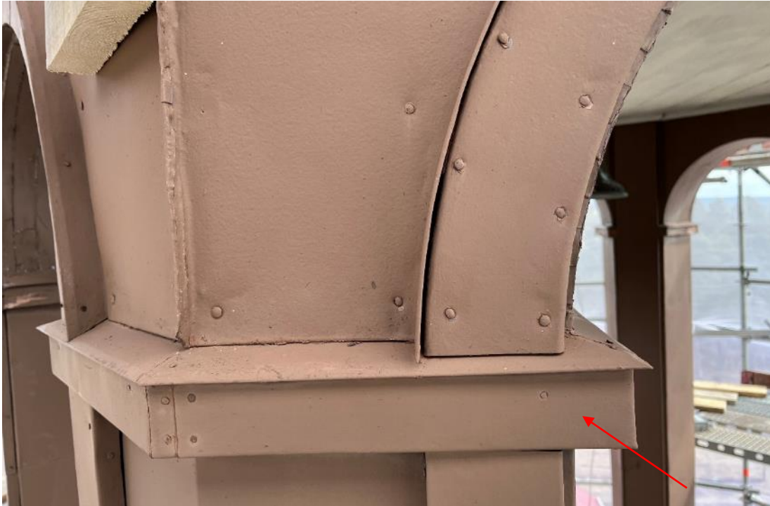
Figur 14 Detalj av plåtbeklädnaden före åtgärd. Notera den horisontella listen nedanför rundningen på öppningarna.
