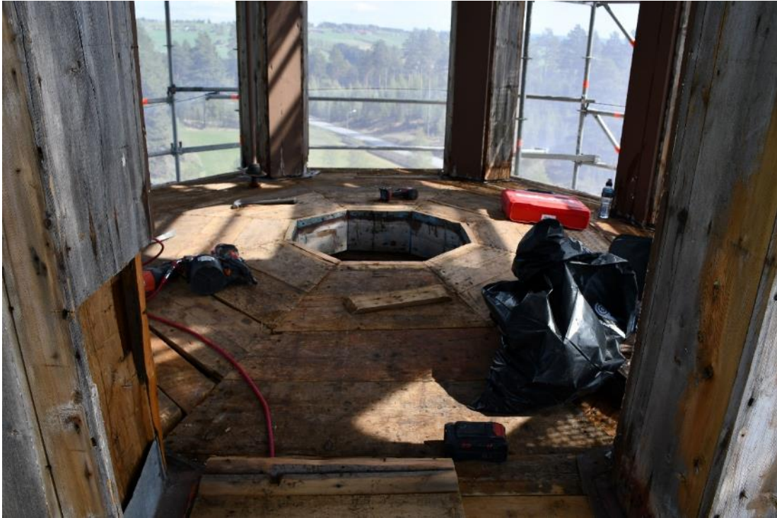
Figur 20 Lanterninens golv sedan plåten tagits bort.
