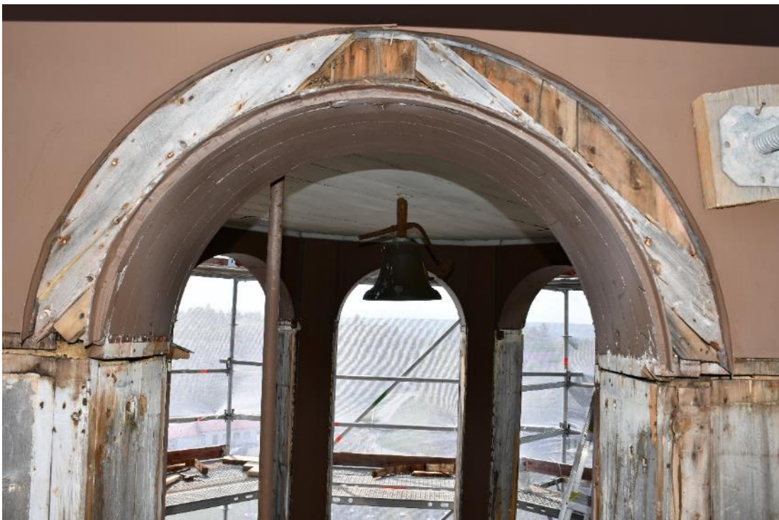
Figur 23 Trälisterna kring öppningarnas rundning var i dåligt skick.
