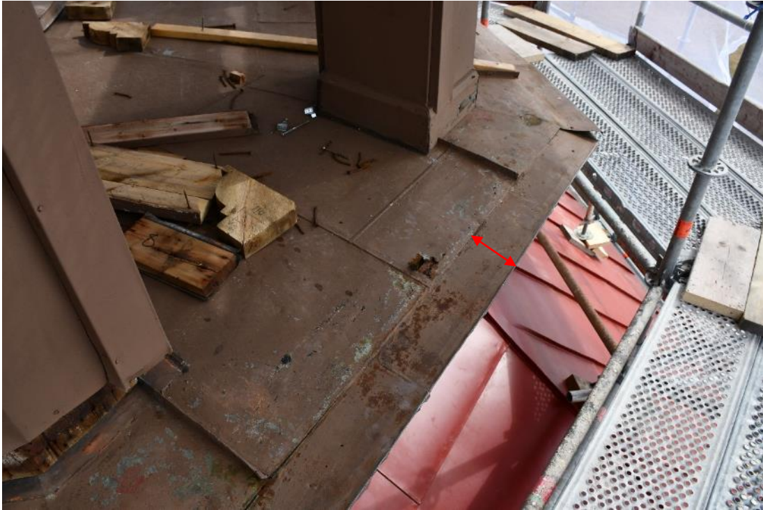
Figur 10 Den yttersta delen av lanterninens golv hade byggts ut ca 13 cm (skarv i plåttäckningen).
