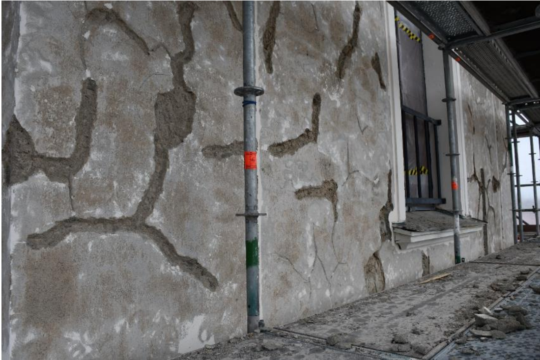
Figur 40 Det förekom rikligt med lagningar som framträdde efter blästringen, vissa mörkt grå med hårt bruk andra ljusare mer porösa som slingrade sig fram över fasaden.
