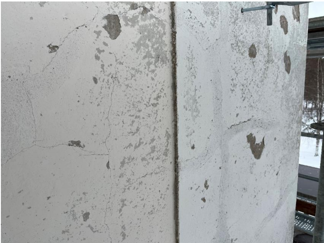
Figur 39 Avfärgningen på tornet hade delvis släppt. Sprickor och putsbortfall förekom över hela fasaden.
