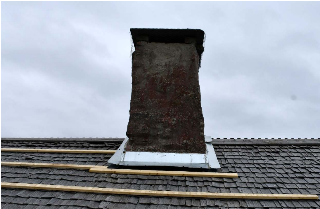
Figur 11 Skorsten med beslag före åtgärd. Bilden tagen efter att plåttaket plockats ned.
