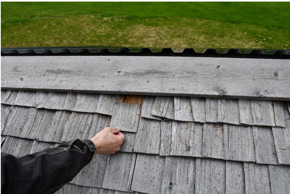
Figur 5 Nockbrädan glipade och den översta spånraden tog slut en bit nedanför nock.
