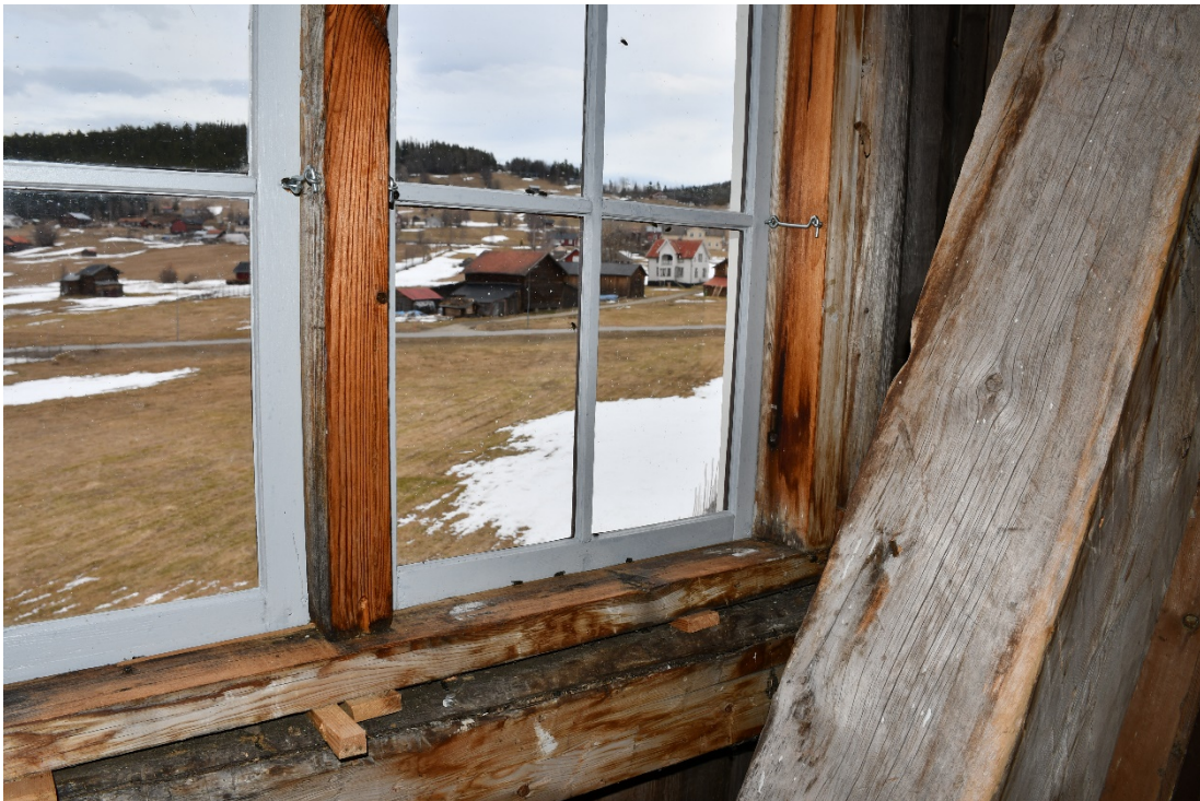
Figur 19 Tornfönster efter åtgärd. Notera hasparna som håller fönstret på plats.
