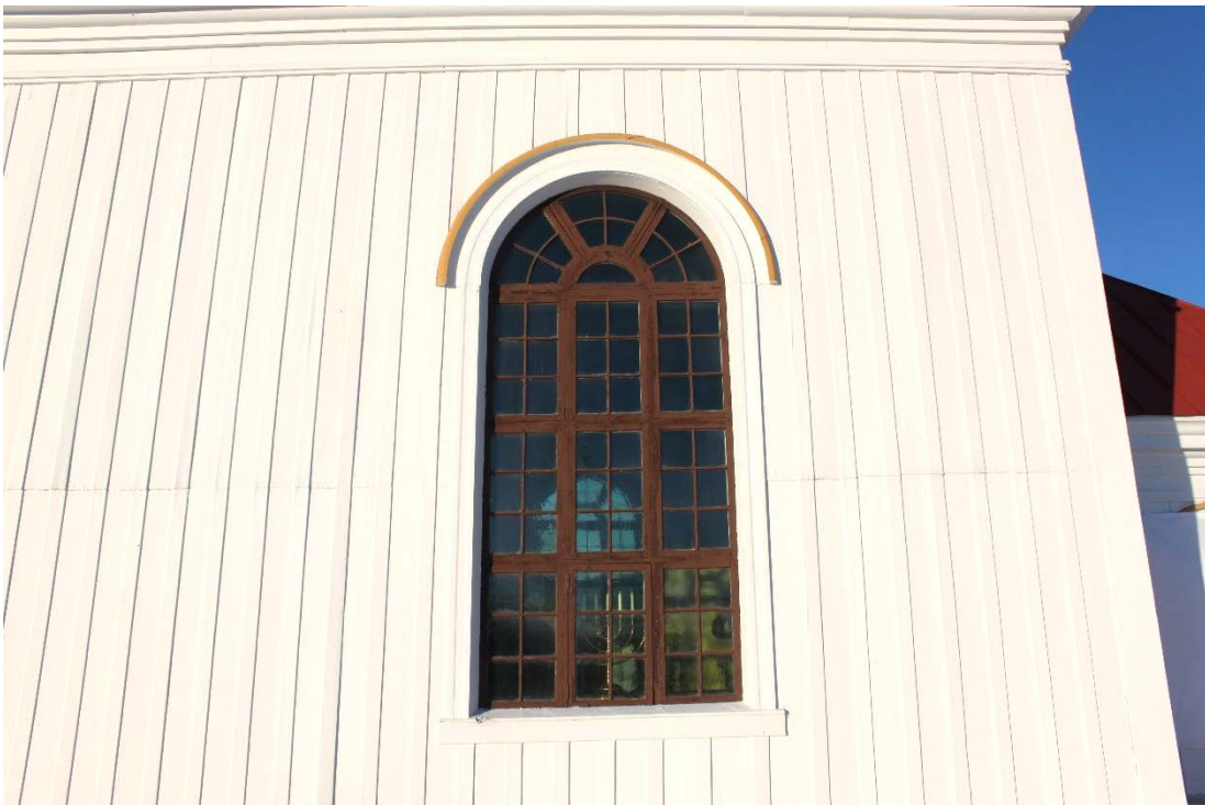
Figur 3 Fönster nr 3 på södra långhusväggen före åtgärd.
