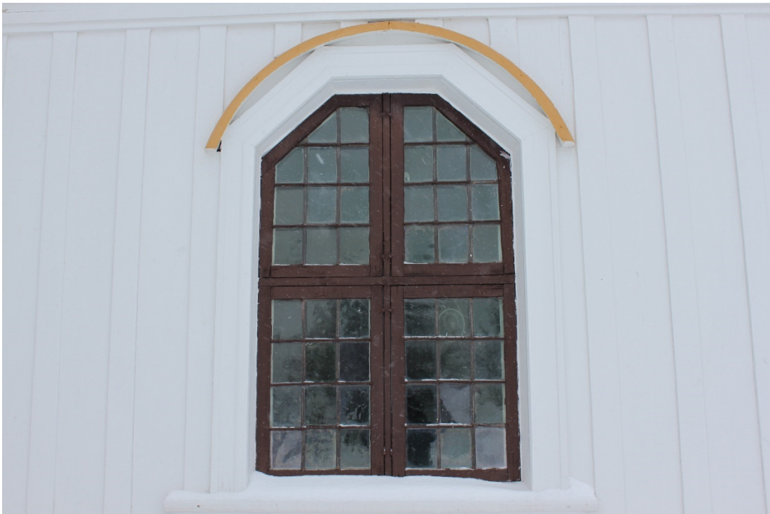
Figur 13 Fönster på sakristian före åtgärd.
