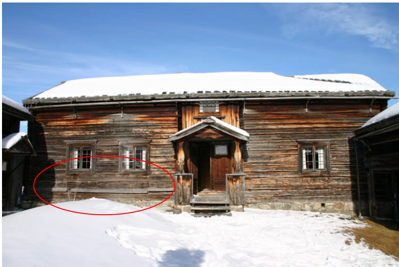
Boningshus I. På A-väggen är timret i dåligt skick till vänster om entrén, d.v.s i den södra delen av byggnaden, under och mellan fönstren.
