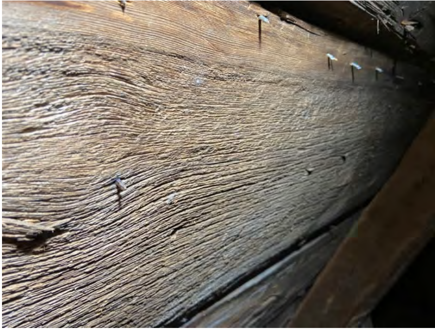
Fig. 117. Närbild på samma sida av samma planka, partiet mellan T5 och T6. Den ovittrade randen utgör spår av att plankans kant har gått in i en not i en från början stående väggplanka intill. Spikar inslagna 2022.
