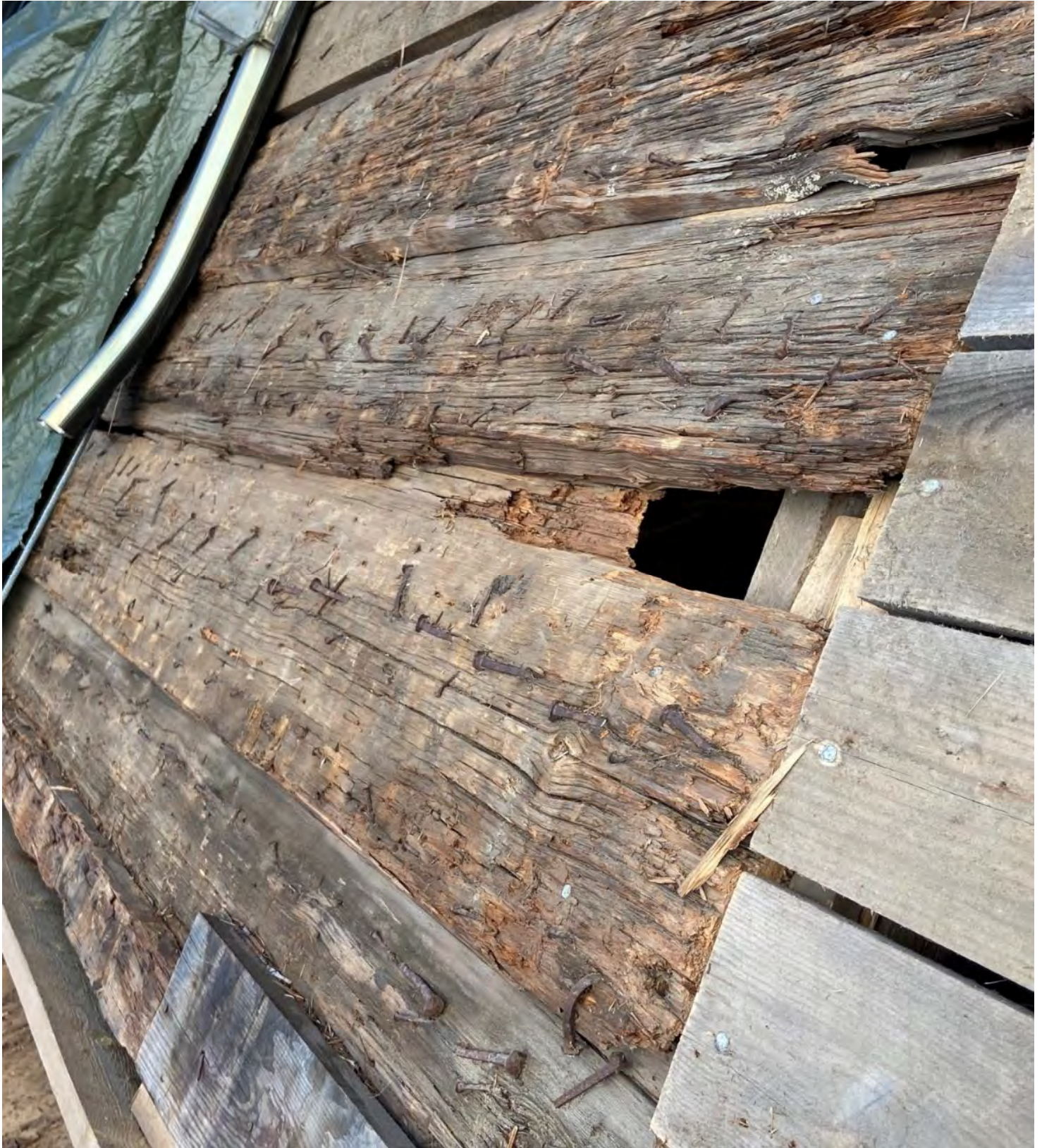
Fig. 92. Brädorna S1–S4 Ö–T7. De har lagts omlott även i återvänt skick, ungefär som de bör ha suttit från början. Brädan S2 är ca 32 cm bred och ca 4,5 cm som tjockast, mitt på. Rötskadorna torde i hög grad ha förvärrats under perioden 1864–1922, då stenkyrkan inte längre var i bruk och då taket inte underhölls. Jfr med nästa figur. Foton fig. 92–97 när inte annat anges: OH.
