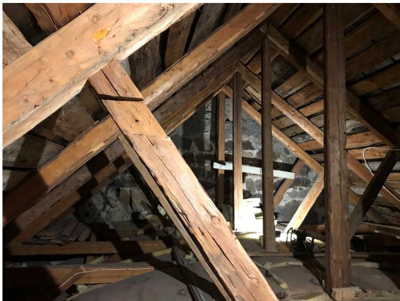
Fig. 137. Bjälke nr 1 (södra snedsträvan mellan hanbjälke och högben i takstol 5 från väster) i Myssjö kyrka. Foto (liksom bilderna i det följande): OH.
