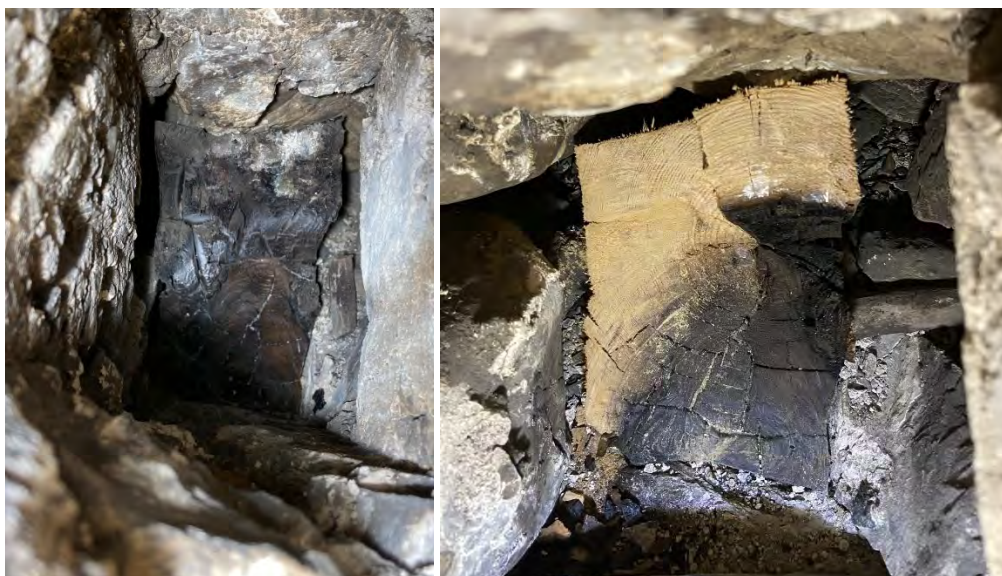
Fig. 39 a–b. Kvarsittande bränd stump av en ursprunglig sparre i hål nr 1 i norra långhusmuren i Frösö kyrka före och efter provtagning. Flera bitar utsågades. Innan den vänstra bilden togs hade vi slipat den djupast sittande ytan, för att bättre kunna se årsringarna. De yngsta årsringarna sitter i det nedre änstra hörnet, trots att kanten där är bortspjälkad (provnr i laboratoriet: 86372). Foton: OH.
