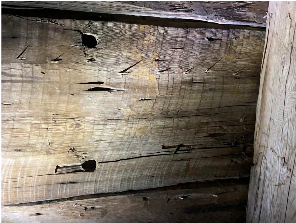
Fig. 88. Liknande spår som på föregående bild, här på undersidan av N4 T10–T11. Till höger om plugghålen blir brädan mer och mer väderbiten. Cirka 8 cm t.v. om plugghålens centrum ses en tryckskada, som bör ha uppstått där brädan har legat an mot den inre kanten av ett hammarband. Tjärstänk som runnit (i bildens mitt samt längst t.v.) visar att brädan har suttit stående. Foto: OH.
