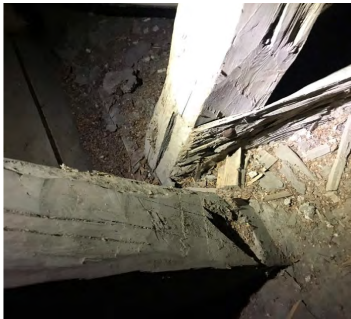
Fig. 149. Förbindelsen mellan stödbenet (upptill på bilden) och den horisontella stickbjälken ovanpå norra muren i en av takstolarna i Ragunda gamla kyrka. Stickbjälken måste rimligen ha kapats före sammanfogningen. Närmast i bild ses en av de sluttande ribbor som håller upp det invändiga tredingstaket. Änden på ribban går ned i ett urtag i det inmurade remstycket som blott anas på bilden, under allt skräp. Foto: OH.
