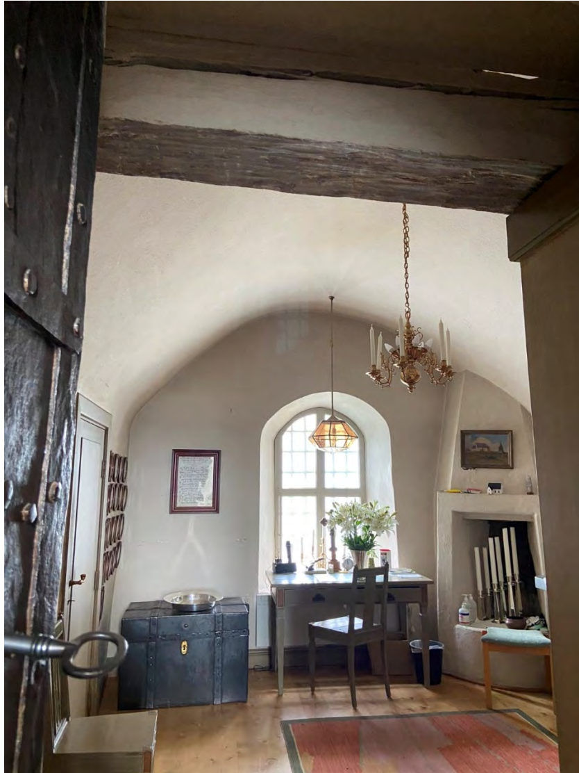
Fig. 51. Frösö kyrkas sakristia, försedd med ett brandsäkert stenvälv av samma slag som Hallens kyrkas sakristia hade fram till år 1776. Dendrodaterad, med viss osäkerhet, till 1506. Spisen är sekundär, liksom putsen i taket. Vid Nils Månsson Mandelgrens besök 1869 syntes ännu avtrycket av en valvform av brädor i taket (Mandelgrenska saml., ser. 4, LUF). Foto: OH.
