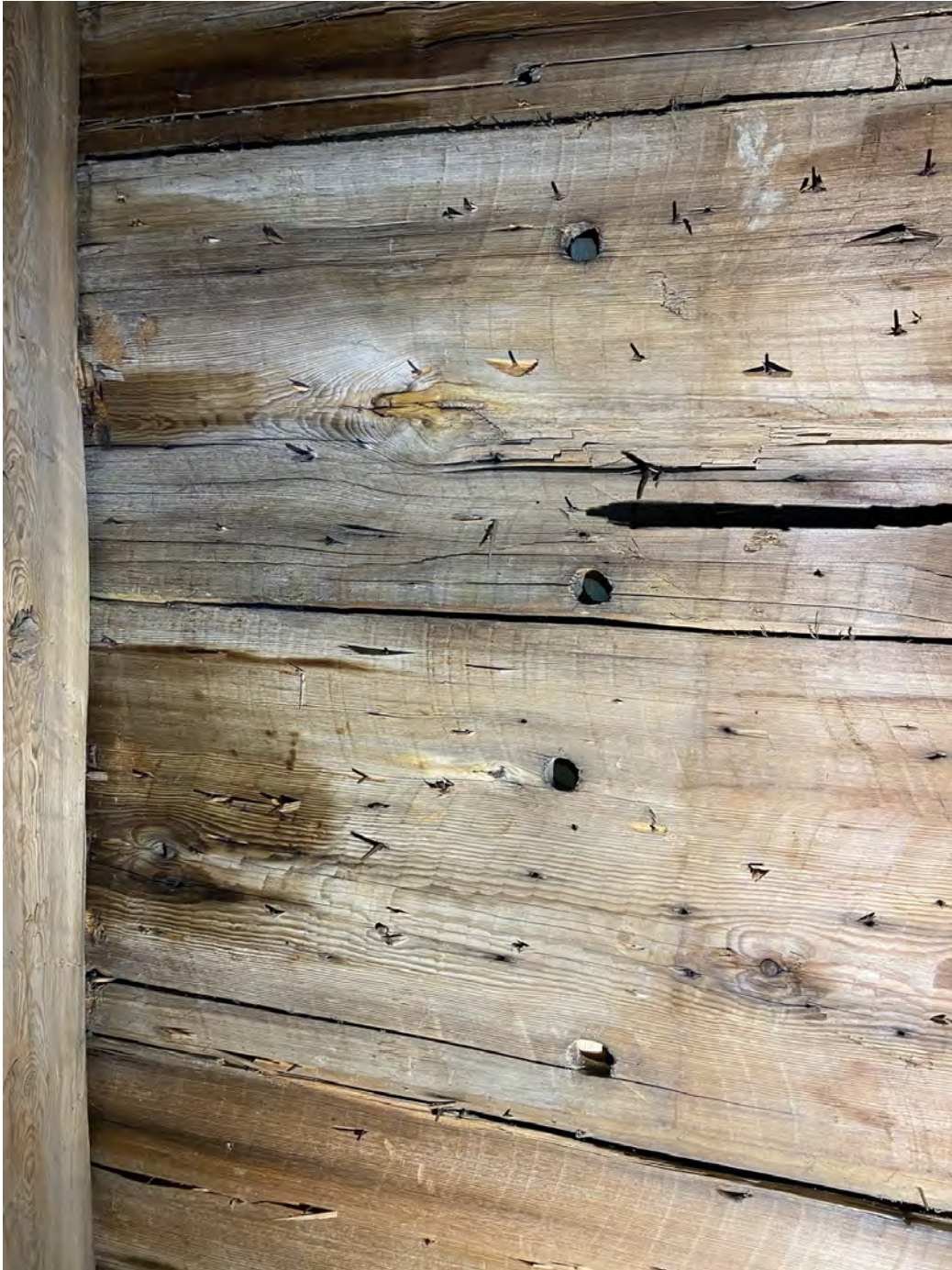
Fig. 87. Undersidorna av brädorna N4–N5 Ö–T4 intill takstol 4 (jfr med fig. 68 ovan). Brädorna slutar med gamla, fasade snitt ovanpå denna takstol. Notera tryckskadorna som löper som en rand tvärs över vardera brädan några centimeter t.h. om pluggålen samt brädornas vittring, som börjar ungefär vid pluggålen och blir mer och mer påtaglig mot ändarna. Dessa spår tyder på att detta ursprungligen är brädornas nedre ändar. De har vilat mot och varit fästa i ett hammarband och vittringen har uppstått i taksprånget. Foto: OH.
