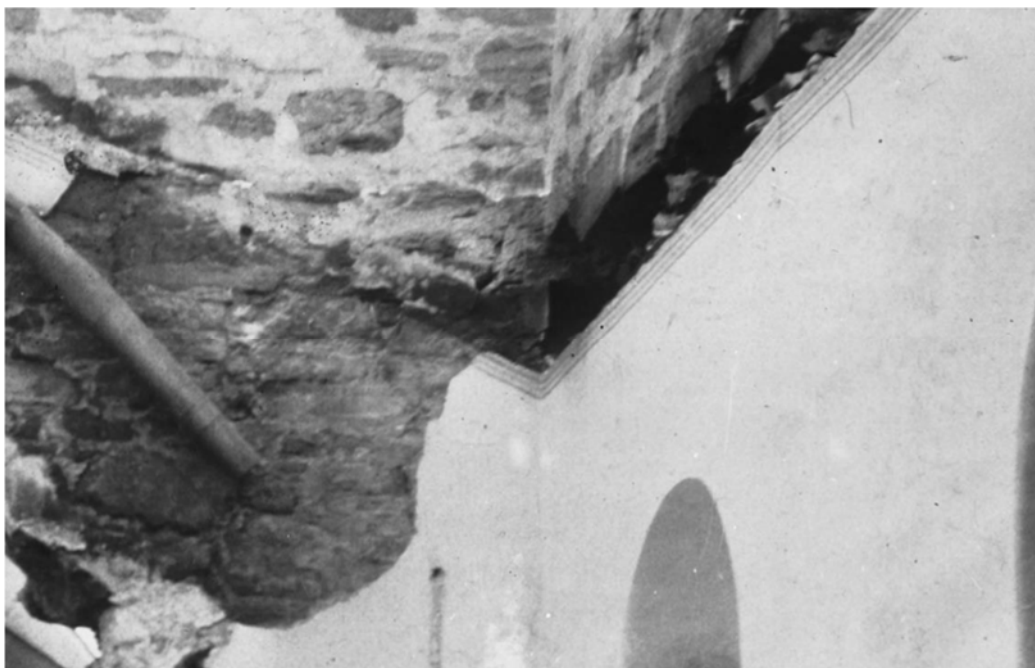
Fig. 27. Parti av murverket i långhusets sydöstra hörn efter branden 1898. Ovanför den vita putsen på sydturen ses en håligheter efter ett helt eller delvis uppbrunnet inre remstycke. Detalj av fig. 16.
