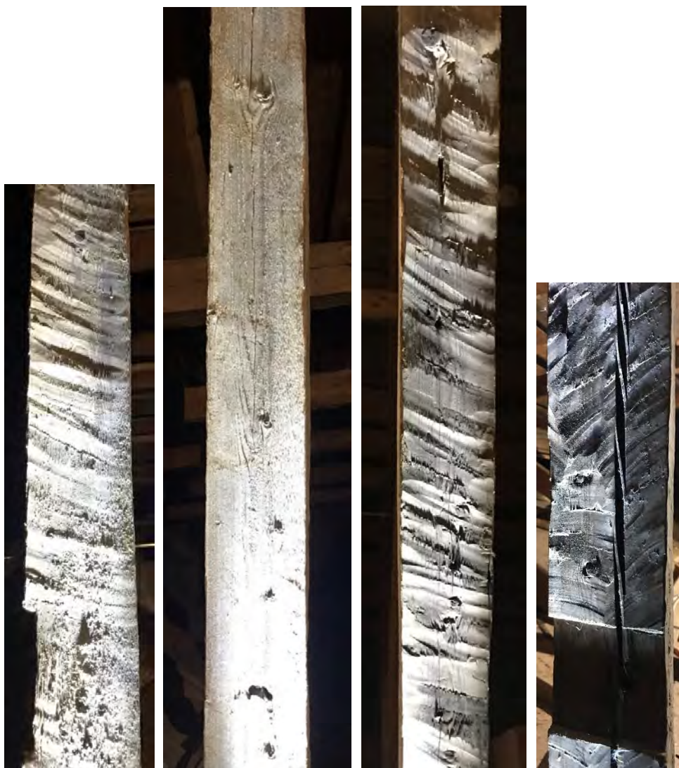
Fig. 140 a–d. Bjälke nr 6 (södra snedsträvan i takstol 10) i Myssjö kyrka från fyra håll. Tolkad som ett ursprungligt högben på utsidan av ett murat gavelröste enligt följande: a) undersida med spår av murbruk, b) utplanad och vittrad utsida, c) ovansida med många spikhål (fotograferad ovanför urtaget), d) insida med ett grunt urtag. Dimensioner: 10×9 cm.
