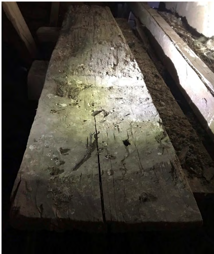
Fig. 153. Golvtiljans rötskadade undersida med ett långt urtag närmast i bild. Foton fig. 151–153: OH.
