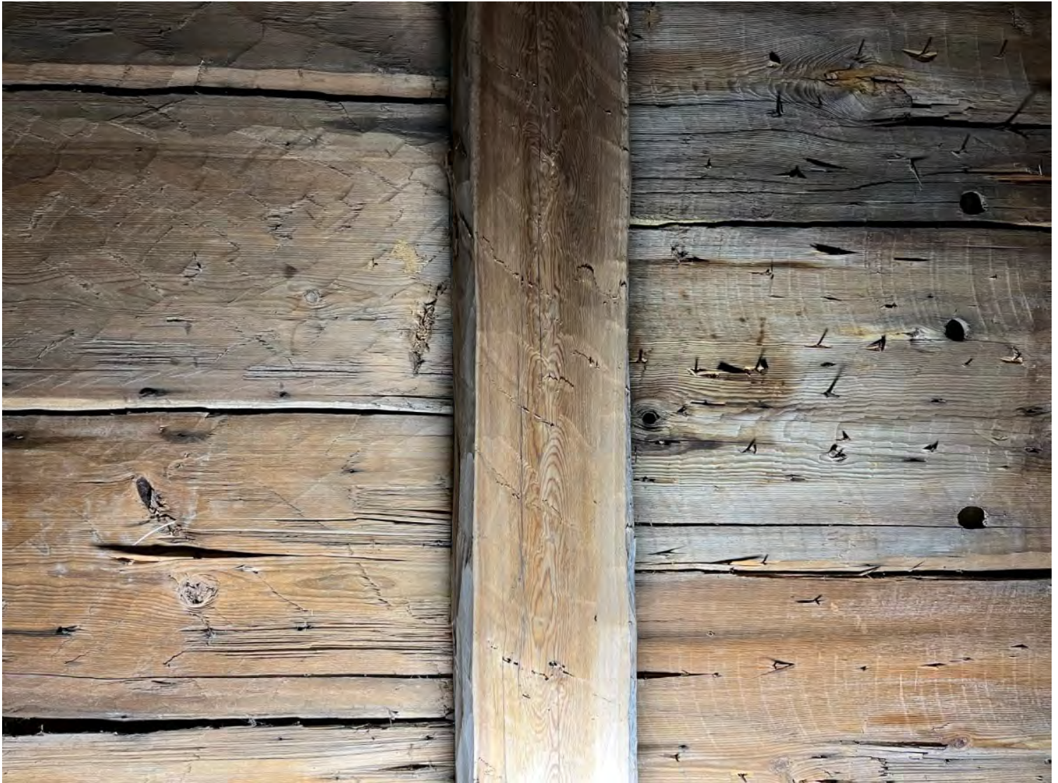
Fig. 68. Nya respektive återanvända undertaksbrädor i 1520-talets takkonstruktion i Marby gamla kyrka. De återanvända brädorna, till höger i bild, har tydliga sprättäljningsspår på undersidorna och plugghål (N3–N5 Ö–T4). Den översta och den mittersta av de återanvända brädorna är väderbitna närmast änden, vilket tyder på att de har suttit stående och skjutit ut i ett taksprång längst ned (för närbild se fig. 87). Den mittersta mäter tvärs över ca 39 cm. Foton fig. 68–76, när inte annat anges: OH.
