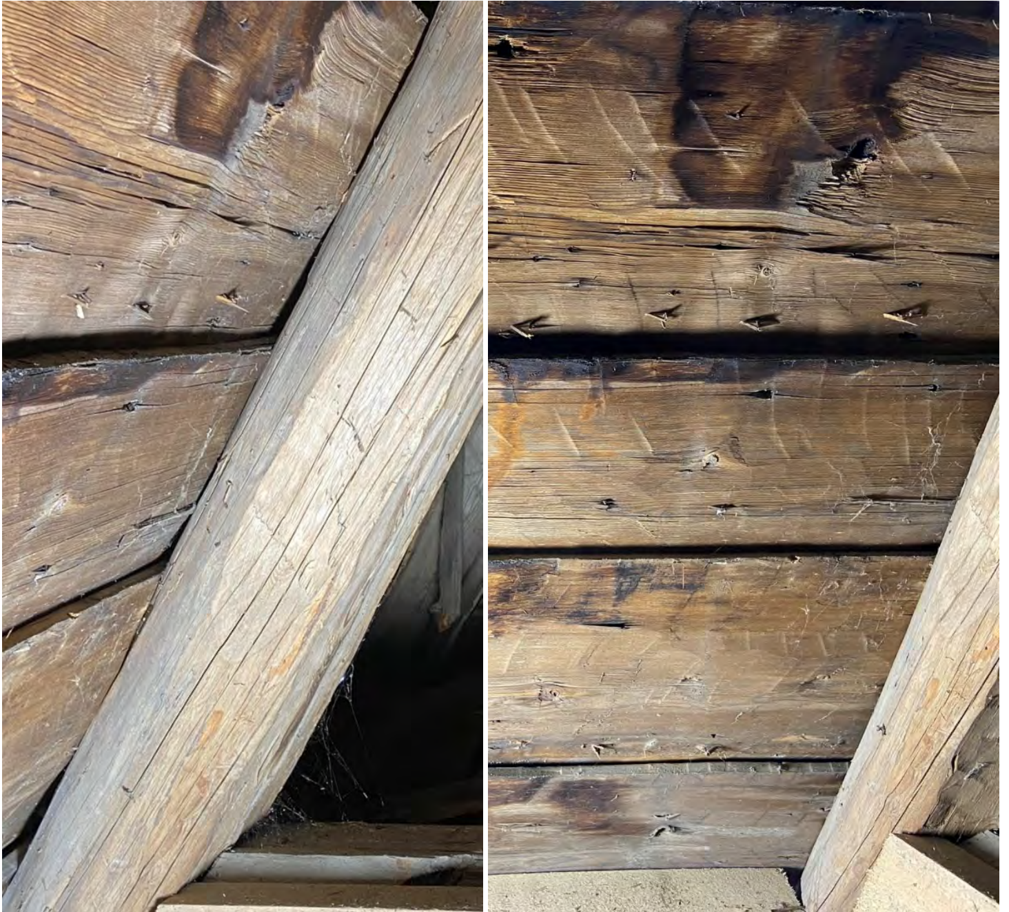
Fig. 93 a–b. Samma brädors undersidor, sedda från kyrkvinden. Brädorna är som tunnast i övre kanten (S2: ca 14 mm). En bit nedanför mitten höjer sig varje bräda från underlaget, så att nederkanten kan ligga omlott över nästa bräda nedanför. Utsidorna och de överlappade partierna har varit tjärade. Jfr med föregående figur.
