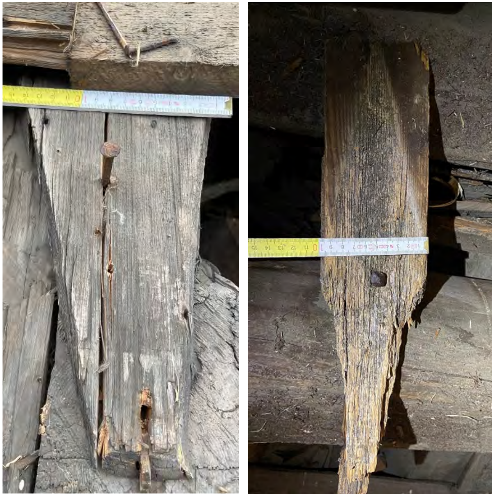
Fig. 67 a–b. T.v.: Välbevarat stavspån av okänd ålder återanvänt som salning längst ned på den utbytta takstolen nr 12, i söder. Här blottat under 2022 års takrenovering. – T.h.: Kraftigt vittrat stavspån, kasserat 1922, nu liggande bland skräpet på södra murkrönet. Spånets har en bevarad, smidd spik med fasetterat huvud. Foton: OH.
