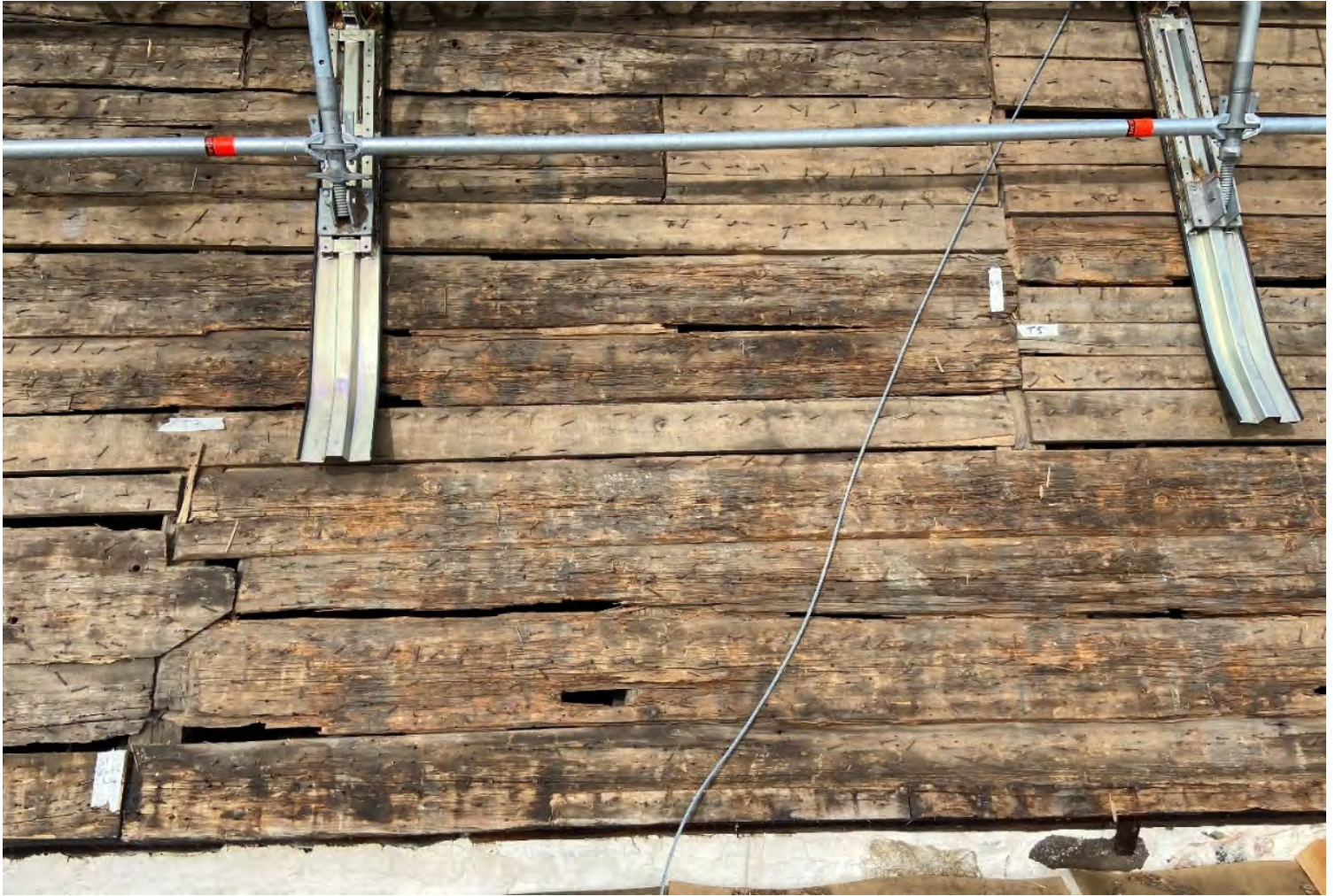
Fig. 65. Ett parti av södra takfallet. Tejpbitarna är placerade vid takstolarna nr 7 (t.v. i bild) respektive nr 5 (t.h.). Brädor av olika slag bildar här ett lappverk. Flertalet av de äldre brädorna på bilden är återanvända yttertaksbrädor med buktande ovansidor, i olika längder (t.ex. S1–S4 från takstol 7 österut, S2 från takstol 7 västerut och S6–S7 från takstol 5 västerut). Här ses också en återanvänd, plan undertaksbräda (S9 från takstol 6 västerut) samt en återanvänd väggplanka med bikonvext tvärsnitt (S3 från takstol 7 västerut). De två översta brädorna mellan takstol 5 och 7 kan bedömas vara från stenkyrkans byggnadstid. Alla ljusa brädor på bilden samt S1 från takstol 7 västerut är ditsatta i samband med 1922 års takrenovering, som ersättningsvirke för rötskadade brädor eller brädbitar. Foto: OH.
