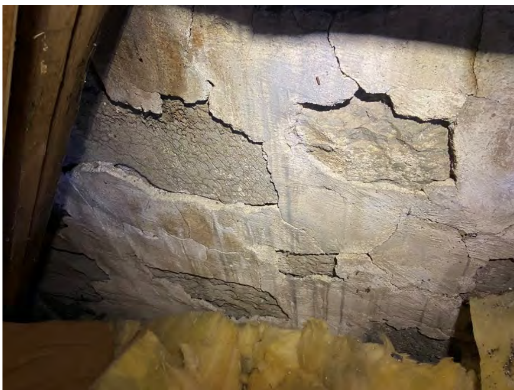
Fig. 19. Medeltida puts på utsidan av korets norra mur i Frösö kyrka, bevarad och synlig från sakristians vind. Brottytorna tyder på att detta putslager en gång har varit heltäckande. Foto: OH.
