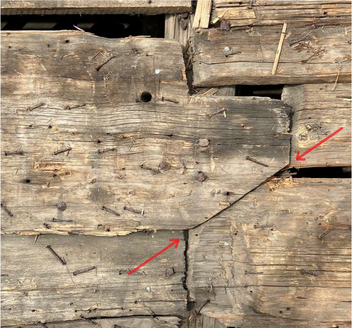
Fig. 122. Mötet mellan f.d. väggplankan S3 T7–T8 (t.v. i bild) och de närmare 9 m långa f.d. yttertaksbrädorna S2–S4 Ö–T7 (t.h.). Det från nedre kanten på plankan utgående snittet, mellan de röda pilmarkeringarna, har en jämn yta och är av allt att döma ursprungligt. Dess vinkel mot längdriktningen på plankan har uppmätts till mellan 32 och 33 grader. Den mötande brädan S2 har tillpassats i änden på 1520-talet. De övriga, grovt huggna kapningarna av S3-plankans östra ände är tydligen gjorda vid monteringen på 1520-talet, för att möta brädorna S3 resp. S4 Ö–T7. Brädan S3 Ö–T7, som är lite kortare än S2 och S4 Ö–T7, har vid monteringen haft en kant nedtill som överlappat och fått stöd av brädan nedanför. Den kanten är nu bortspräckt närmast änden till följd av rötskador – därav gluggen som ses mellan dessa brädor till höger i bild. Foto: OH.
