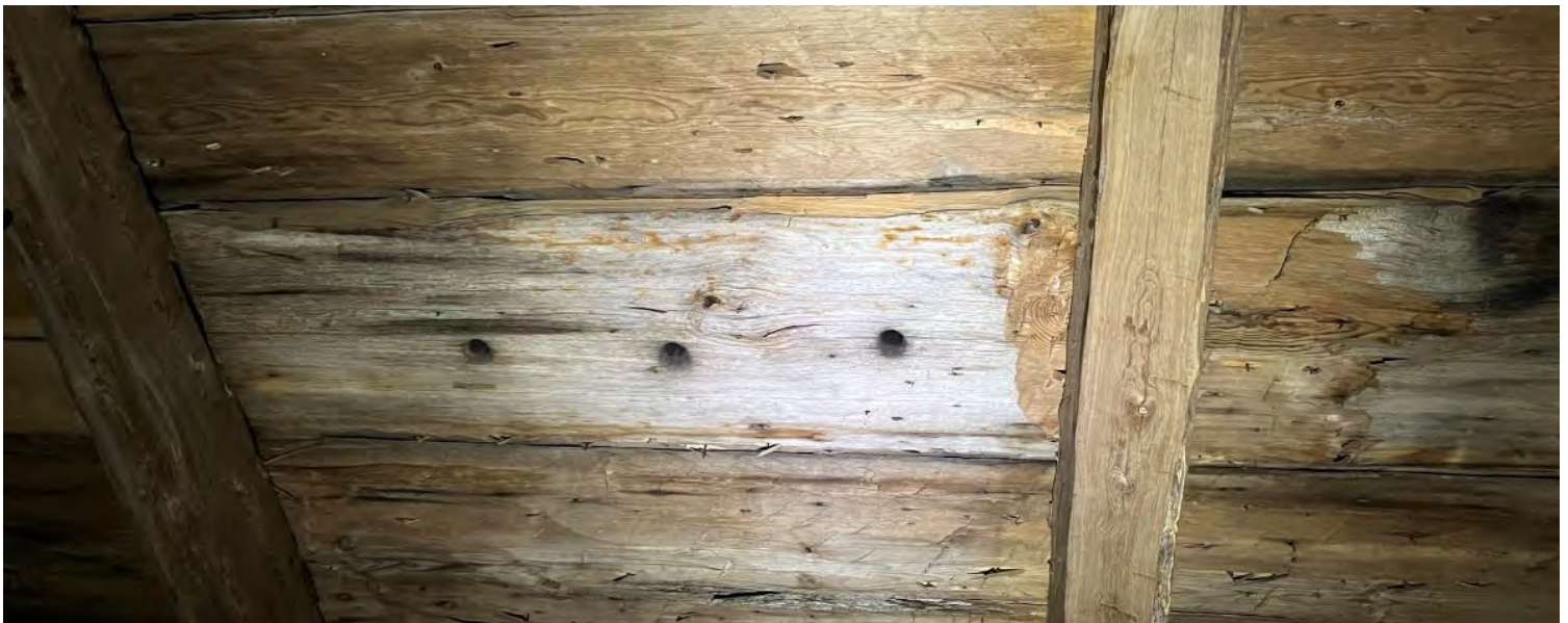
Fig. 121. Plankan S24 T8–T10, nedbilad i mitten för att kunna monteras på högbenen i 1520-talets takkonstruktion. Det nedbilade partiets yta har antagit samma mörka, bruna färg som 1520-talsbrädorna intill, vilket visar att det inte rör sig om en åtgärd i modern tid. De tre synliga borrhålen samt ett fjärde, likadant hål, gömt bakom högbenet t.h. i bild, har vittrade insidor och utgör möjligen gamla ljusgluggar (diam.: 21 mm). Foto: OH.
