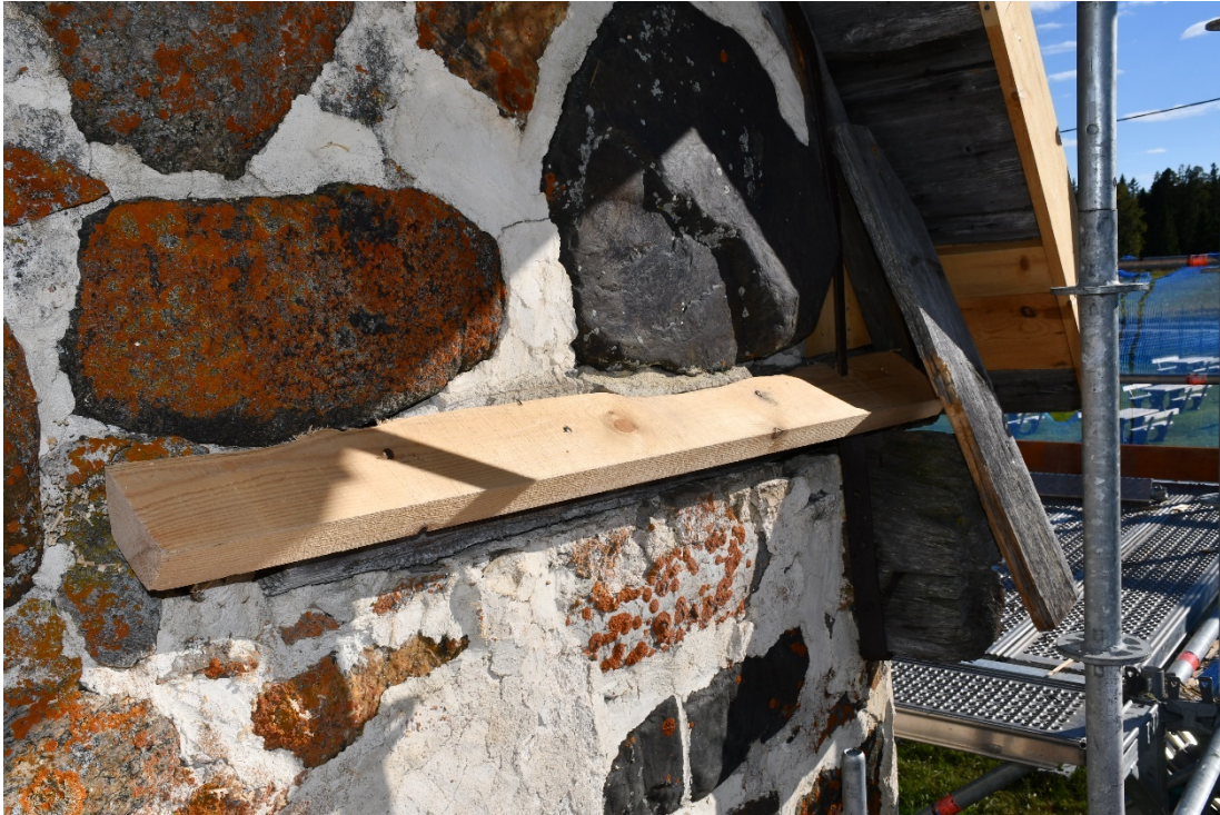
Figur 15 Den spruckna täckbrädan över "hammarbandet" ersattes med en ny. På bilden har även täckbrädan över hammarbandets ändträ satts tillbaka.
