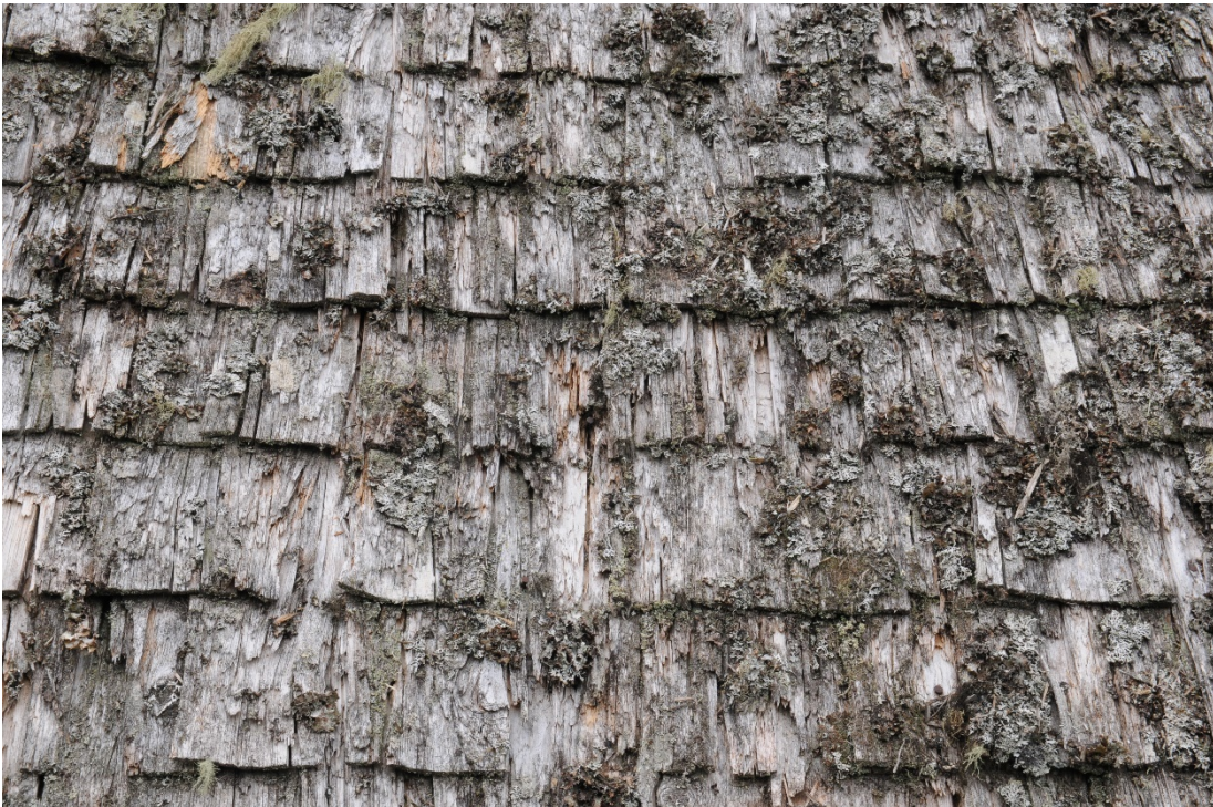
Figur 4 Stickspåntaket var före åtgärd söndervittrat och mossbeväxt.
