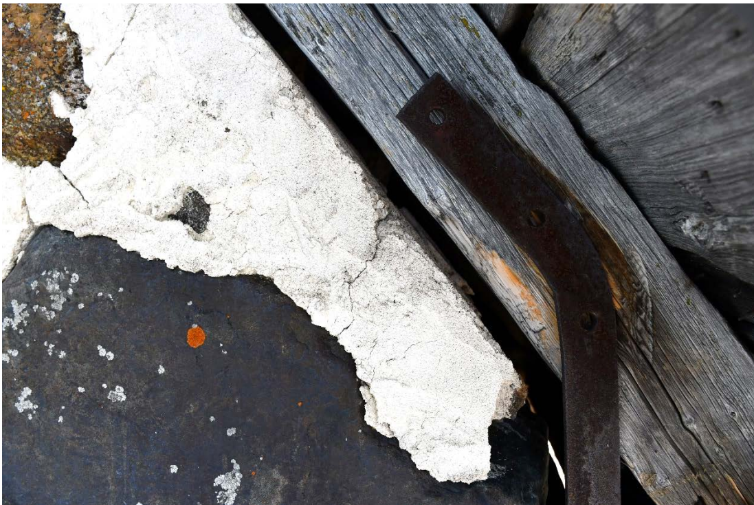
Figur 16 Högenet på murkrönet, närmast det sydvästra hörnet hade kommit ur läge och glidit neråt.
