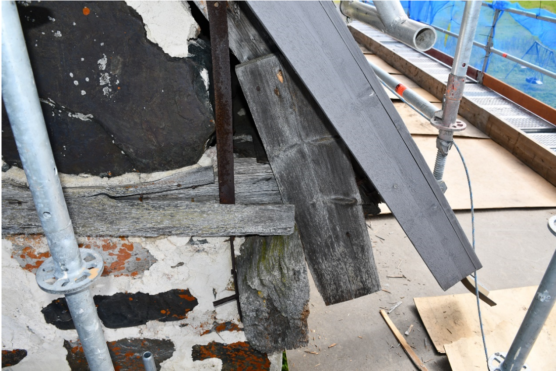
Figur 13 I sydvästra hörnet var täckbrädan över "hammarbandet" sprucken. I samma hörn fanns ett hål i muren, närmast hörnet.
