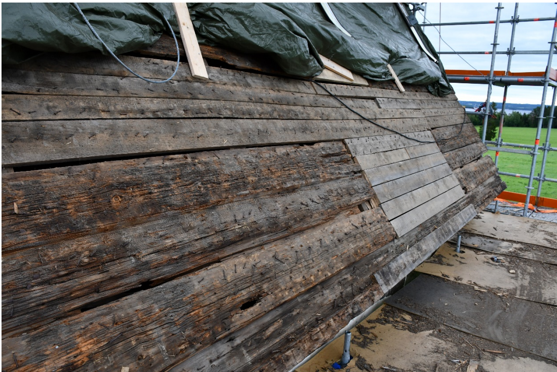
Figur 6 Delar av takfallen har nyare rote (1920-tal och 1980-tal).
