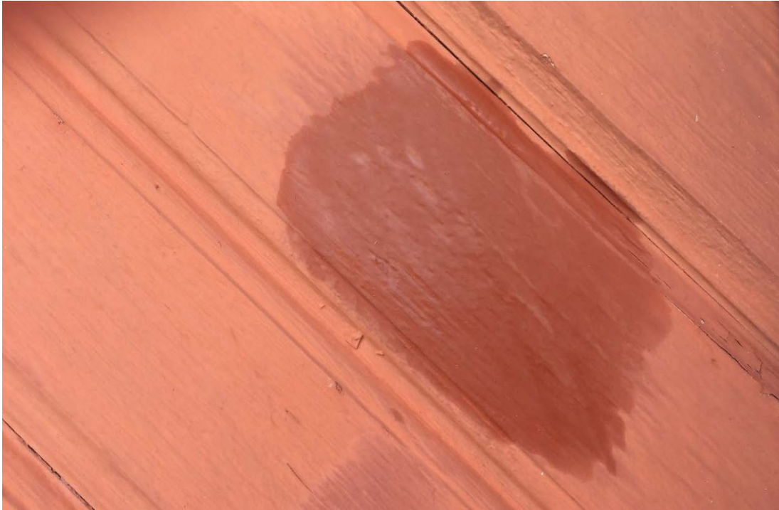
Figur 25 Färgen på dörrarna var kraftigt blekt och har från början haft en mörkare röd ton.
