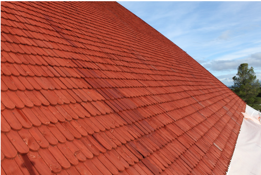
Figur 30 Takfall mot söder efter åtgärd. Notera de mörka fläckarna på takytan.
