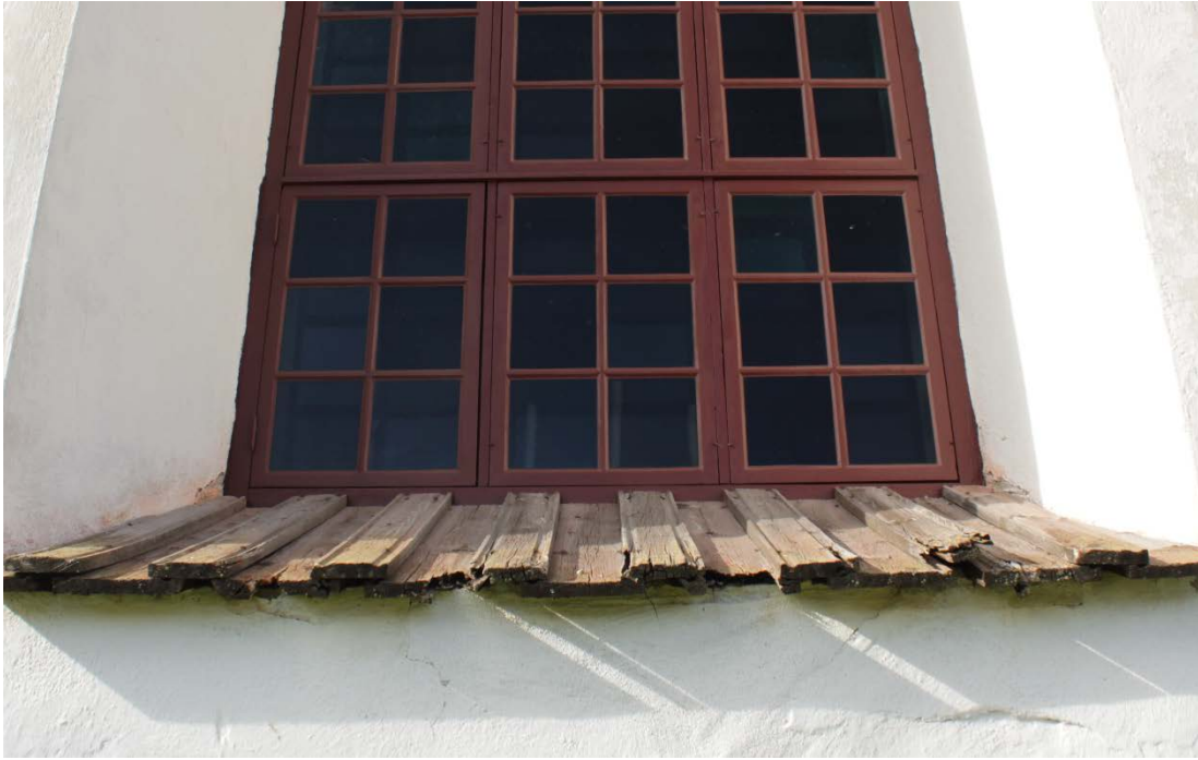
Figur 17 Solbänk före åtgärd.
