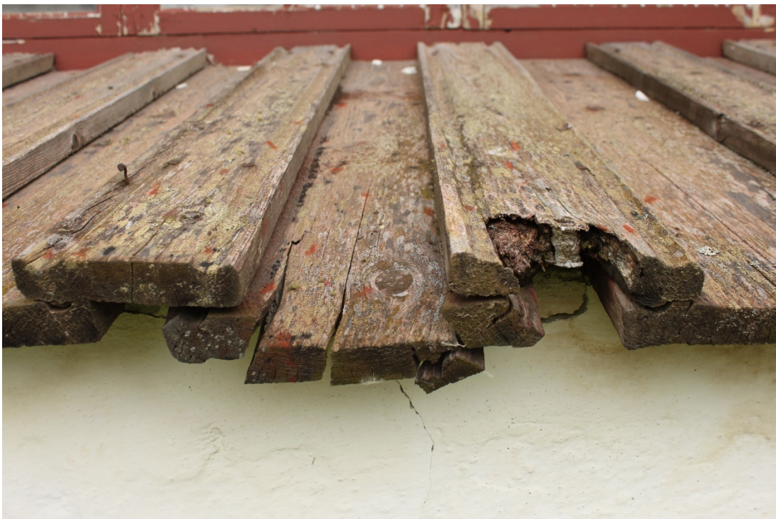
Figur 18 Solbänkarna var i väldigt dåligt skick. Omfattande rötskador och torksprickor förekom.
