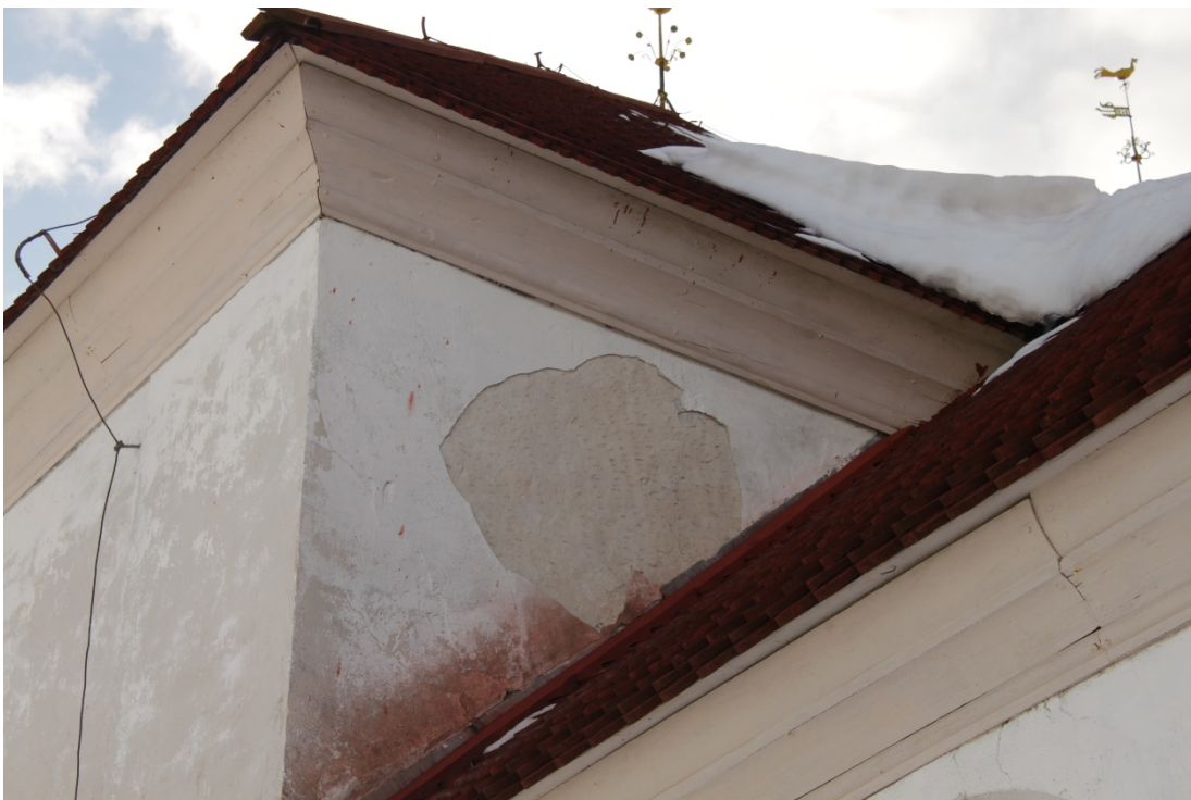
Figur 6 Putsskada i mötet mellan långhus och sakristia. Notera gamla huggmärken på ytan där putsen ramlat bort, ett sätt att få ovanliggande putslager att fästa.
