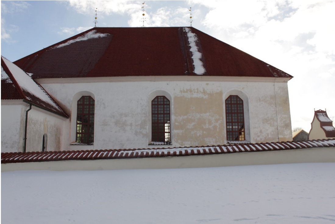
Figur 7 Norra fasaden före åtgärd.
