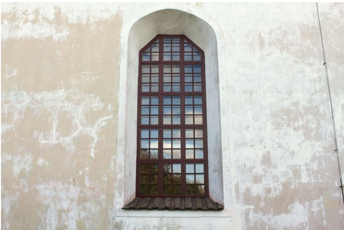
Figur 8 Del av norra fasaden före åtgärd.
