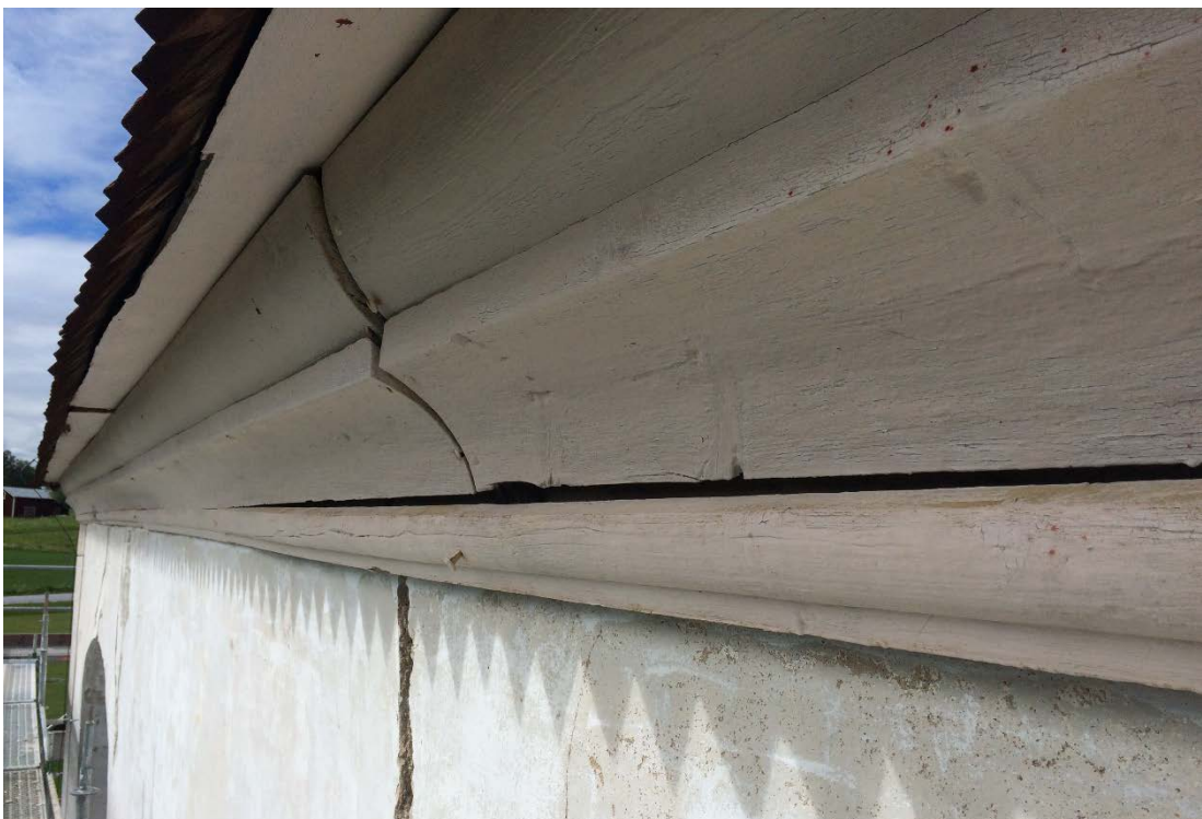
Figur 20 Taklist före åtgärd.
