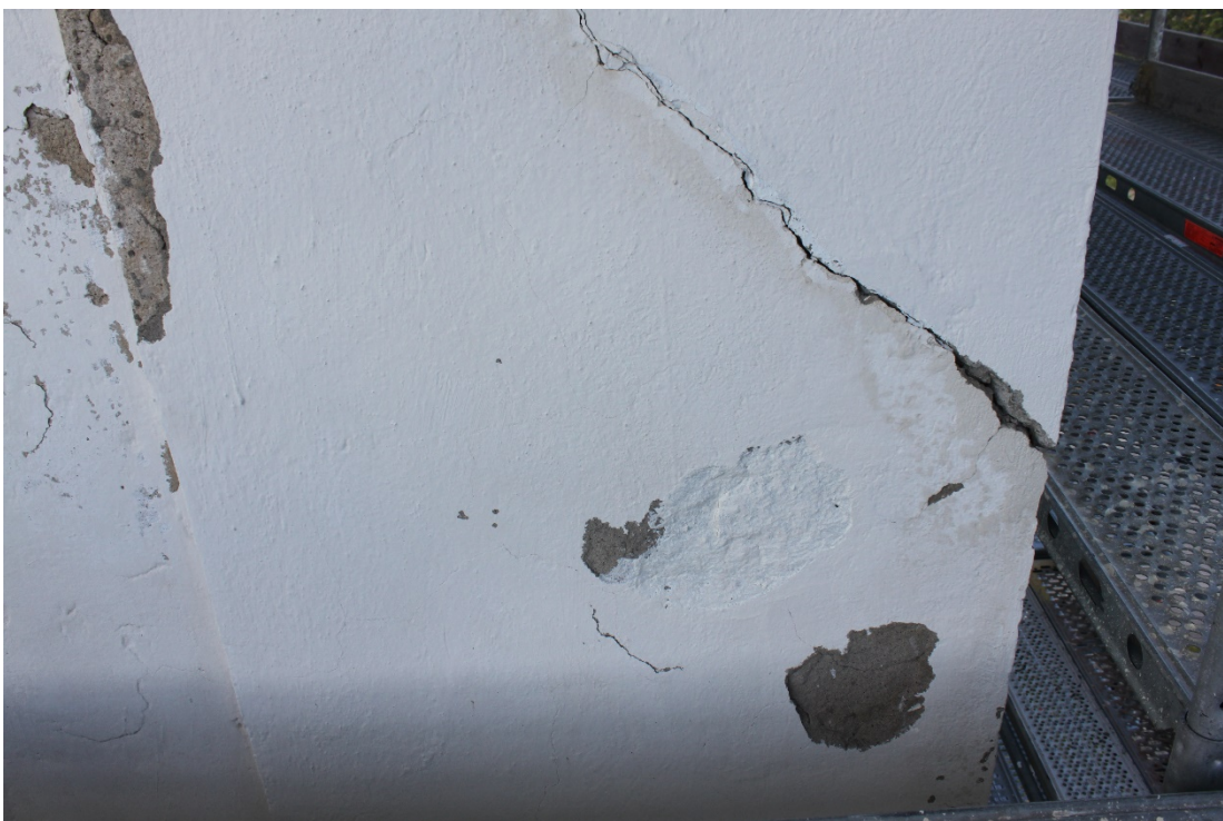
Figur 3 Gamla lagningar i nordöstra hörnet.
