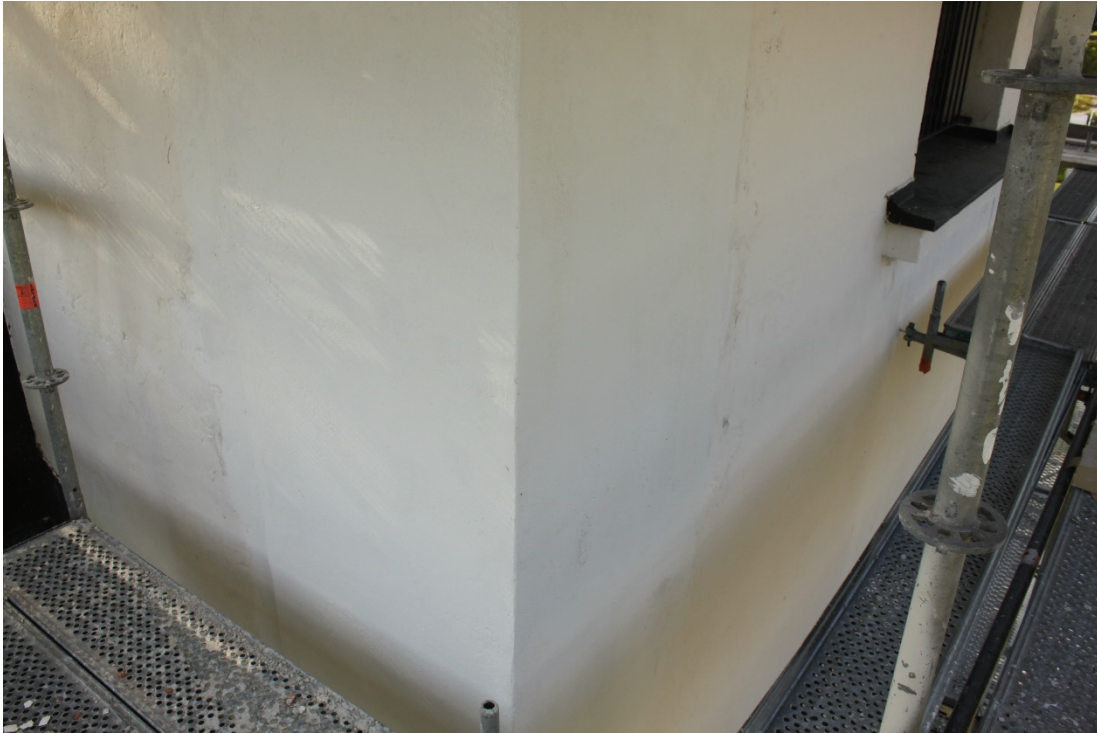
Figur 4 Nordvästra hörnet efter lagning.
