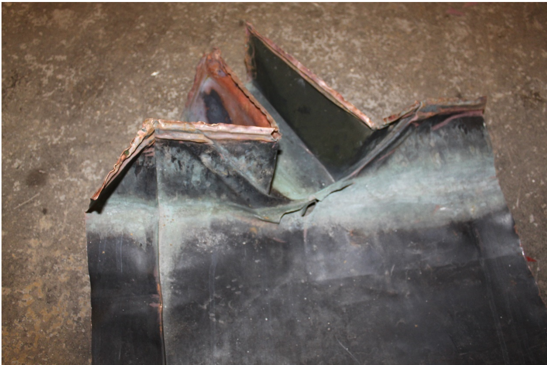
Figur 27 Takplåten var sprucken i anslutning till stuprören.
