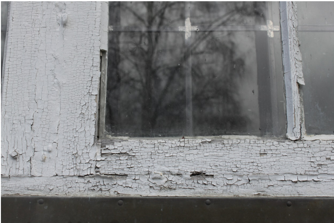
Figur 9 Färgen på fönstren flagade före åtgärd.
