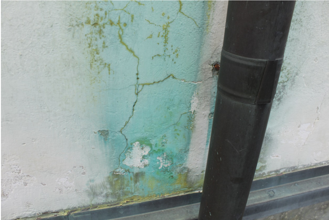
Figur 6 Missfärgningar av puts bakom stuprör på norra sidan.
