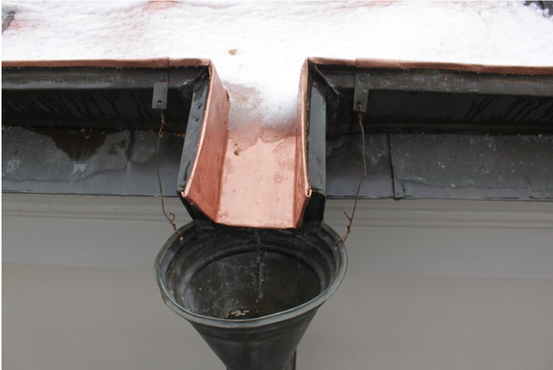
Figur 28 Plåten har förnyats i anslutning till stuprören.
