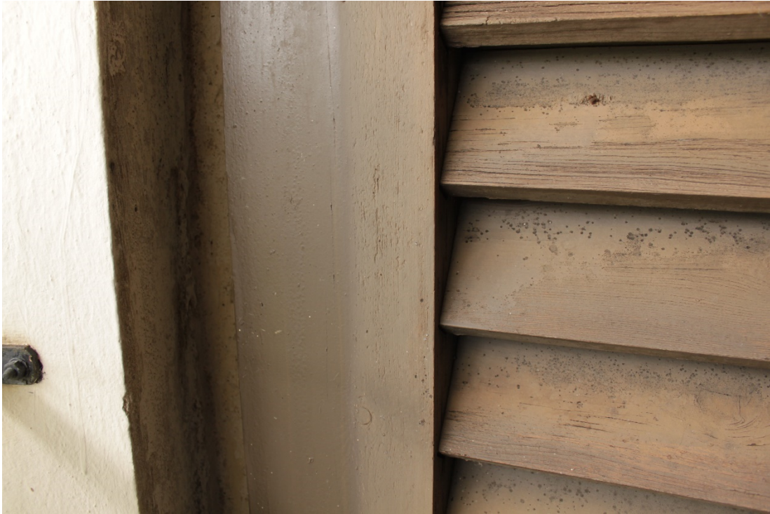
Figur 16 Ljudlucka före åtgärd.
