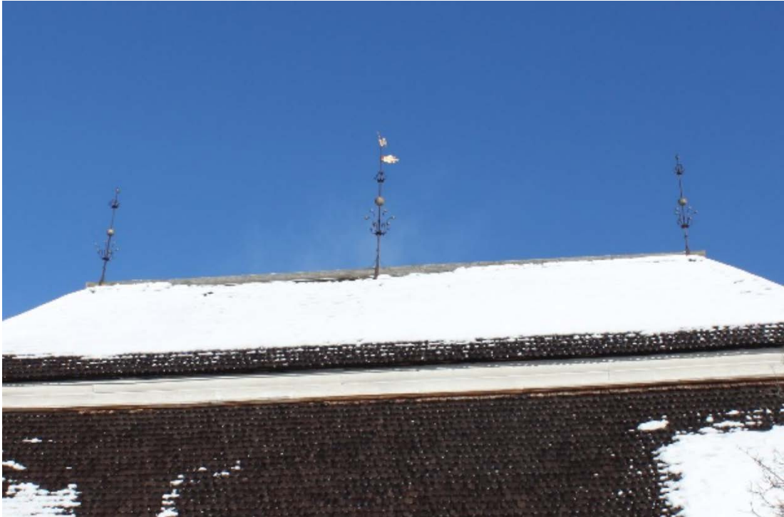
Figur 28 Spiror före åtgärd.
