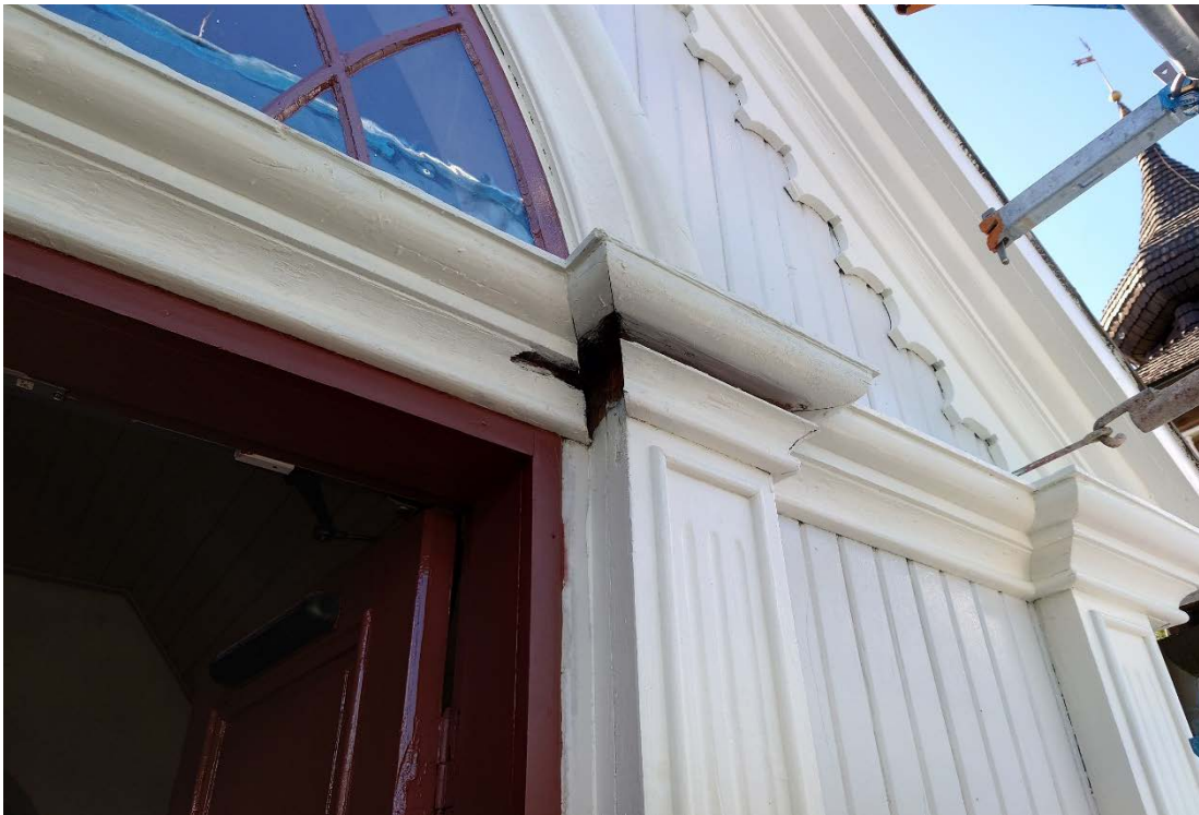
Figur 15 Rötskador förekom i listverket ovanför dörren. Foto: Lennart Carlsson.
