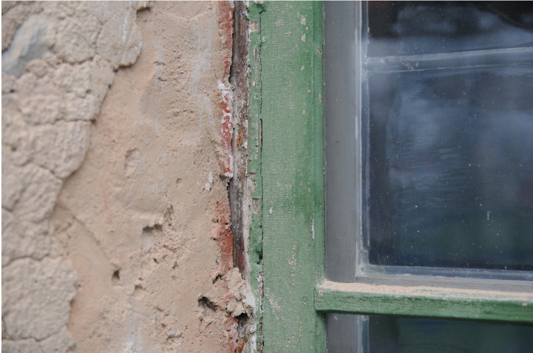
Figur 24 Färgen på fönstren var sliten med färgbortfall. Den gröna kulören var blekt (notera spåren av rödbrunt mellan karm och vägg).
