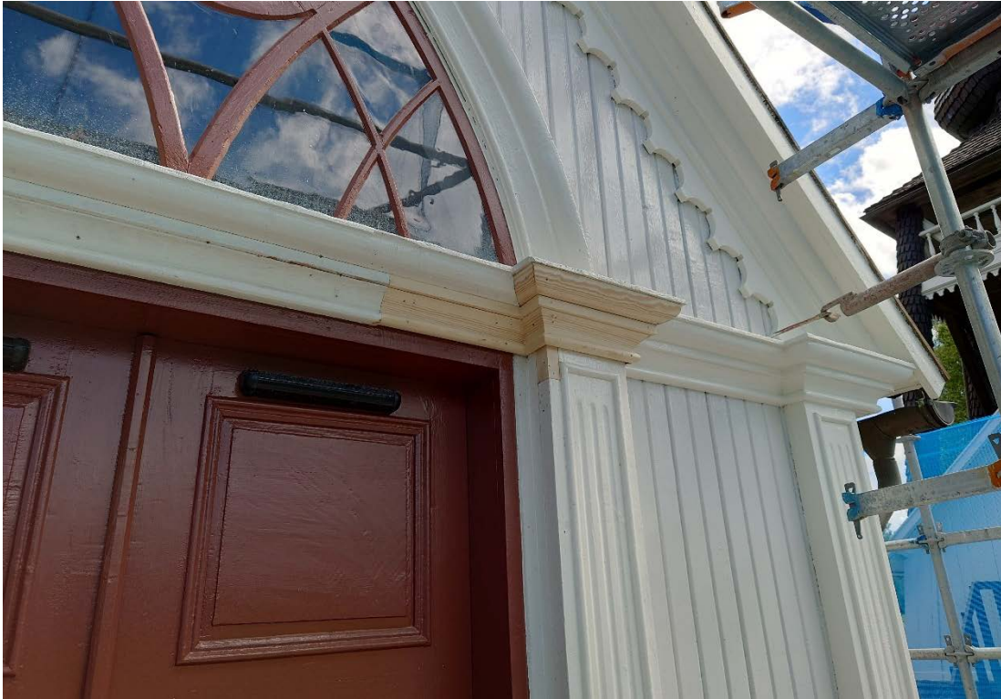
Figur 16 Trälagningar på listverk ovanför dörren. Foto: Lennart Carlsson.
