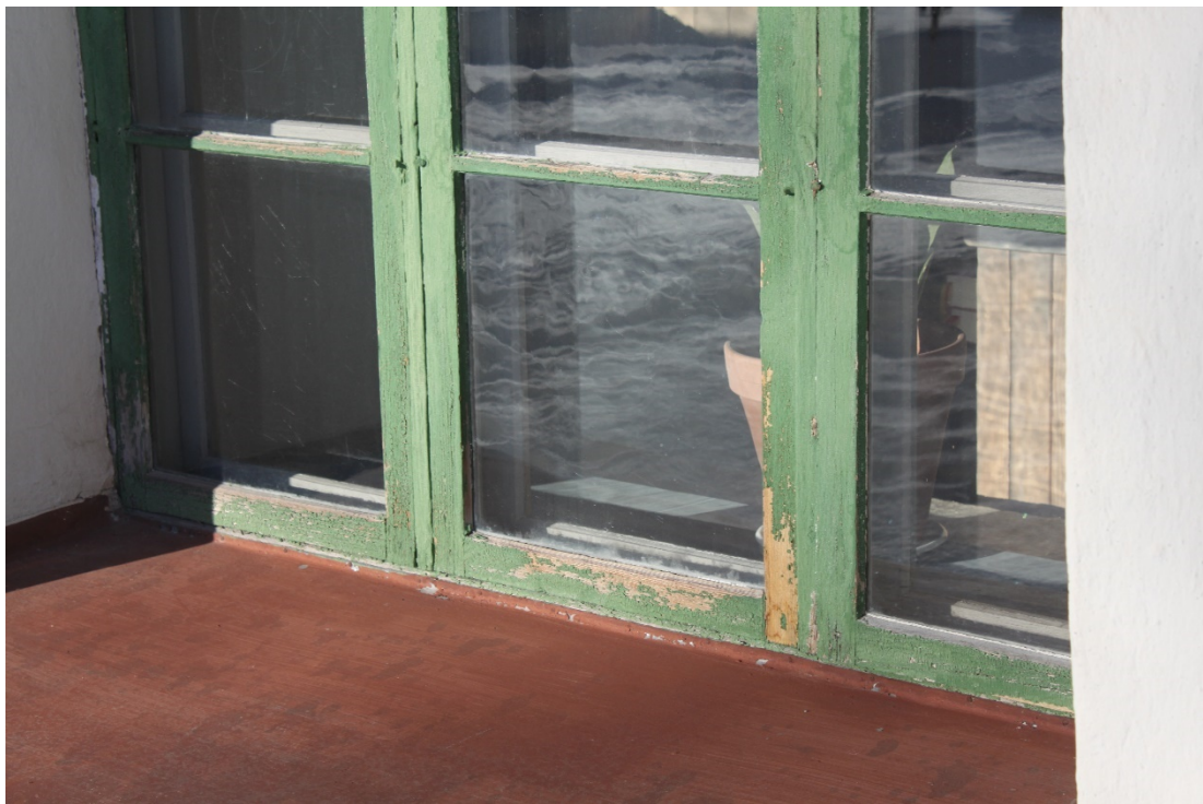
Figur 23 Fönster före åtgärd.
