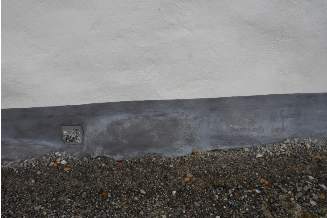
Figur 12 Vid slutbesiktningen, hade den grå sockeln fläckvis fått en vit "mjölkig" hinna.
