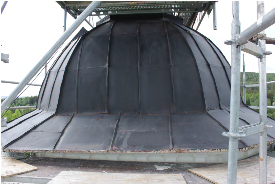
Figur 26 Nedre del av tornhuv före åtgärd.
