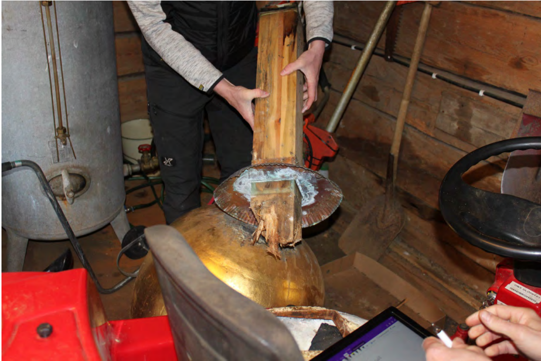
Figur 31 Kors och korsglob före åtgärd.
