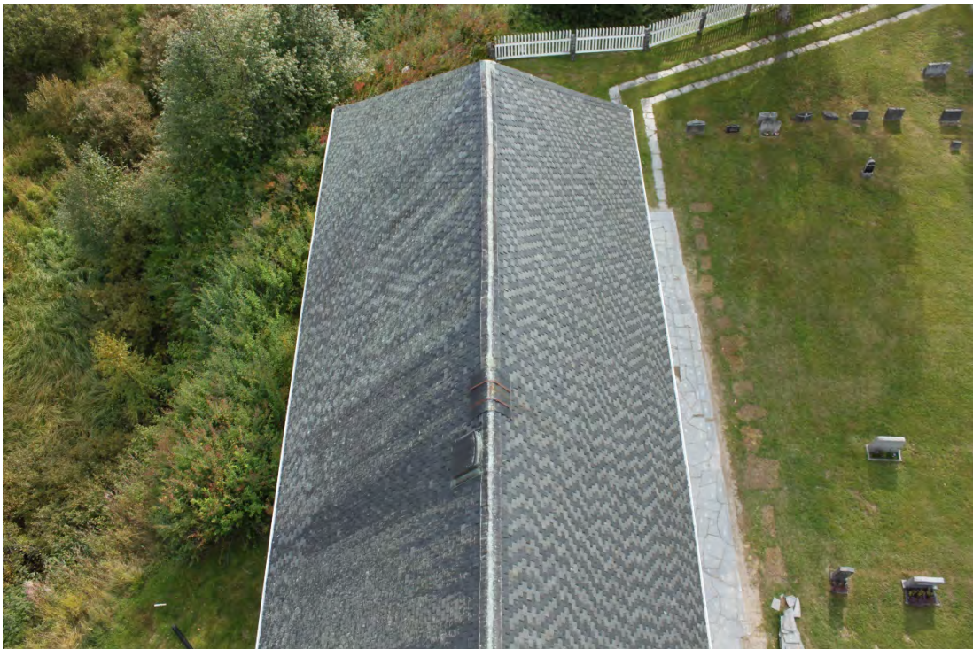
Figur 16 Skiffertak före åtgärd.
