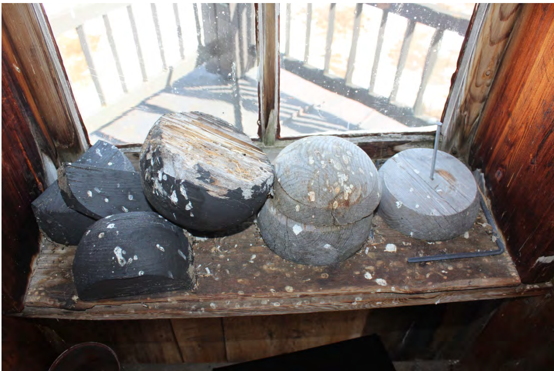
Figur 22 Trasiga träklot inne i lanterninen.
