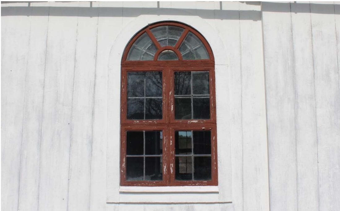
Figur 14 Fönster före åtgärd.
