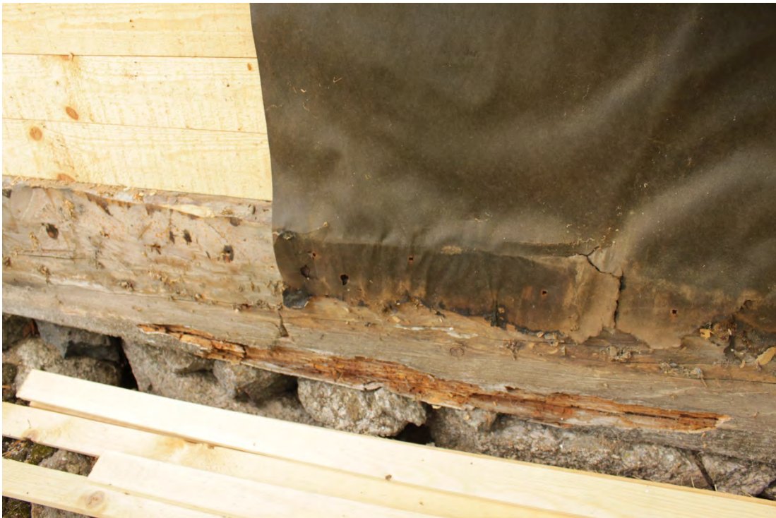
Figur 6 Den skadade syllen sedan panelen demonterats.
