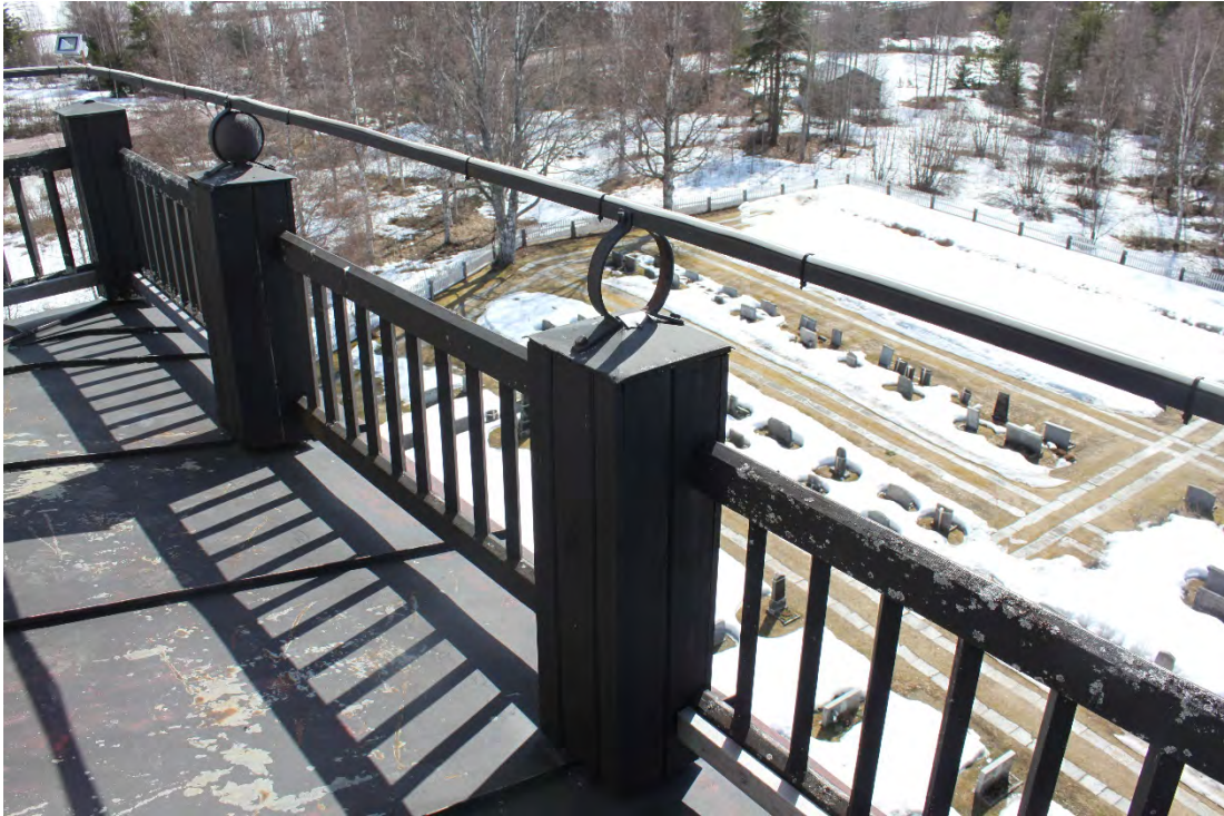
Figur 19 Räcke före åtgärd.
