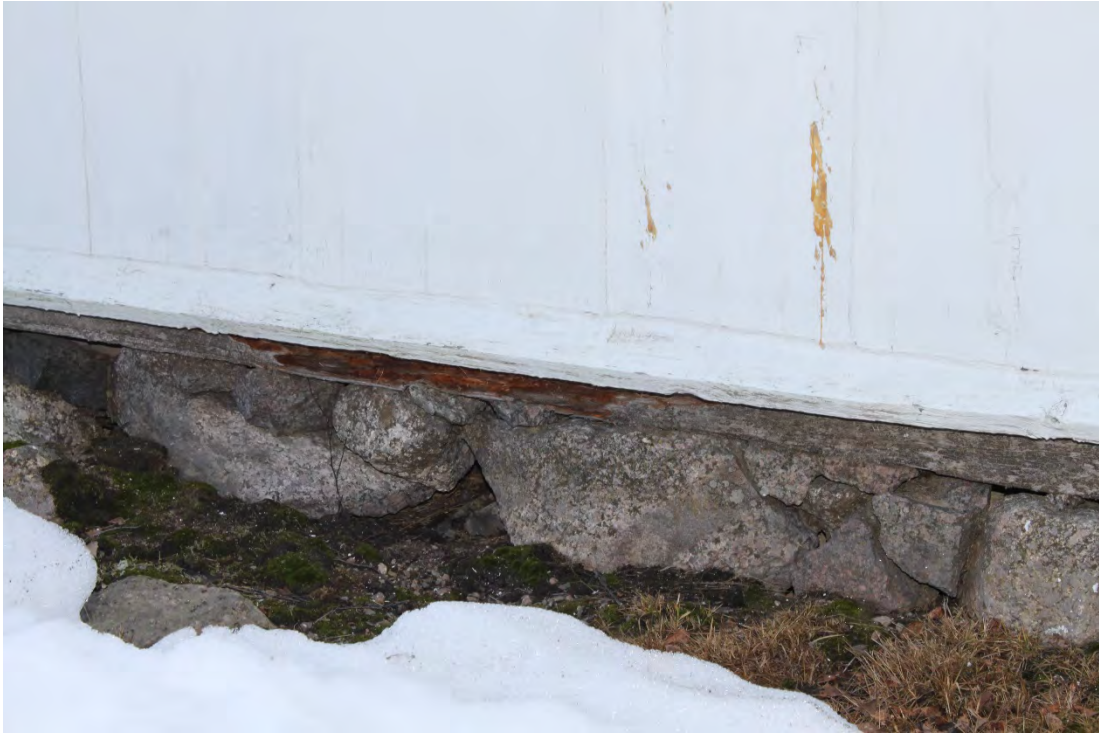
Figur 5 Rötskadad syll mot norr.
