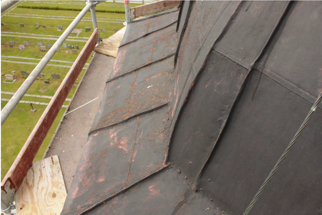
Figur 27 Plåten var delvis anfräkt av rost.
