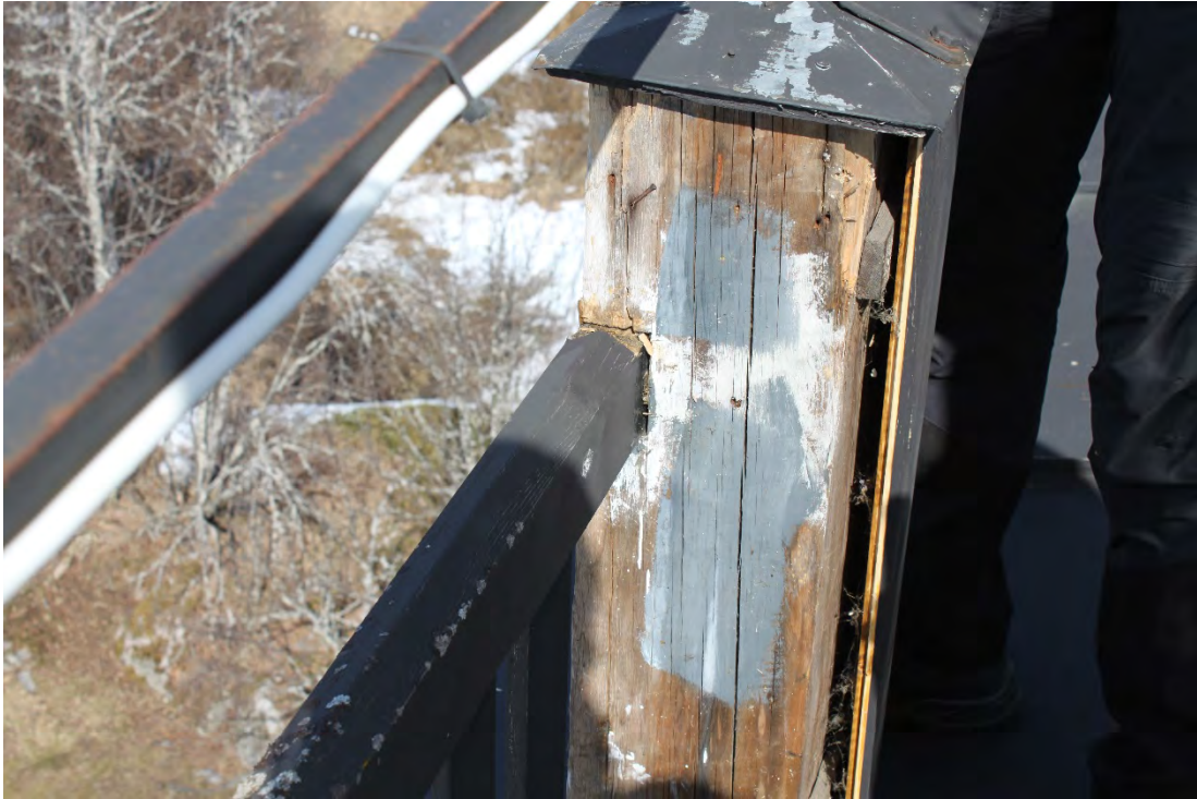
Figur 21 Färg på stolpe under panelen.
