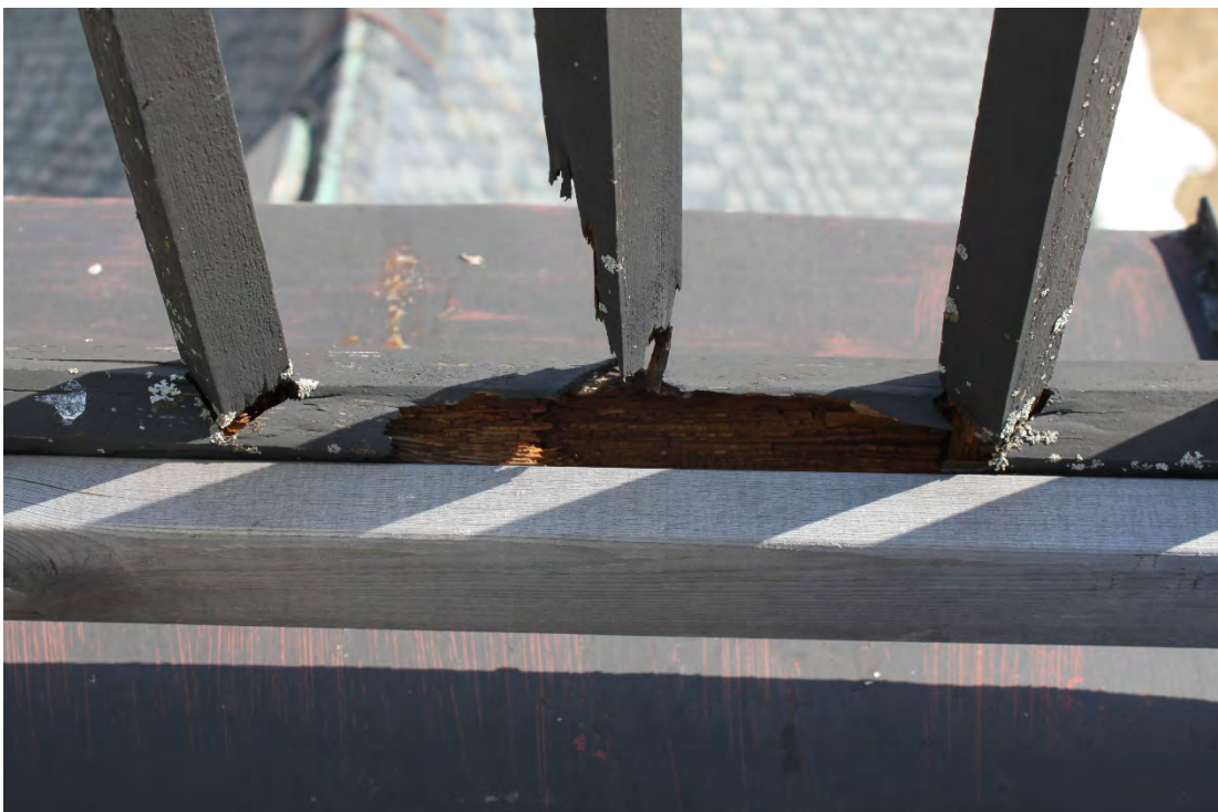
Figur 20 Rötskada nedtill på räcke.
