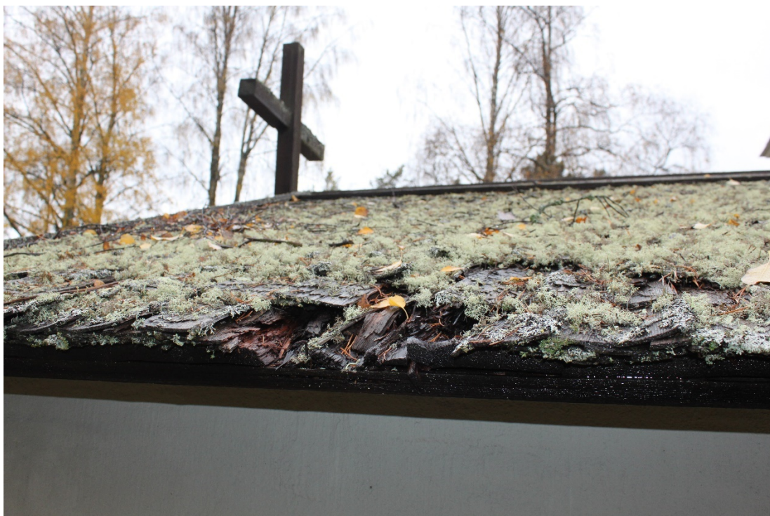
Figur 13 Taket på bårhuset var väldigt rötskadat både vad gällde spåntäckning och underlag.
