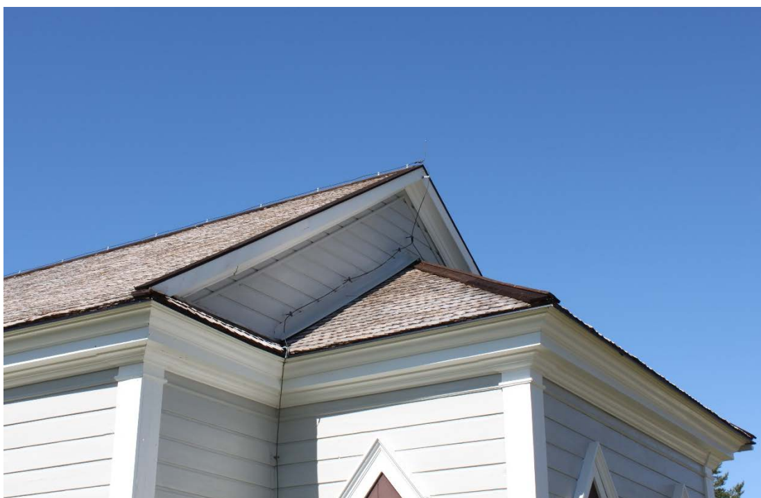
Figur 10 Möte mellan sakristia och långhus efter åtgärd.
