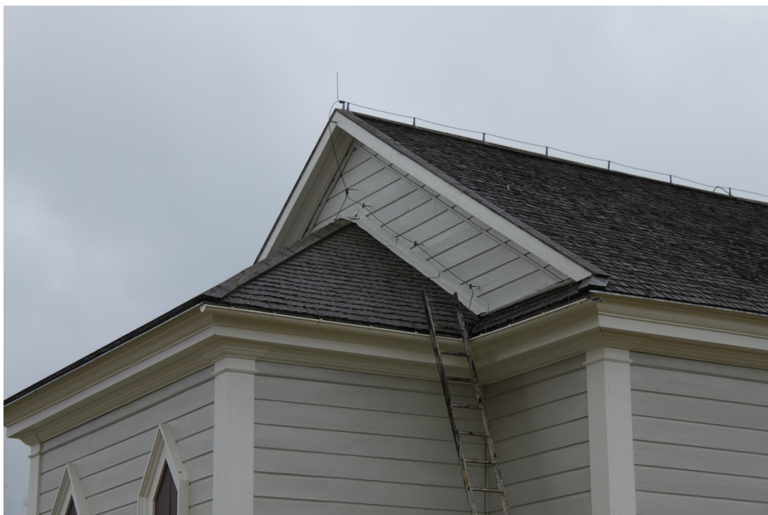
Figur 9 Möte mellan sakristia och långhus före åtgärd.
