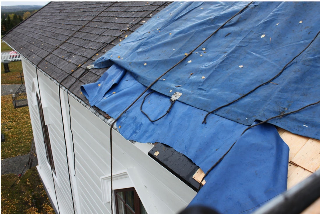
Figur 2 Notera den obehandlade fotplåten på den orörda delen av taket och den svarta fotplåten på den del som lagts om.
