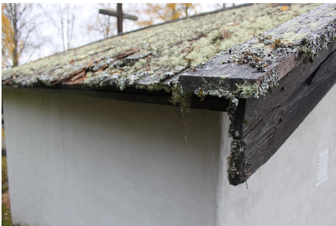
Figur 14 Vindskiva och vattbräda före åtgärd.
