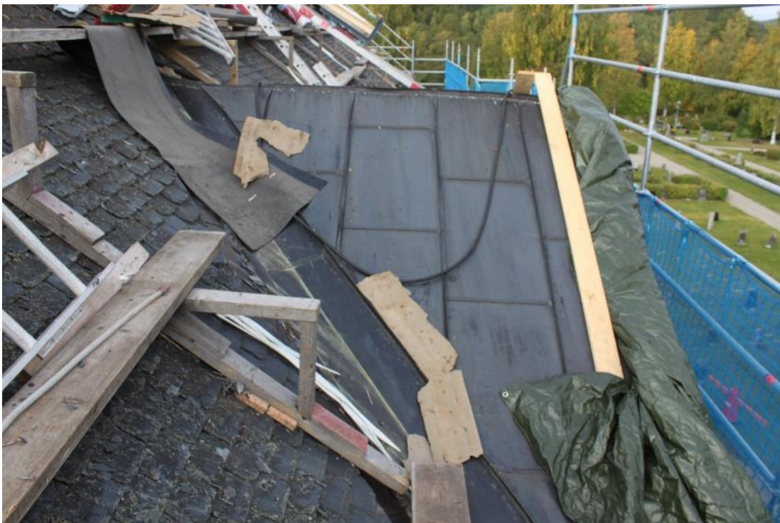
Figur 17 Plåtbeklädnad på trekantsgavel före åtgärd.
