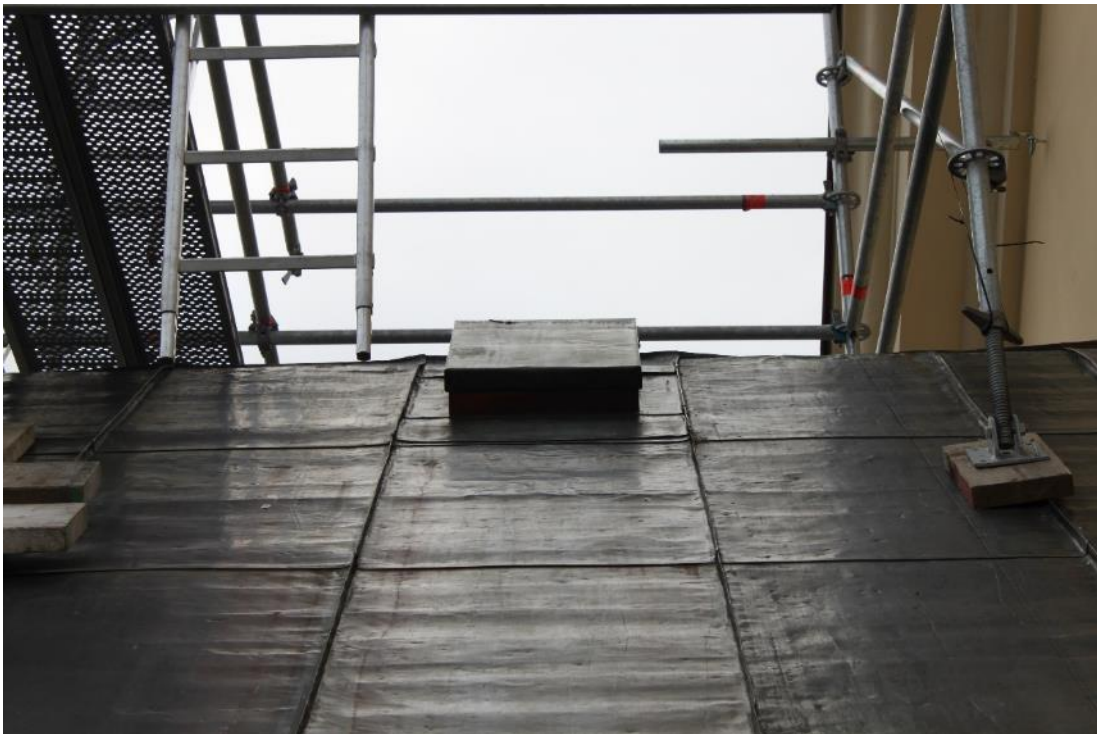
Figur 21 Taklucka på sakristian före åtgärd.
