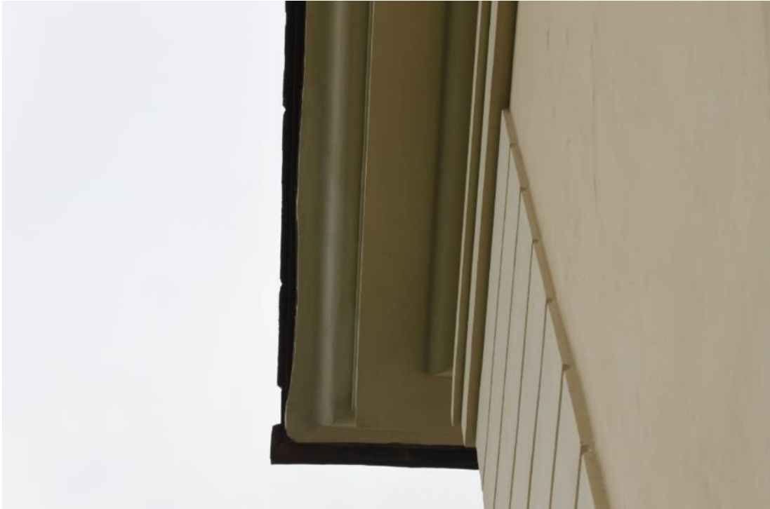
Figur 24 Listverket mot norr har lagats på de ställen där det blev skador i samband med att plåten togs bort.
