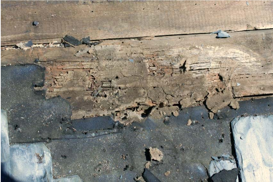
Figur 4 Rötskador förekom på rotebrädorna. På bilden syns de båda lagren gammal underlagspapp.
