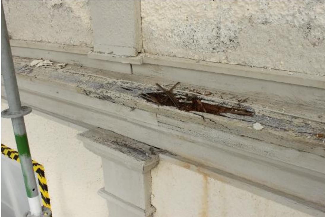
Västra fasaden med rötskada i gesimsen något norr om andra fönsteraxeln, sett från söder.
