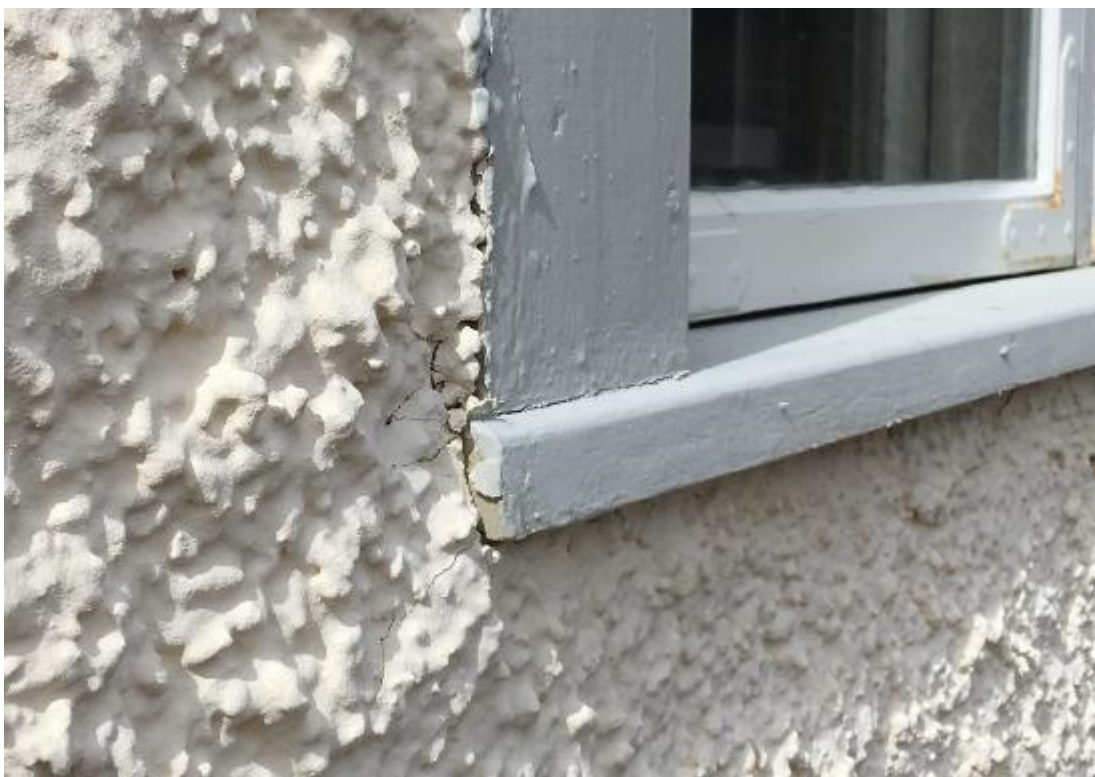
Exempel på droppbräda och hur de bara stack ut en centimeter utanför putsen eller på vissa ställen inte alls.
