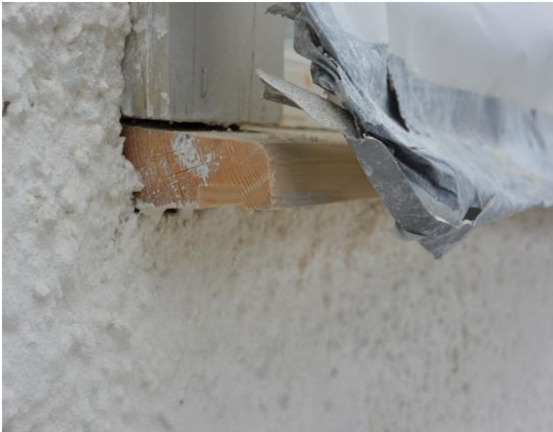
Ny förlängd droppbräda. Avsikten är att den ska leda ut dagvatten så vattnet inte droppar på putsen.
