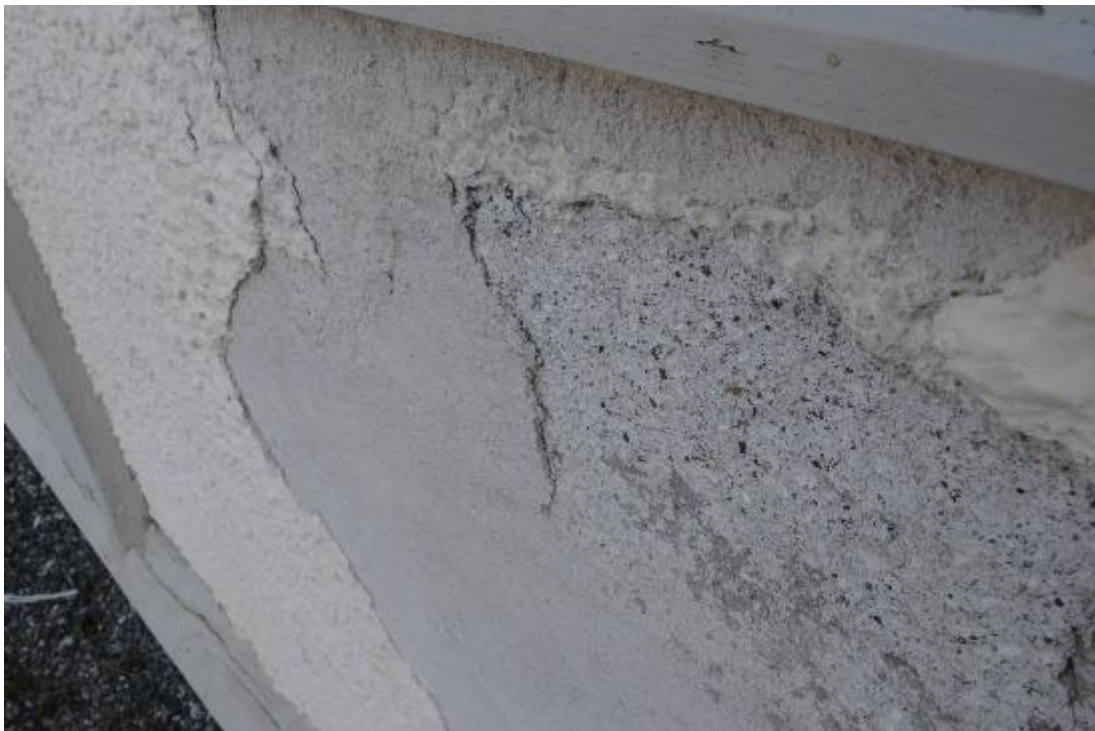
Båda fotografierna visar exempel på putsskada under bottenvåningens fönster (till vänster om entrén).
