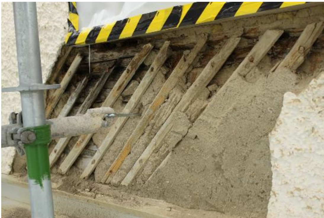
Detalj fotografiet visar skadan i både timmer och puts under fönstret (1 trappa). Lägg märke till den gula kulören på ribben som antas vara herrgårdens kulör då den hade träpanel.
