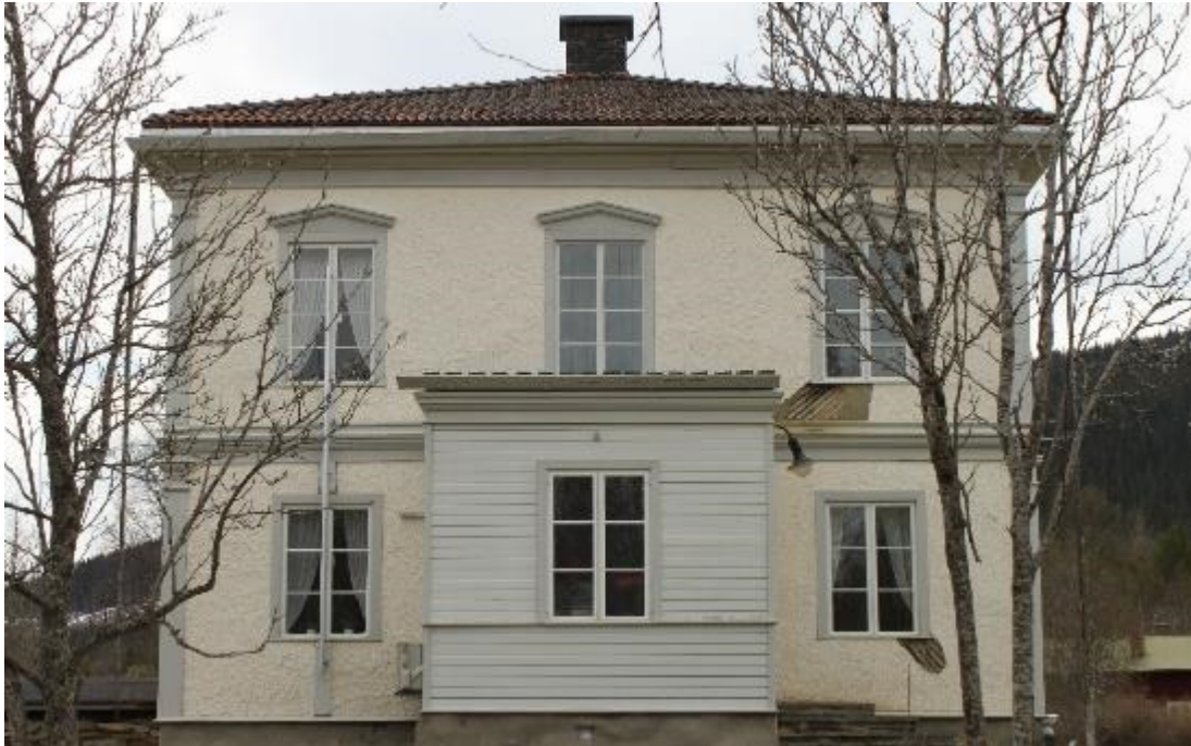
Norra fasaden med de två större skadorna under västra fönsteraxeln.
