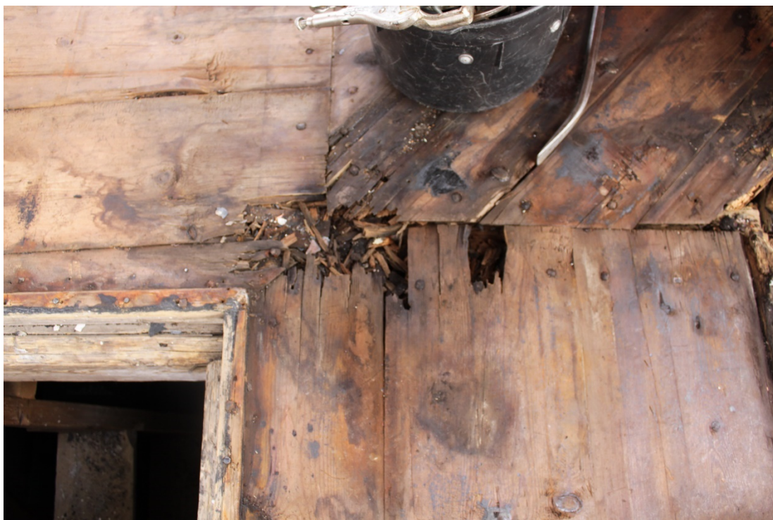
Figur 18 Rötskador förekom i golvet på lanternin.
