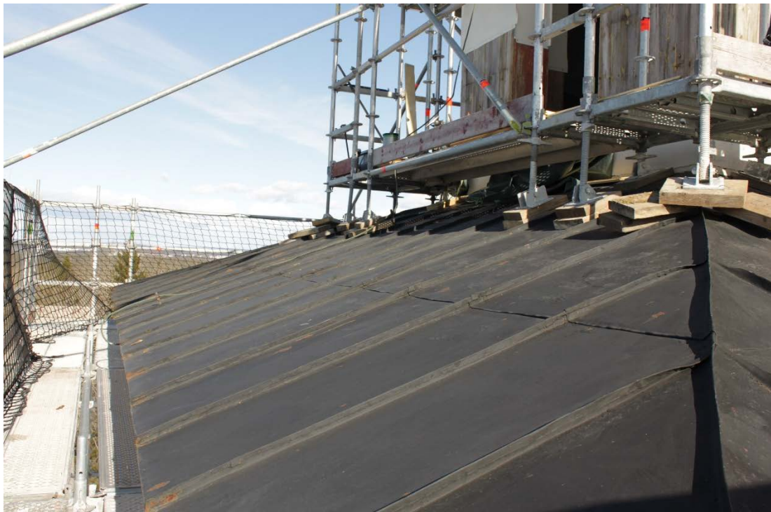
Figur 1 Plåttaket på tornhuven innan åtgärd.
