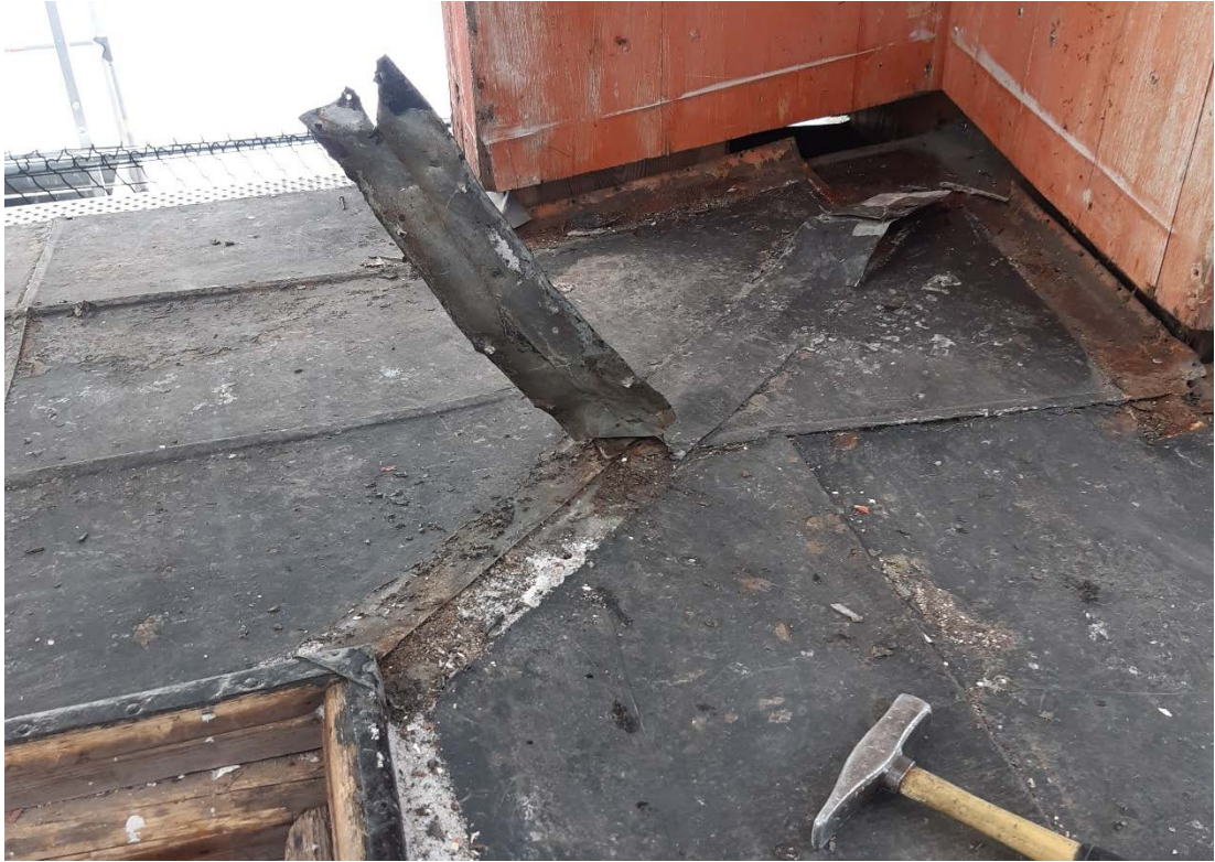
Figur 4 Plåttäckning på lanterningolvet före åtgärd (foto: Torbjörn Cajonberg, Winther bygg AB).
