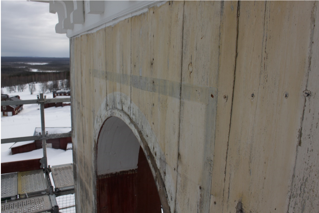
Figur 24 Under den gula färgen framträdde en mörk ram kring öppningarna.
