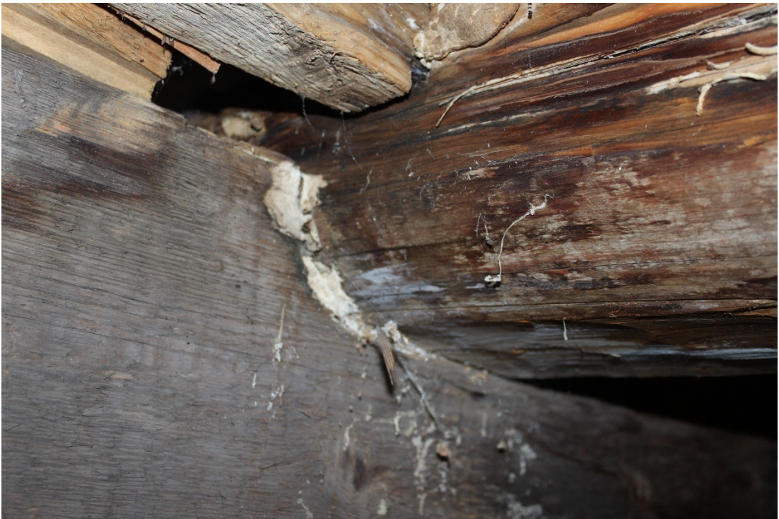
Figur 5 Rötskador och svampangrepp förekom i konstruktionen före åtgärd.
