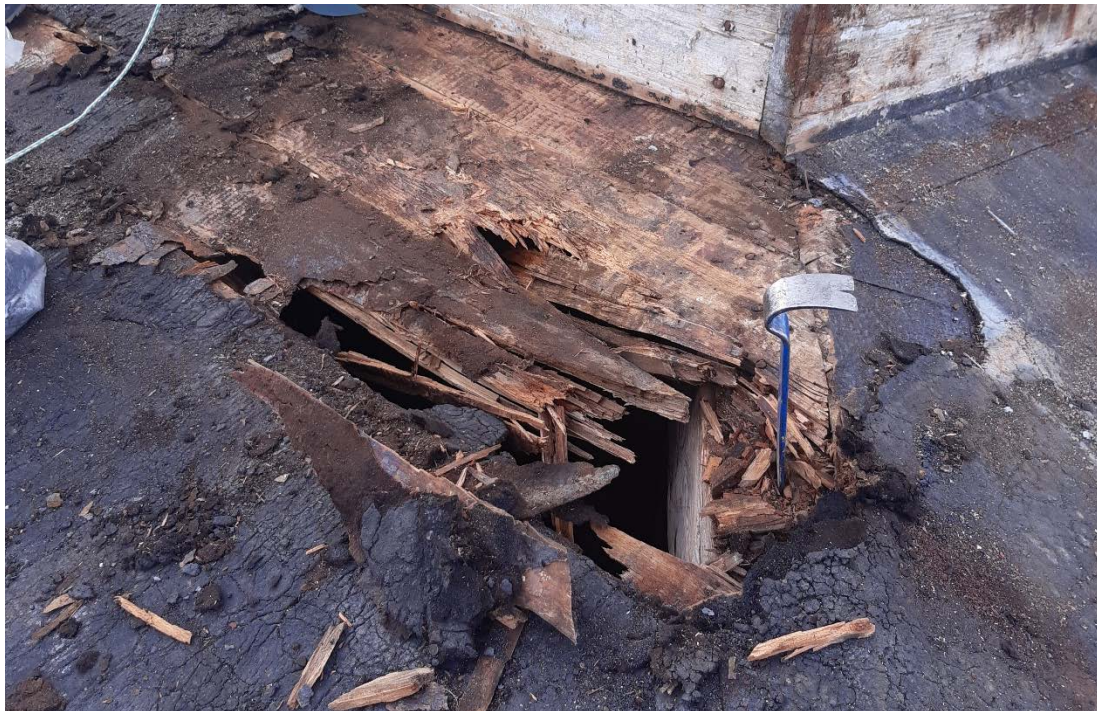
Figur 11 Delar av rotet på tornhuven var rötskadat (foto: Torbjörn Cajonberg, Winther bygg AB).
