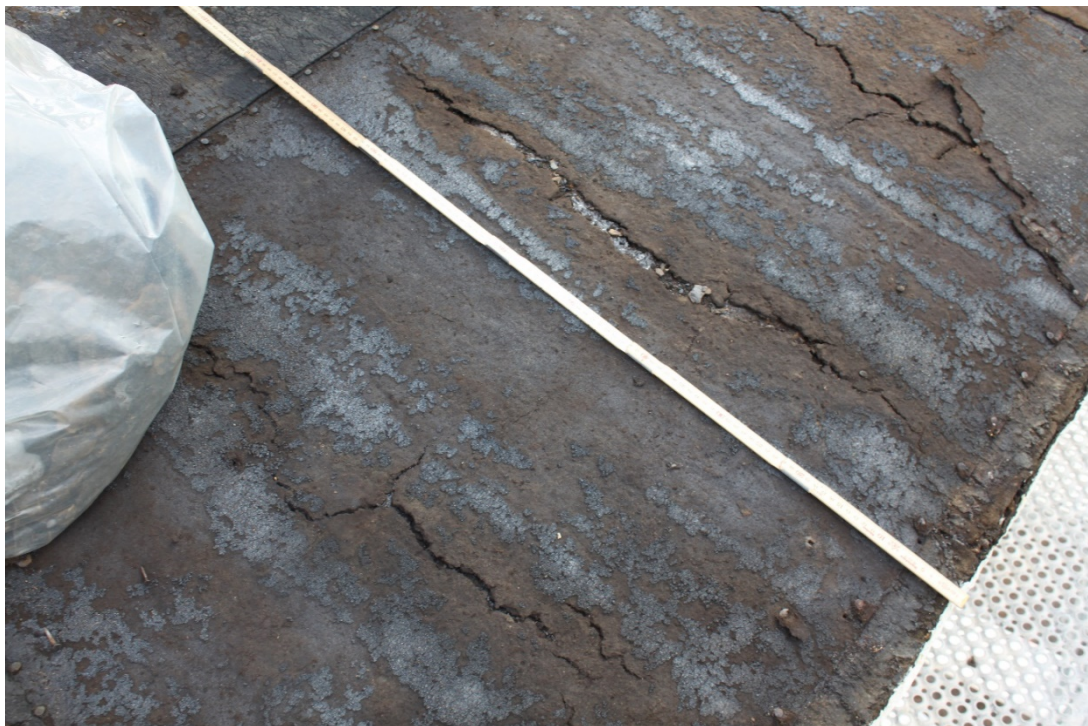
Figur 8 Under plåten låg horisontella våder med en tjock takpapp.
