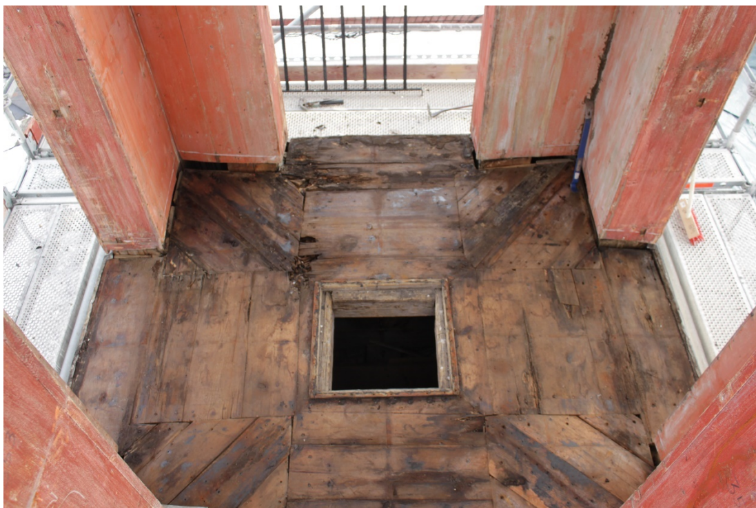
Figur 17 Lanternin sedan plåt rivits på både väggar och golv.
