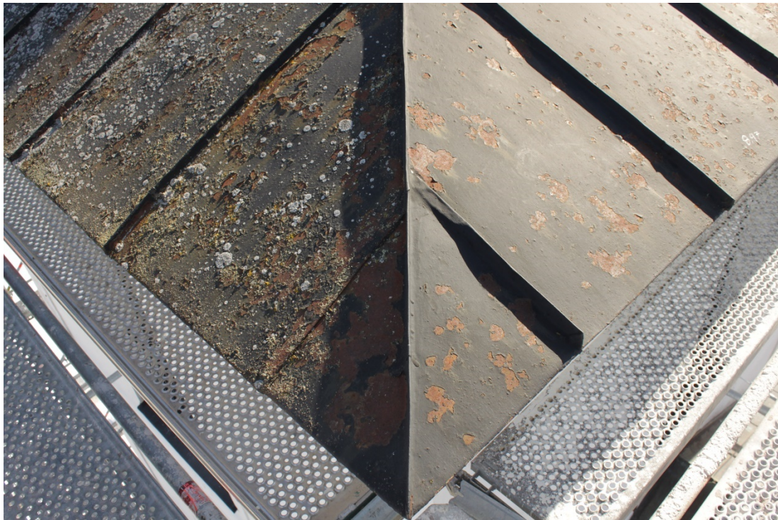
Figur 3 Plåten var angripen av rost.
