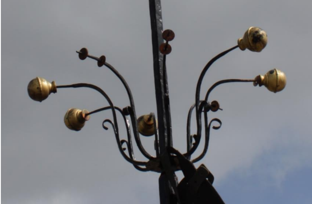
Figur 16 Delar av dekorationer i form av mindre klot på spirorna saknades före åtgärd.
