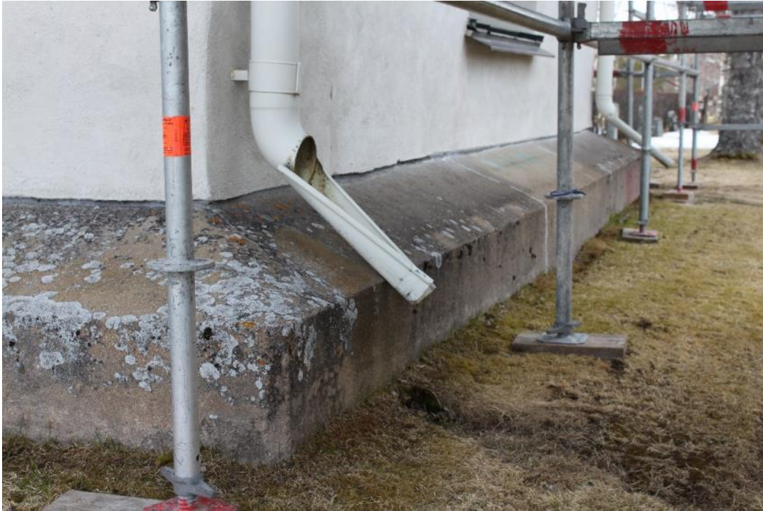
Figur 10 Avslutning på stuprör före åtgärd.
