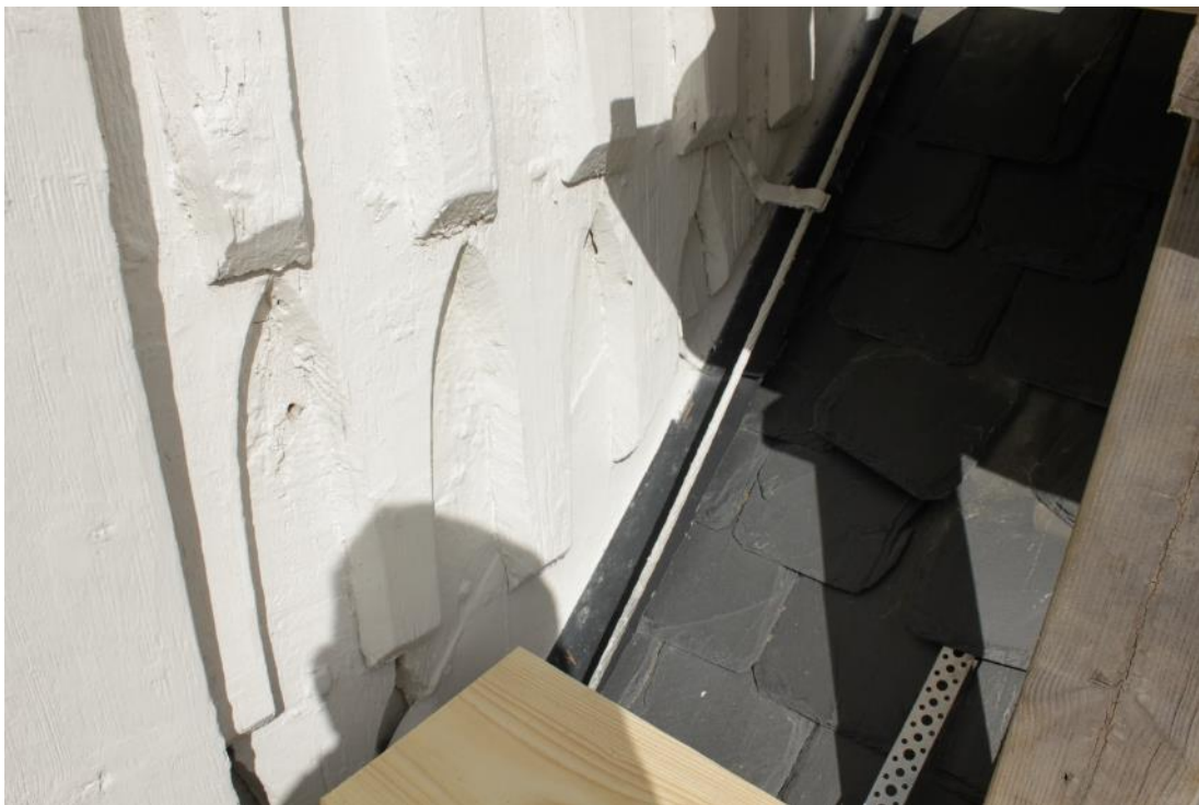
Figur 5 Före åtgärd satt ståndsivian uppstucken mellan spånen och var målad i fasadkulör.
