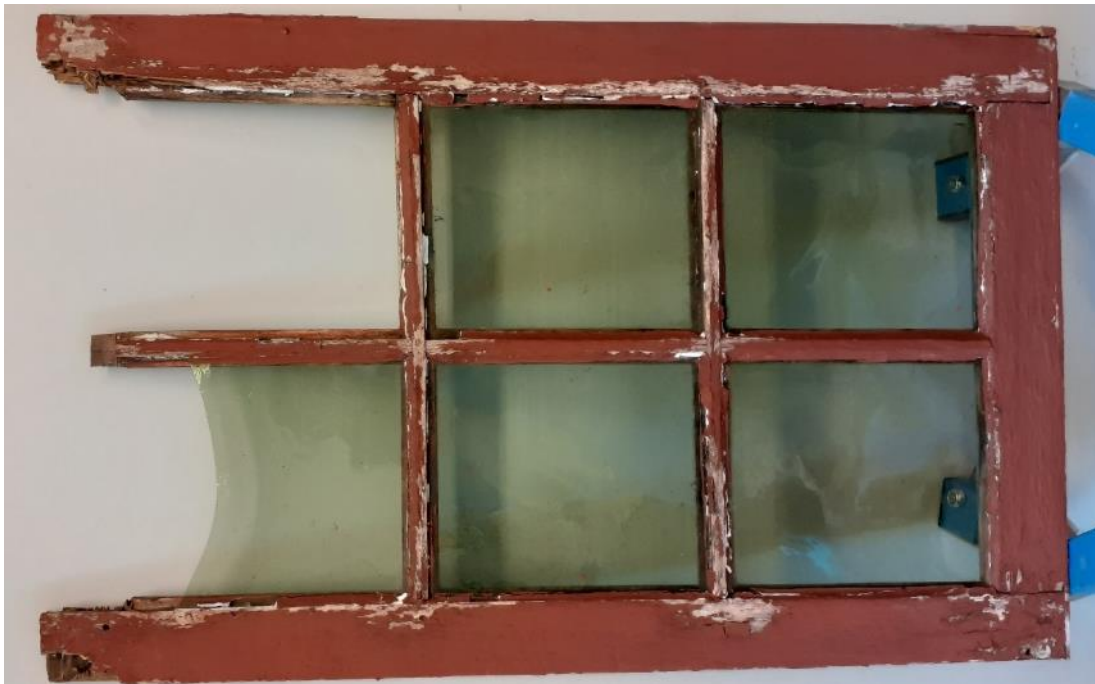
Figur 7 Fönsterbåge i behov av trälagning. Foto: Agneta von Wachenfeldt.
