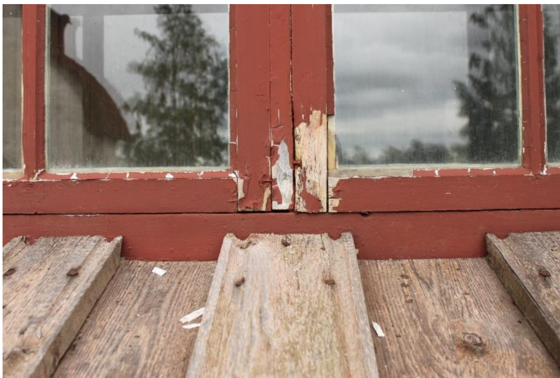
Figur 5 Fönsterbågarna var i behov av kittning.
