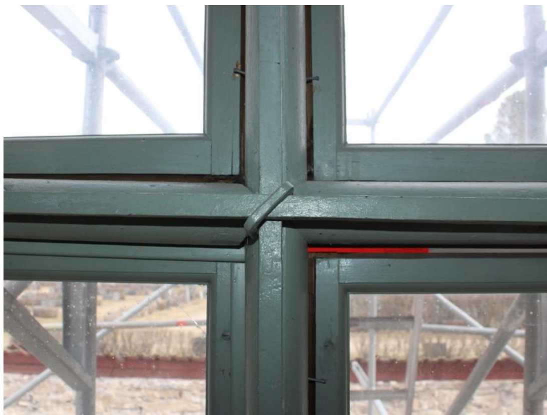
Figur 10 Fönster i sakristian. På nedre högra bågen syns glipan mellan karm och fönsterbåge. På den nedre vänstra bågen har lister monterats för att täcka glipan.
