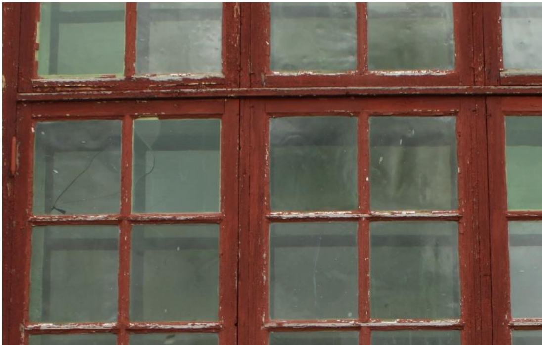
Figur 4 Före åtgärd var fönstren i behov av målningsbehandling.
