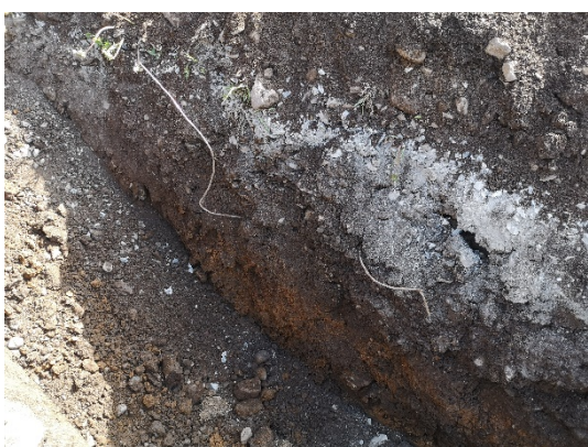
Figur 13. Ståltråd som sticker ut ur schaktkanten i del C. Fotad mot Ö.
