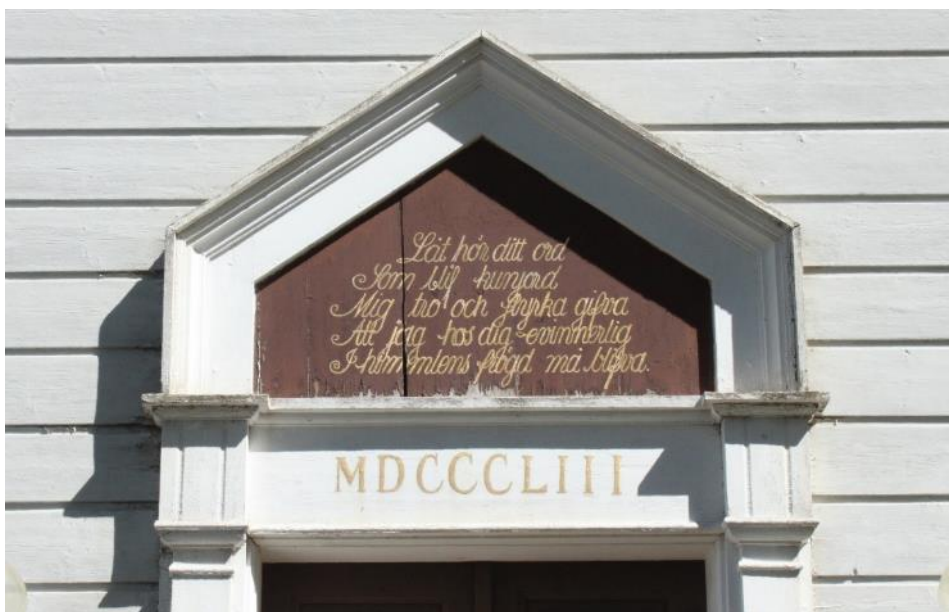
Figur 27 Inskriptionstavla före åtgärd. Den brunmålade bakgrunden hade färgbortfall i framförallt nederkant.
