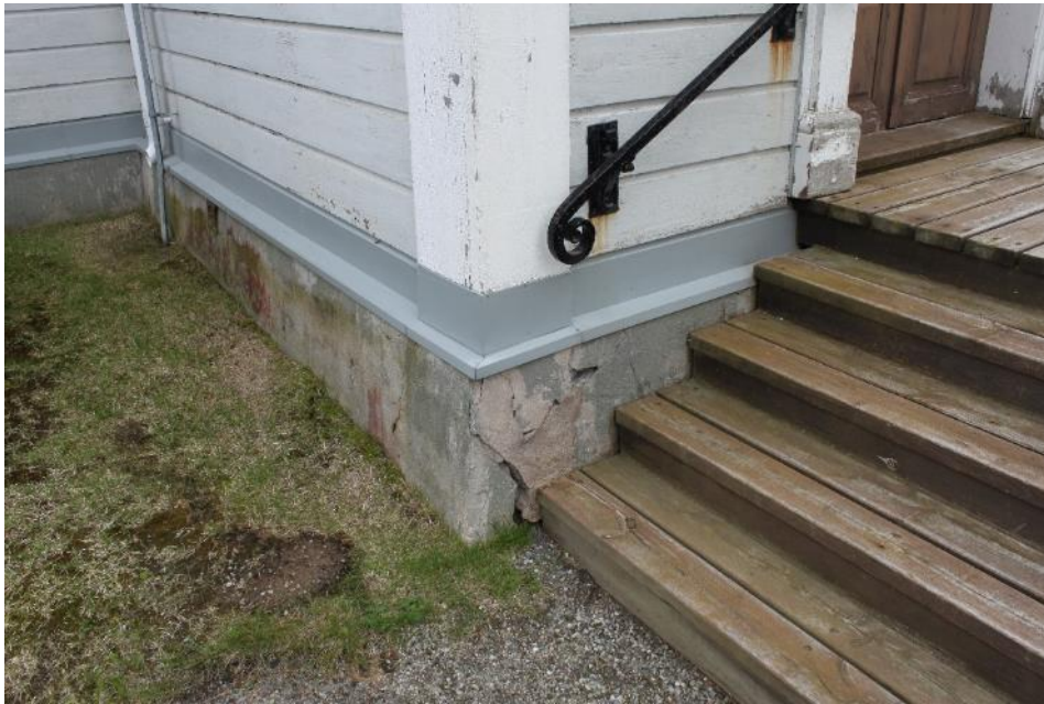
Figur 35 Vid tornet och sakristian fanns en del sprickor i betongen och färgbortfall.
