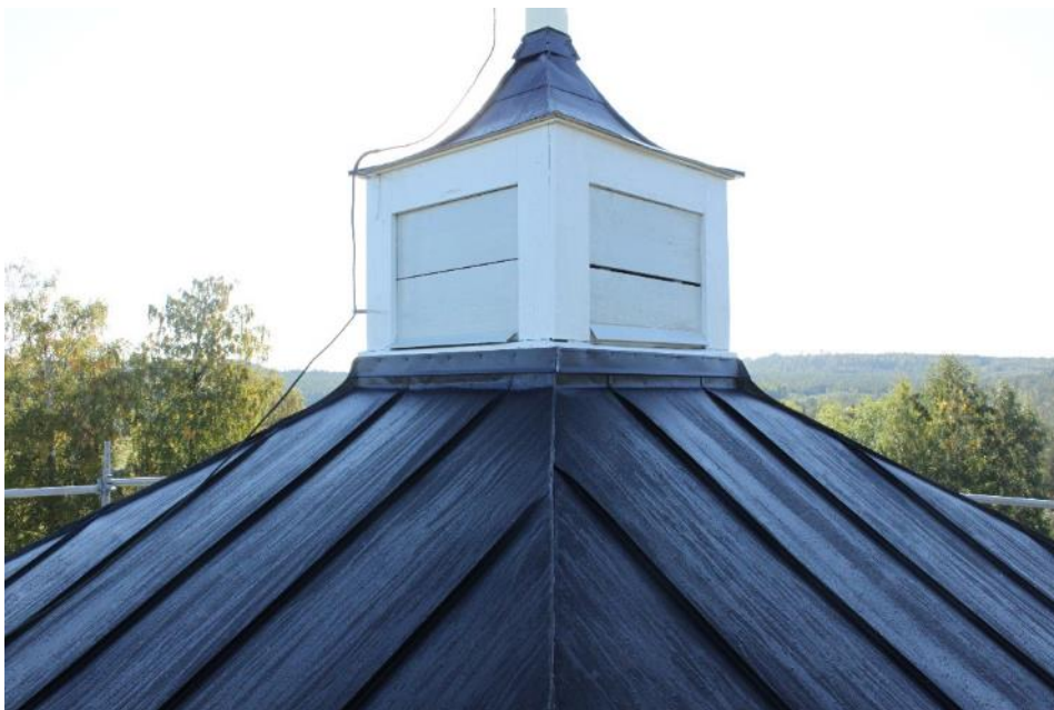
Figur 30 Ovanpå det nya rotet har man lagt papp och sedan svartlackerad plåt i bandtäckning.
