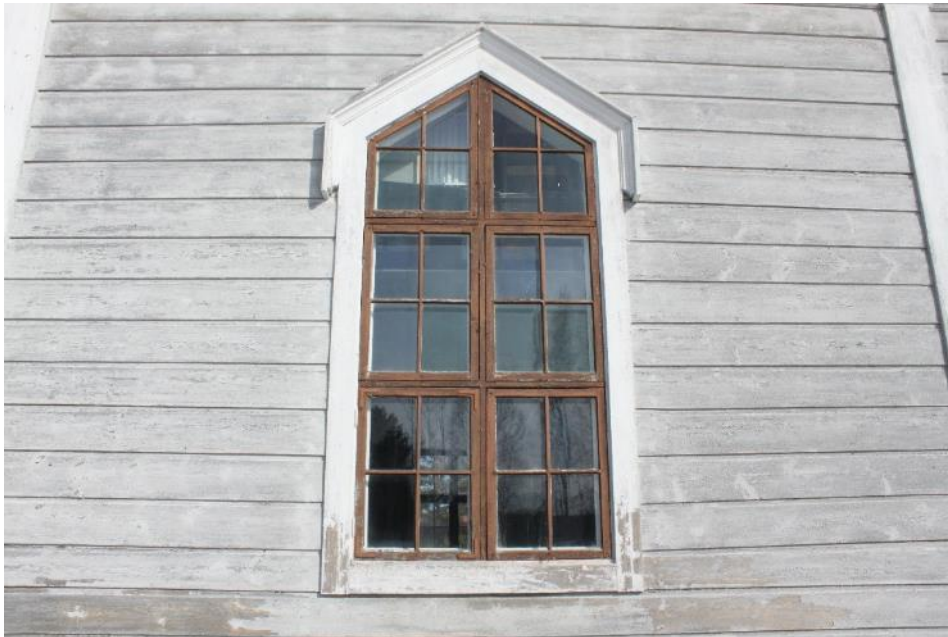
Figur 17 Fönstren hade spruckna och uttorkade färgskikt och kittfalsar, de var i behov av att åtgärdas.
