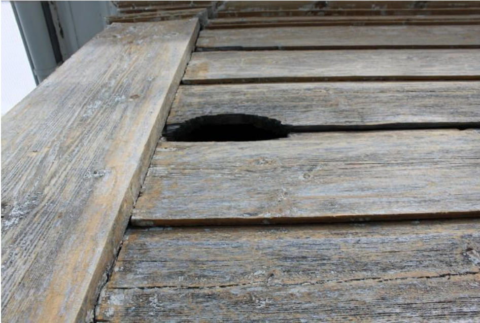
Figur 13 Skada på torn före åtgärd.
