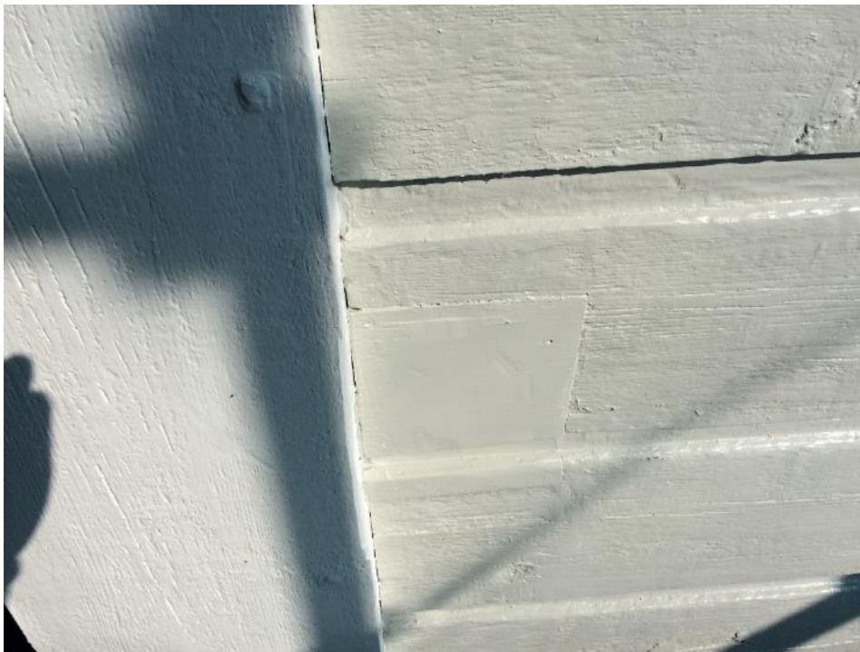
Figur 12 På de flesta ställena har trä använts vid lagning av fasaden. Lagningarna är väl utförda och smälter, efter målning in bra med panelen.
