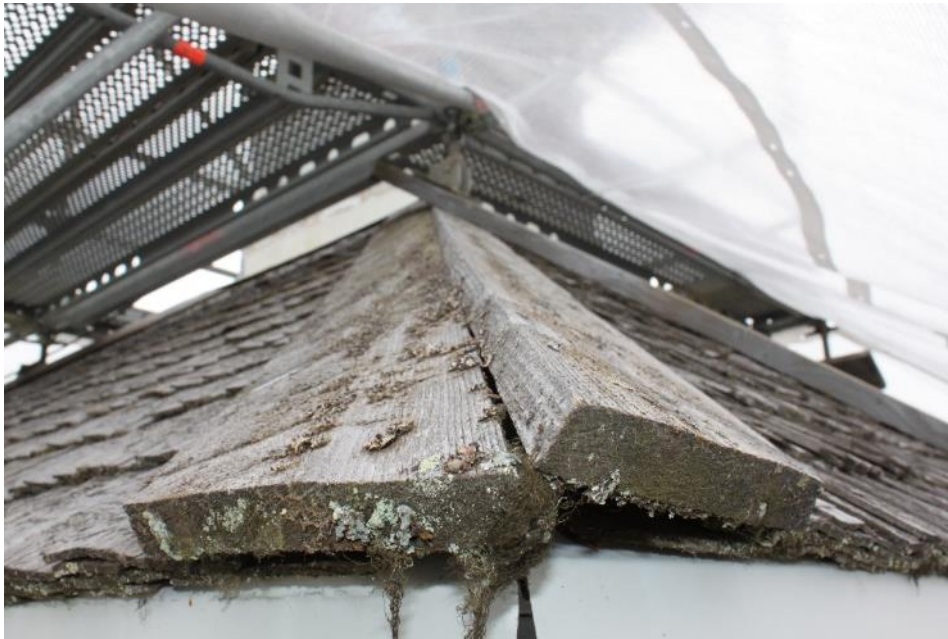
Figur 31 Tornets spåntäckning från 1976 var väldigt anfrätt.
