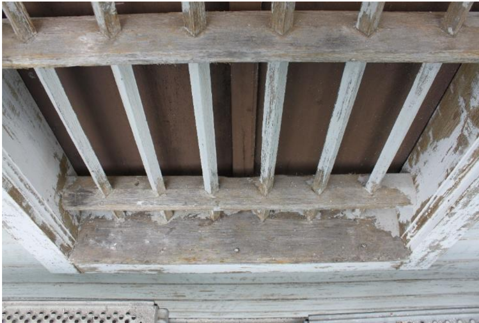
Figur 21 Bottenstycket i karmen vid ljudlucka åt öster var dålig.
