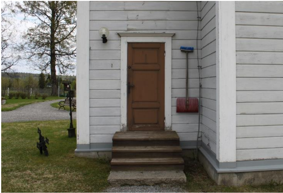
Figur 25 Dörr till sakristia före åtgärd.
