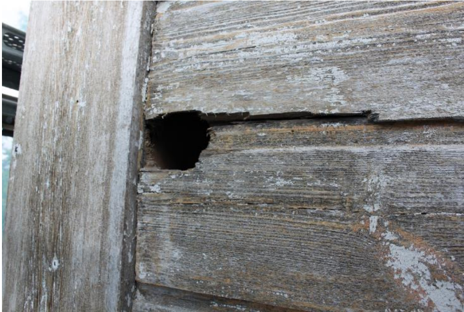
Figur 15 Skada på torn före åtgärd.
