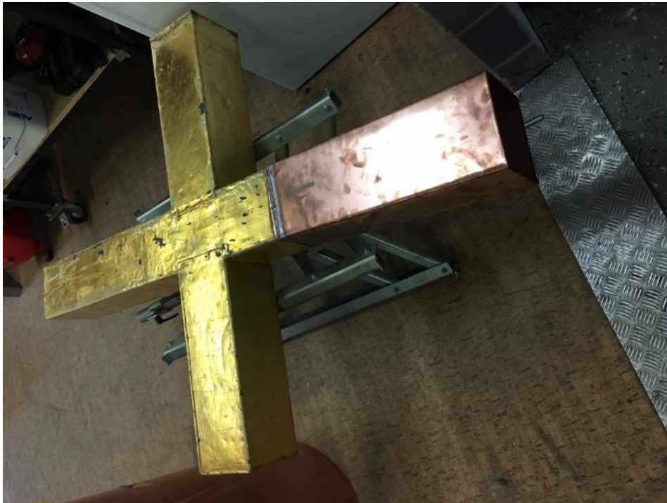
Figur 32 Anslutningshylsan har bytts ut då den gamla hade spruckit. Foto: Tommy Olsson, Arenatum AB.
