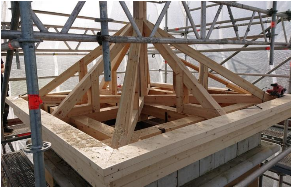
Figur 18 Samtliga takstolar kom att förnyas vid åtgärderna 2018. foto: Joakim Nilsson Hammarstrands bygg.
