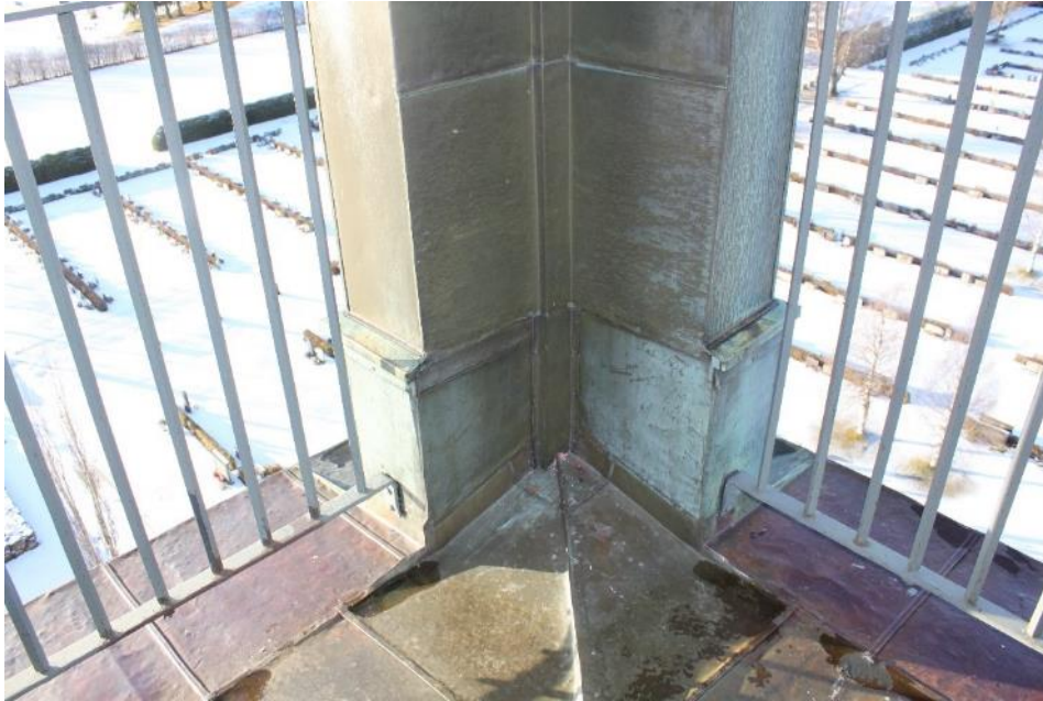
Figur 28 Före åtgärd. Räckena kring lanterninen hade en del rostfläckar och var i behov av målningsbehandling.
