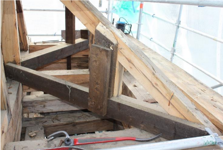
Figur 14 Sedan lanterninen uppfördes har minst en större reparation gjorts, vilket resulterat i utbytt virke i konstruktionen. Några av takstolarna hade försetts med förstärkningar. På två av takstolarna hade delar tidigare ersatts med nya av klenare dimensioner
