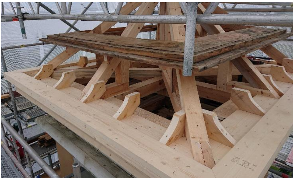
Figur 19 De små "tassarna" fanns inte tidigare. Dessa gjordes för att ge stöd för rotet, så att underlaget för taktäckningen ska vara stumt. Hamnerdal kyrka, foto: Joakim Nilsson Hammarstrands bygg.
