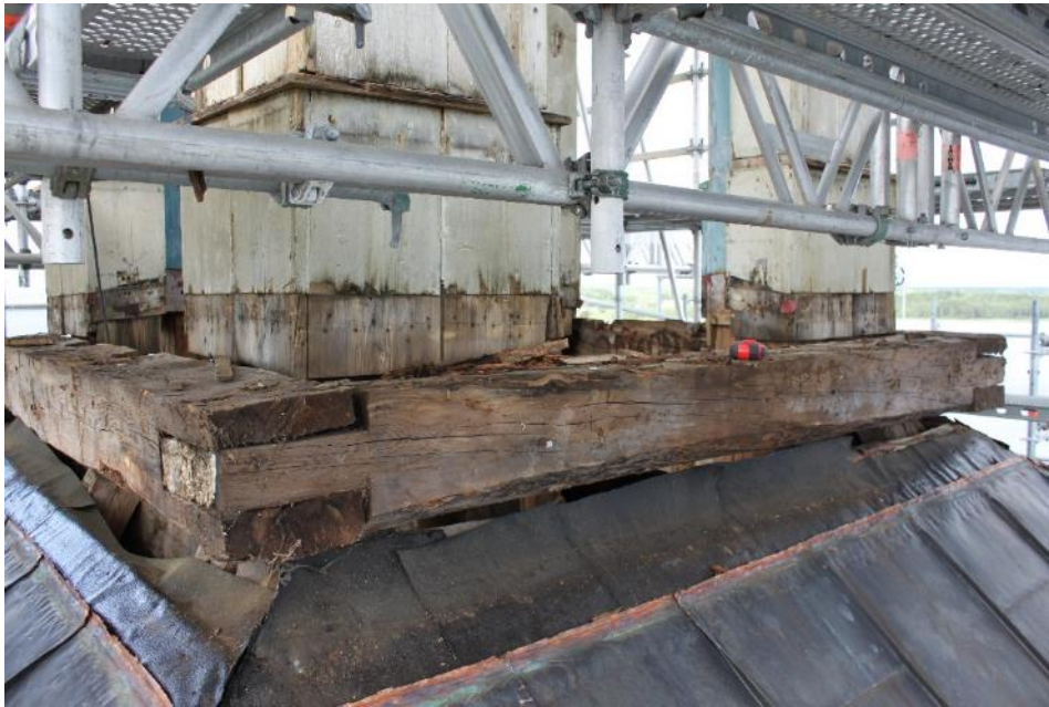
Figur 10 Sockel på lanternin efter att rötskadade halvklavor monterats bort.
