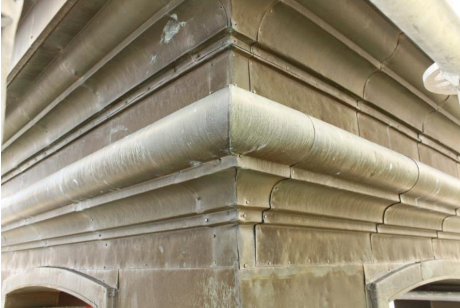
Figur 22 Lanternin före åtgärd. Den gamla plättäckningen var enkelfalsad eller bara omlottlagd plåt som spikats fast.
