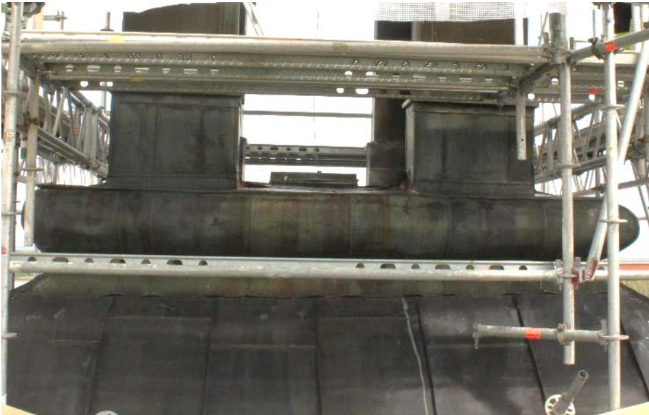
Figur 9 Sockel på lanternin före åtgärd.
