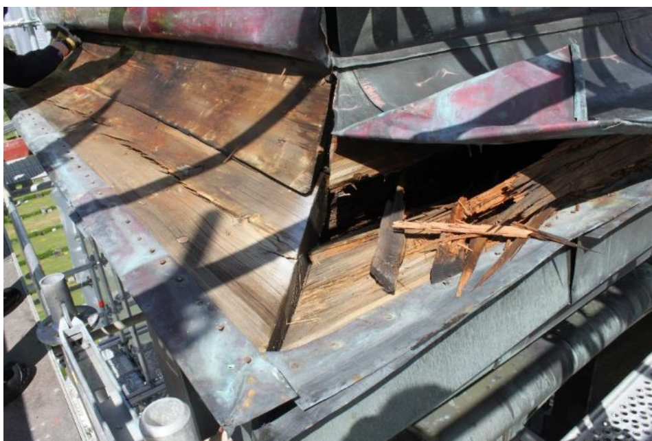
Figur 13 Sydvästra hörnet av lanterninens tak. Under plåten fanns rötskador.
