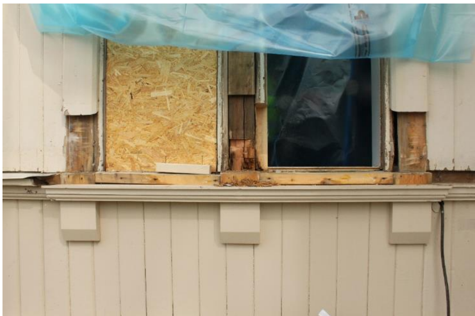
Figur 5 Mellan fönstren på den västra sidan av tornet, upptäcktes rötskador mellan fönstren.
