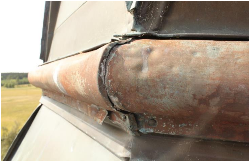
Figur 40 En del lösa plåtar noterades på tornspiran.
