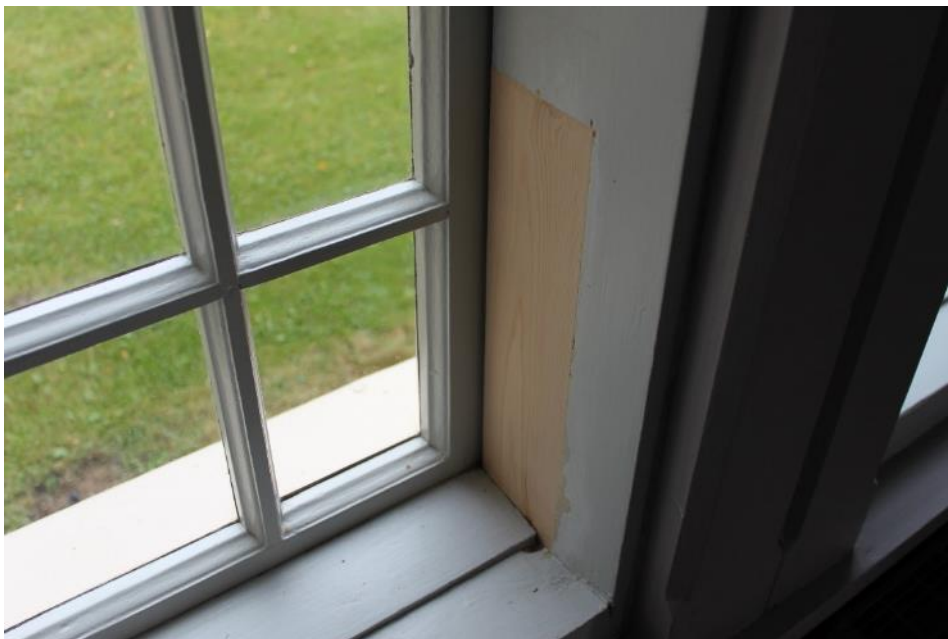
Figur 11 Vid slutbesiktningen var ilagningen i karmen ännu inte målad på insidan.
