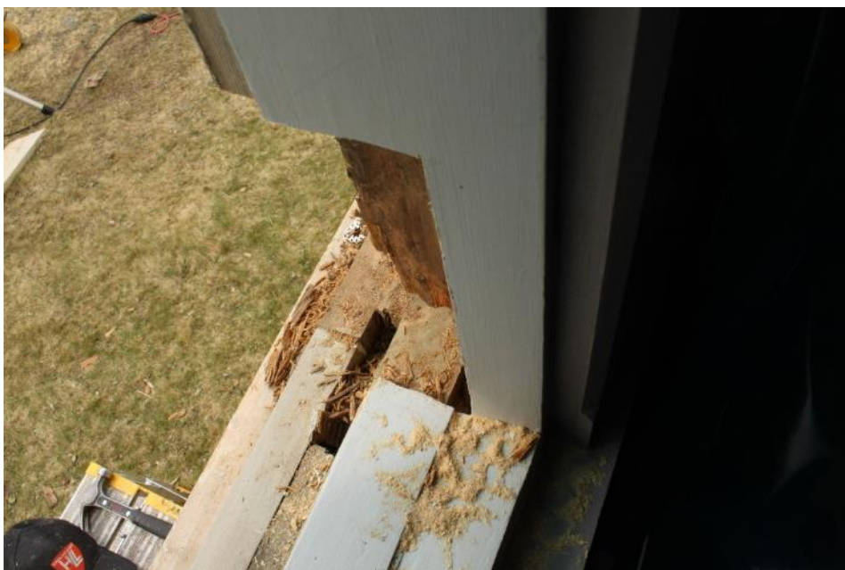
Figur 7 Karmen sett från insidan efter att skadade delar tagits bort.
