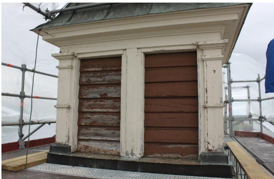
Figur 31 Lanternin före åtgärd.
