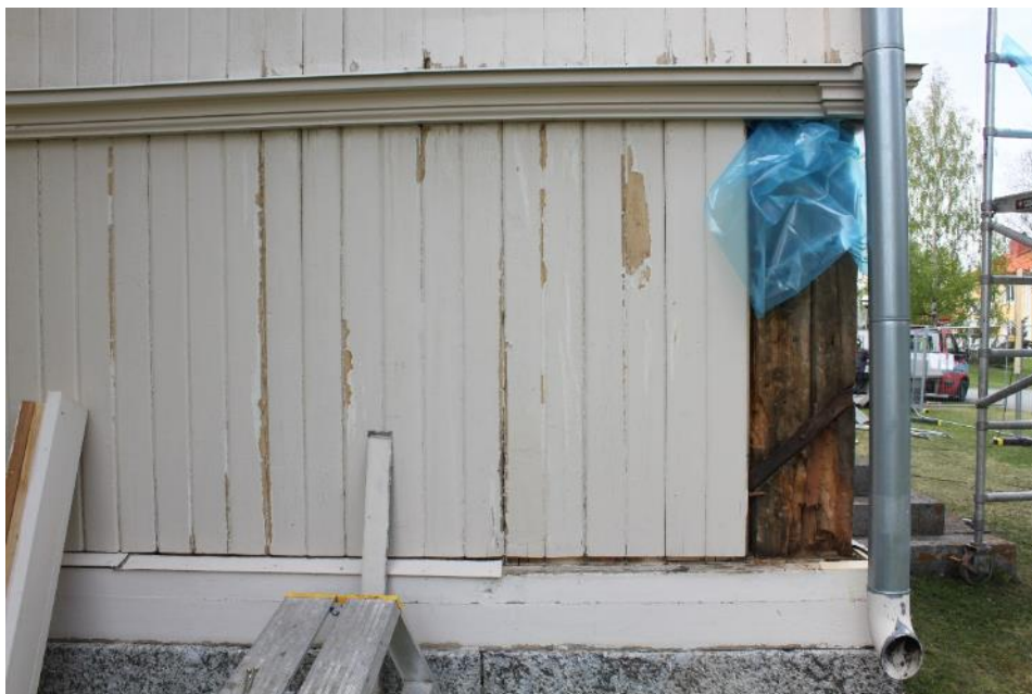
Figur 12 Vid det sydöstra hörnet upptäcktes vid demonteringen av knutbrädorna, en gammal rötskada nedtill.
