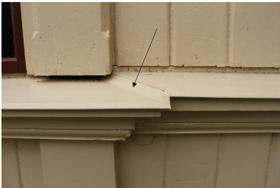
Figur 4 Notera höjdskillnaden mellan midjebandslist och fönsterbleck.
