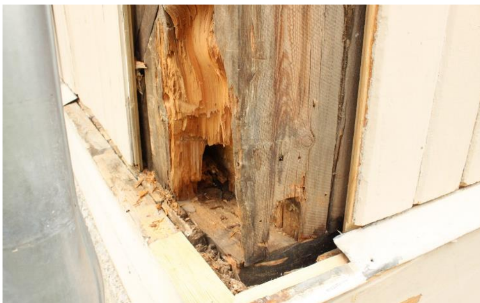
Figur 13 Timret står i ett spår i syllen, men vid skadan saknades den yttre delen av den stående fyrskärningen. Även det spår som den tidigare stått i var borta i hörnet.
