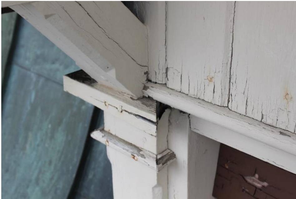
Figur 20 På takkupan åt norr på tornet var delar av listverket skadat/ borta.
