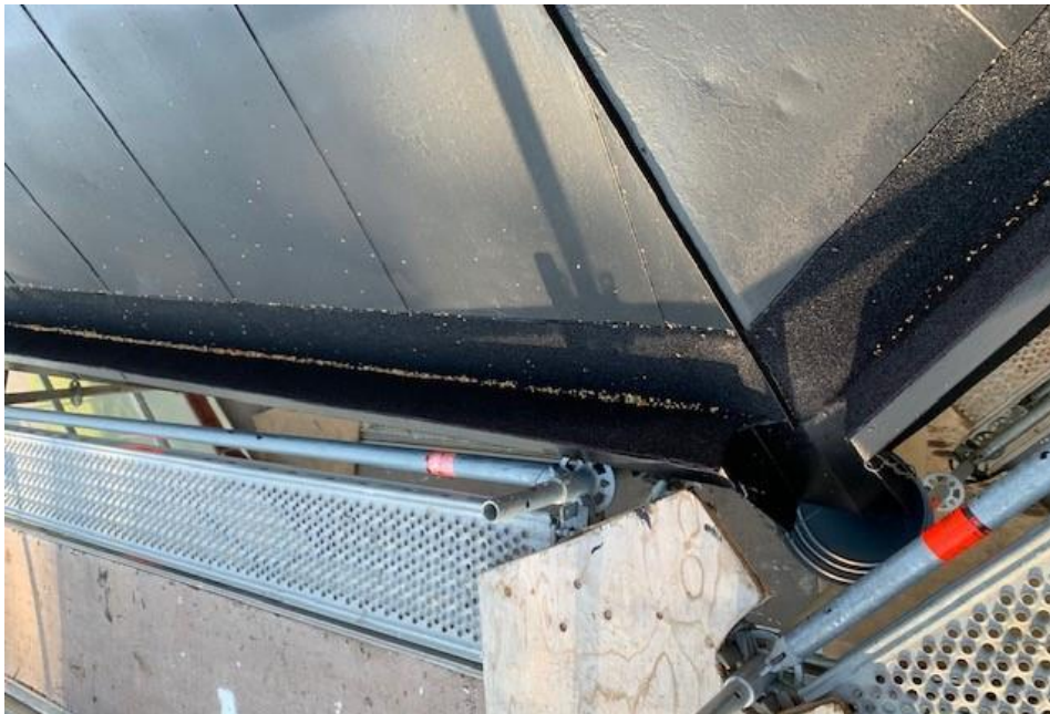
Figur 37 Taket på sakristian efter att rännan lagats. (foto: Tobias Brandt)
