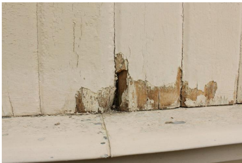
Figur 15 Vid det sydöstra hörnet fanns en del mindre skador på panelen ovanför midjebandslisten.
