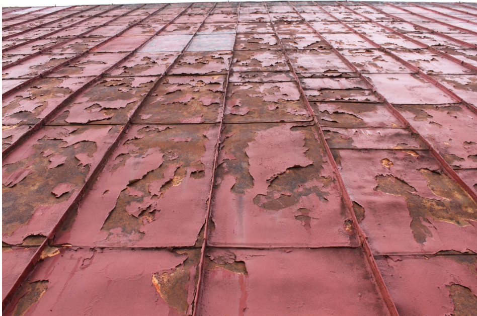
Figur 3 Norra takfallet före åtgärd. Färgbortfall med rostig plåt. Notera partiet med mindre plåtar till höger.
