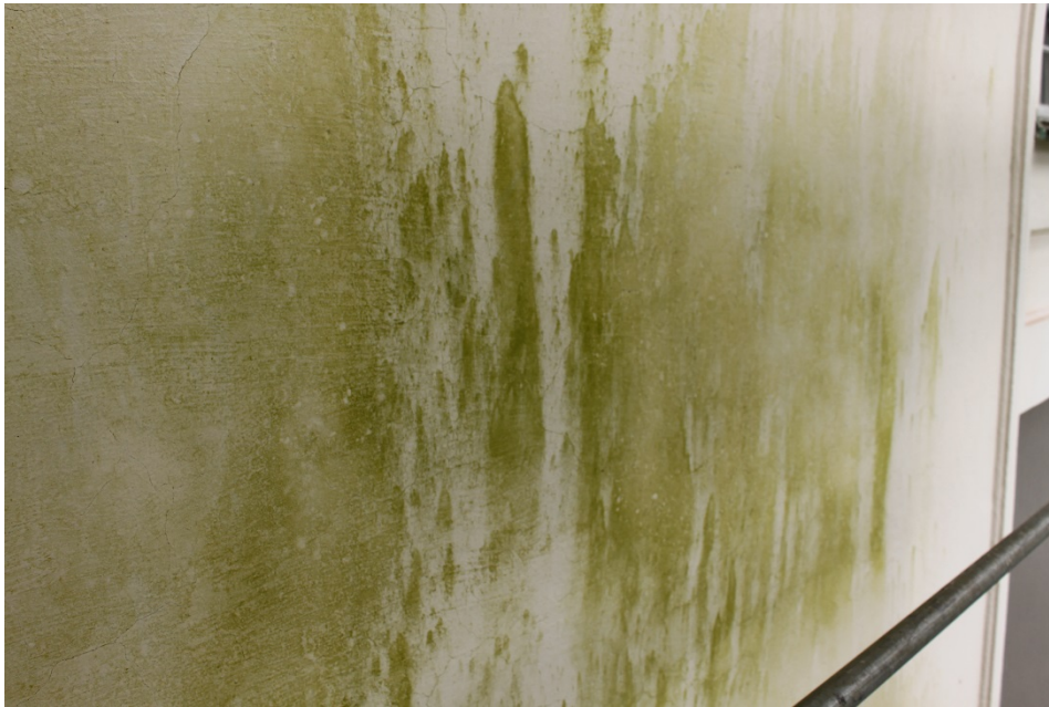
Figur 21 Påväxt på fasaden innansför trappan på ställningen.
