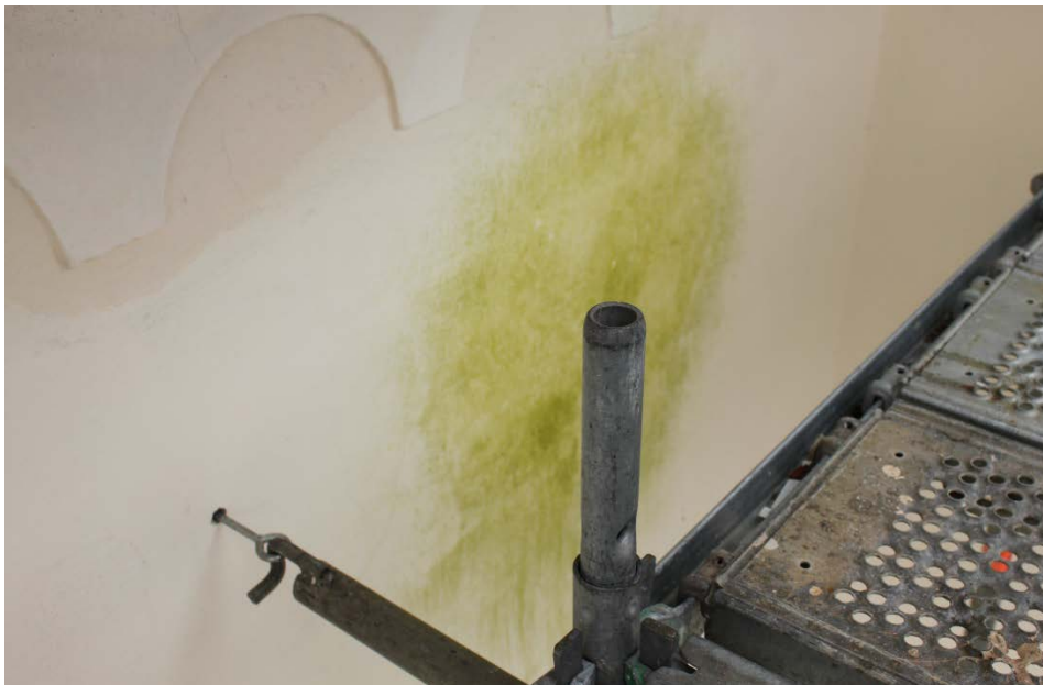
Figur 22 Mindre yta med påväxt på sakristian.
