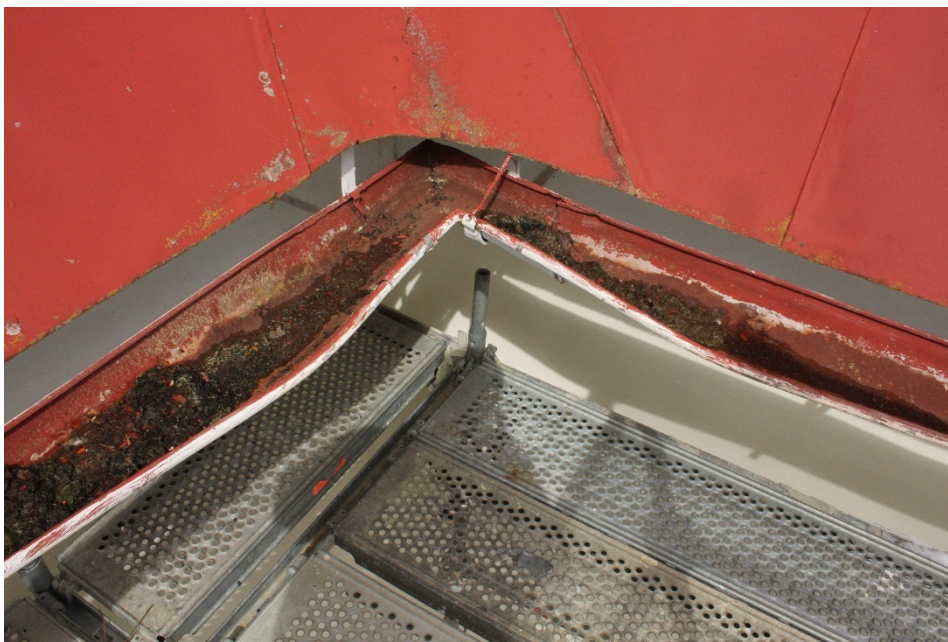
Figur 18 Rännan var före åtgärd deformerad på flera ställen.
