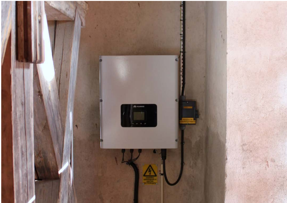
Figur 9 Från solpanelerna dras ledningen den korta vägen in i tornet. På väggen innanför sitter en växelriktare (Huawei SUN2000-17KTL). Foto: 2019-02-27
