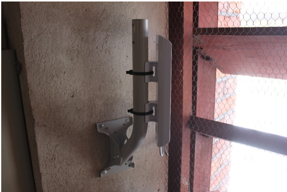
Figur 12 Fjärrstyrning av anläggningen har lösts genom att sätta en mottagare/sändare uppe i tornet i öppningen åt norr. Istället för att montera den synligt på utsidan, gick det att sätta mottagaren på insidan av träjalusien i ljudluckan Foto: 2019-02-27.
