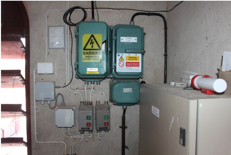
Figur 11 El-centralen i tornet har försetts med varningsskyltar Foto: 2019-02-27.
