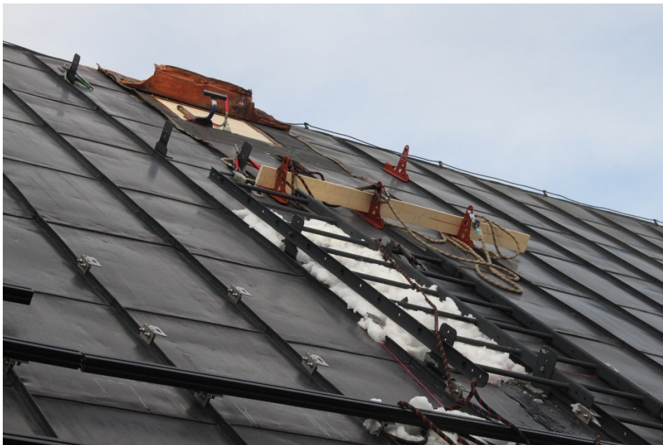
Figur 4 I anslutning till takluckan satt en steg. Fästena till stegen var skruvade genom plåten. Då man inte kunnat se någon antydning till läckage på insidan av taket, landade man i att endast kapa av fästena. Foto: 2019-02-11.
