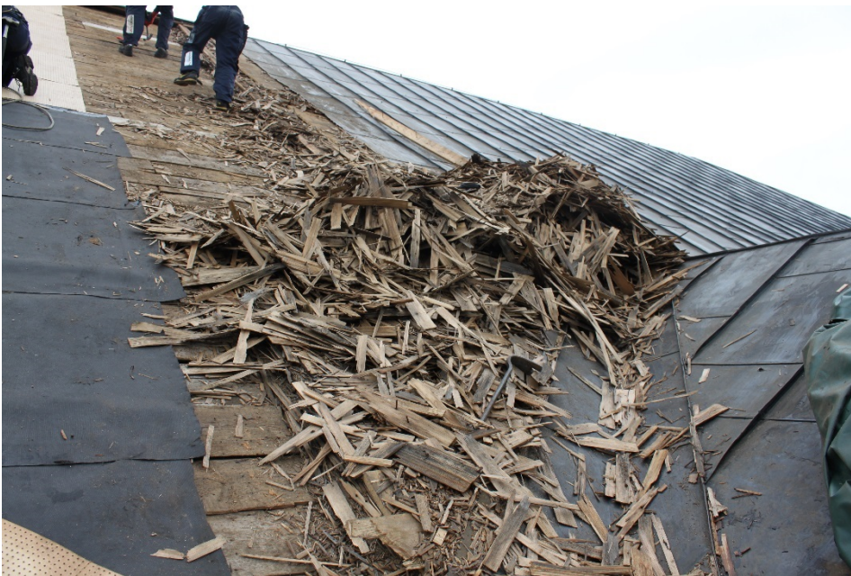
Figur 2 På grund av väderleken kom rivningen av det gamla taket att ske etappvis.
