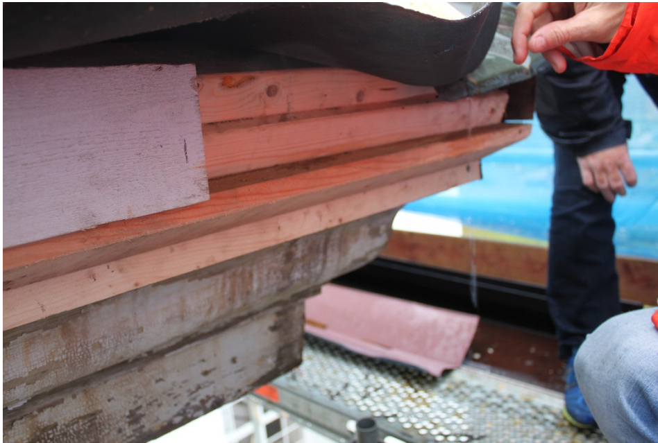
Figur 3 Trälagning i nordöstra hörnet. Ca 1 meter av listen behövde ersättas med ny. Den undre delen av taklisten kunde behållas.
