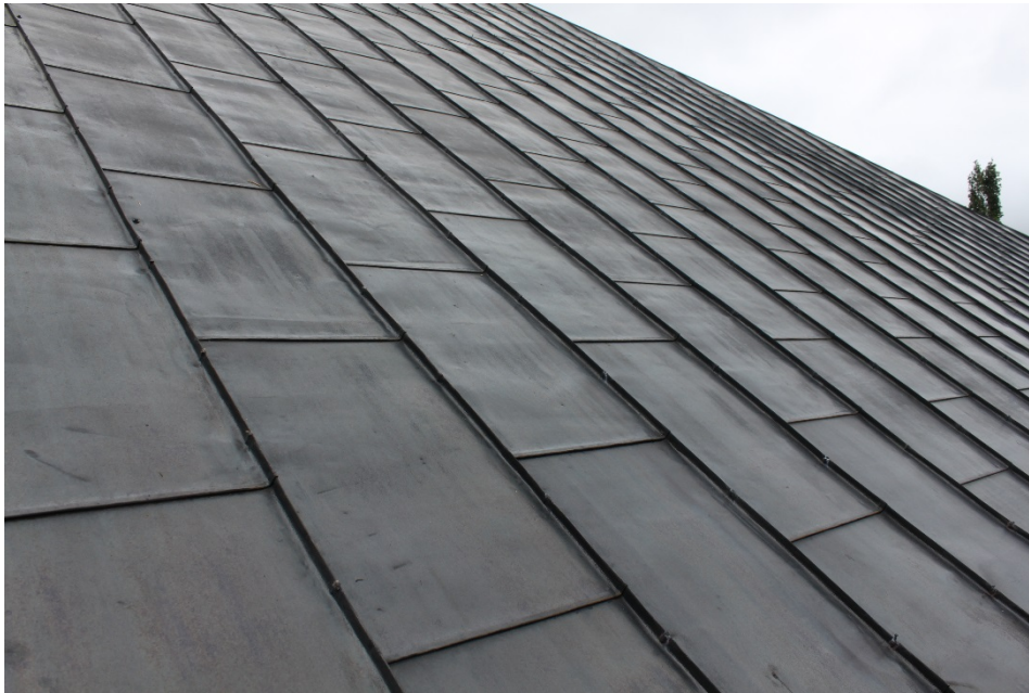
Figur 5 Taksfall före åtgärd.
