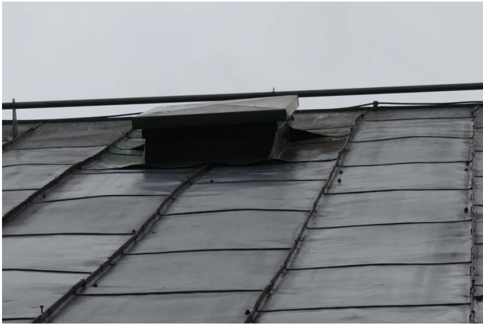
Figur 12 Taklucka på norra takfallet före åtgärd.
