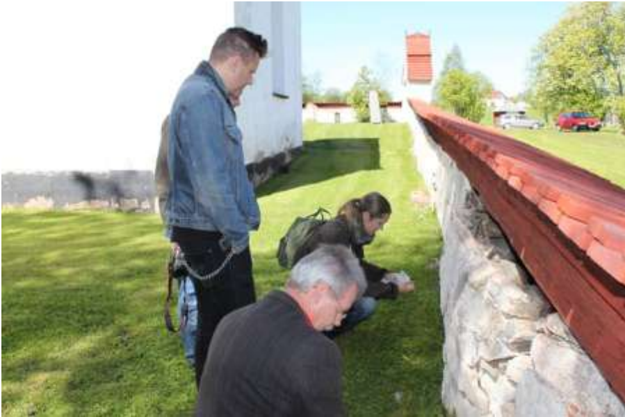
Bogårdsmuren vid Ovikens gamla kyrka är på ett ställe längs den norra sträckningen mycket illa skadat.
