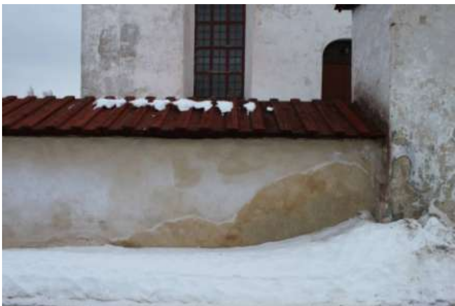
Foto taget den 7 mars 2012. Det mörka partiet har en ny puts med ett blandningsförhållande på 2:1. Putsen är i hög grad snutskurad. Denna yta hade inte riktigt härdat. I kanten mot den bevarade putsen syns vita utfällningar. Dessa finns också på den gamla putsen.
