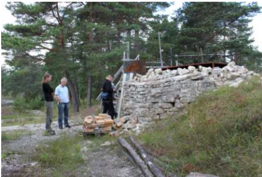
Byggnadshyttans kalkugn i Hejnum används för att bränna gotländsk kalksten. Den runda kalkugnen av kalksten är flera meter hög och invändigt klädd med eldfast tegel.
