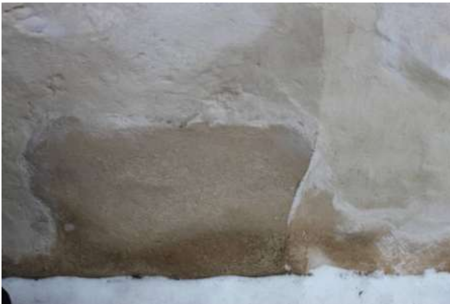
På detta ställe, mellan 10-11 meter, byggdes ett ganska tjockt lager puts upp för att komma i nivå med omgivande puts. Här syns den mörka utfällningen tydligt.
