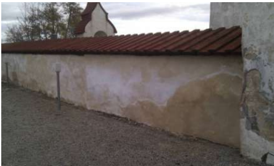
Foto taget av Thore Andersson hösten 2011. De vita utfällningarna syns tydligt och putsen har en väldigt varierande färg.
