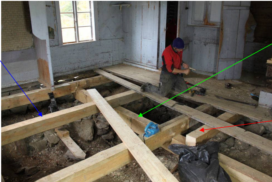
Blå pil visar ny kompletterande golvås, grön pil visar ny kompletterande bärlina, röd pil visar ny kompletterande ås för att stärka upp det slitna golvet vid spisen
