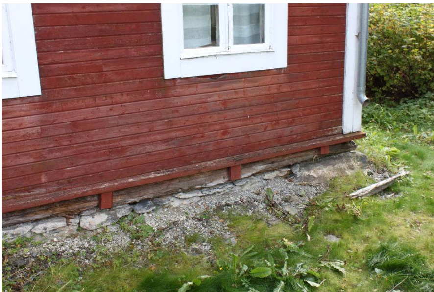
Syllstocken på väggen A 1 var rötskadad, den tidigare putsade sockeln har huggits bort
