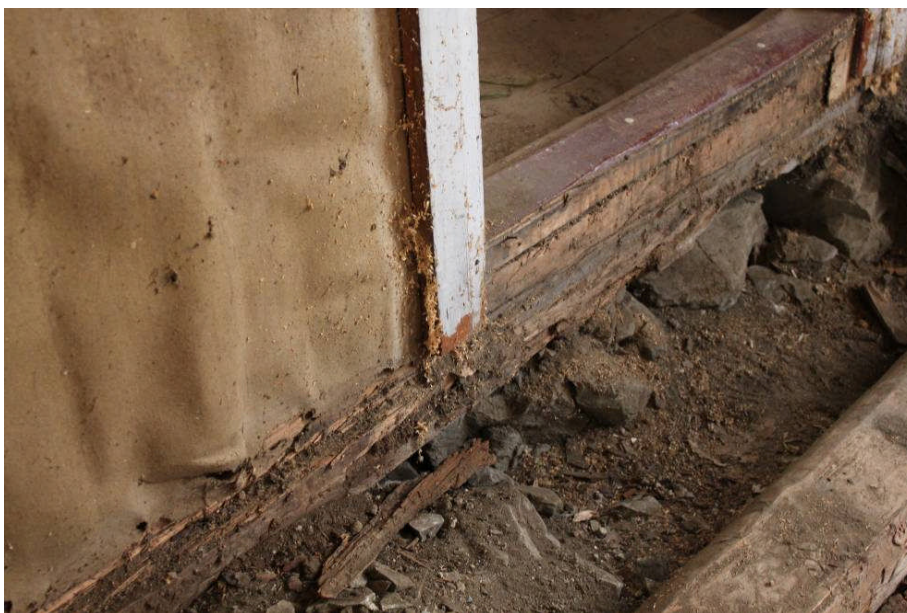
Syllstock i mellanvägg E hade ytliga rötskador
