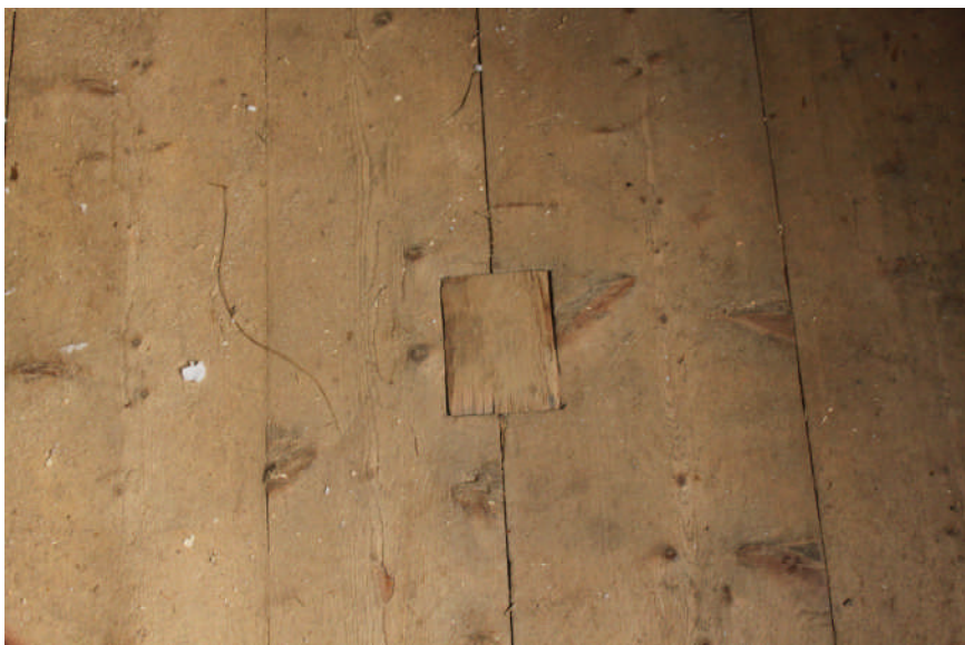
Skurkloss, i detta hål sopade man ner skurvattnet i bjälklaget
