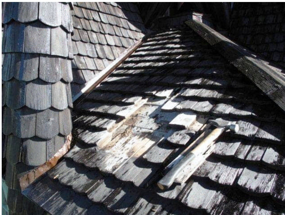
Rötskadade spån på klockbodens norra takfall togs bort.
