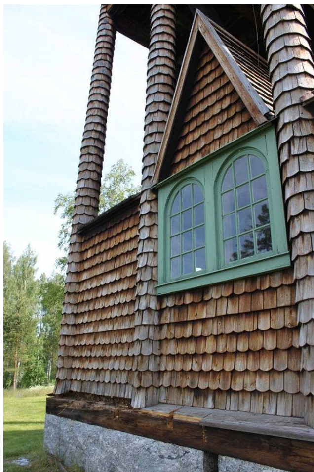
Fotbrädan är borttagen och rötskadorna var omfattande
