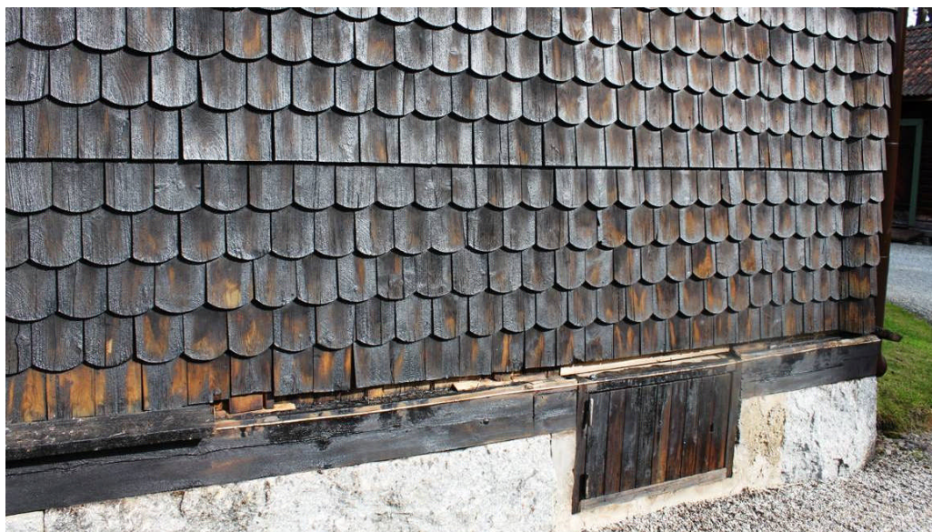
Den högra sidan av fotbrädan var rötskadad, det skarvades i med nytt virke
