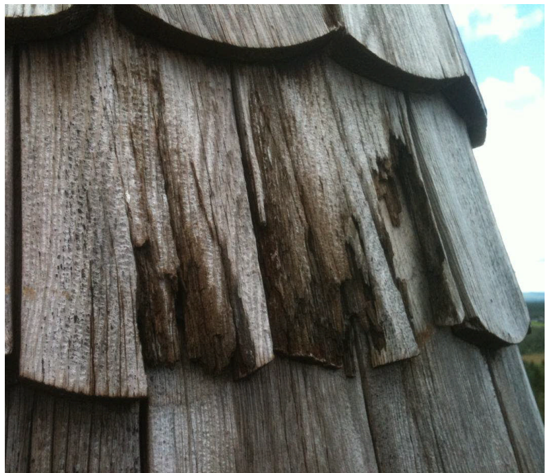
Skadade spån på spiran
