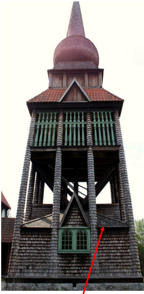
Norra fasaden, pilen pekar på skadat parti, se bilder på nästa sida.
