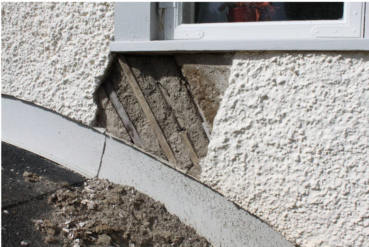
Skadan i närbild. Träräbborna syns och lerbruket har ramlat av och låg på källartaket. Det blöttes upp och återanvändes.
