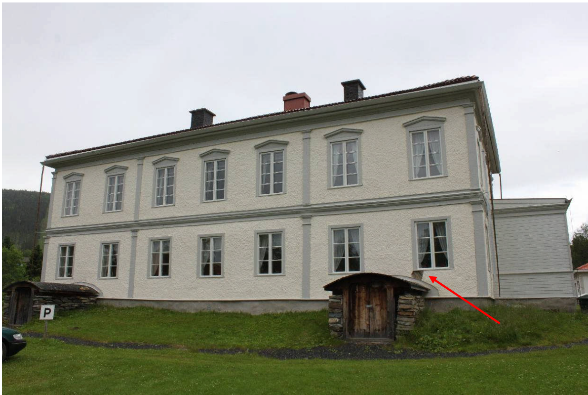
Fasad C innan åtgärderna. Putsbortfallet syns ovanför den högra källarnedgången.
