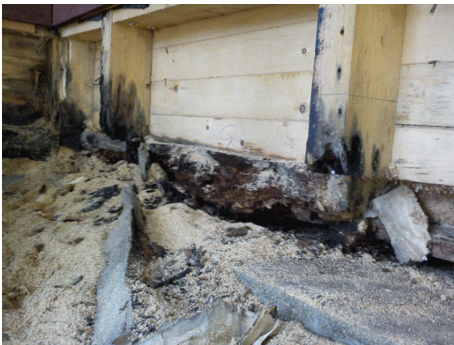
Syllbrädan är rejält rötskadad och har fått bytas ut, även de stående stolparna har fått skarvas i nederkant. Foto Fahlströms bygg
