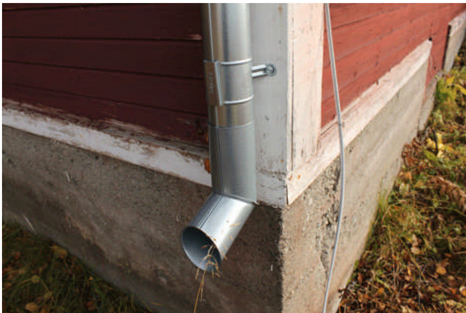
Skarp vinkel på stuprörets utkastare
