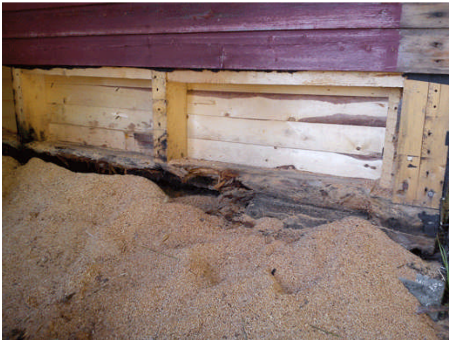
Spånet har tagits bort och nu skimtar man den rötskadade syllbrädan. Foto Fahlströms bygg
