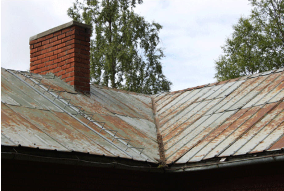
Taket hade stora partier med rost
