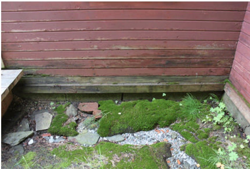
Husets baksida vid entrén, här var syllplanka och panelbrädor rötskadade
