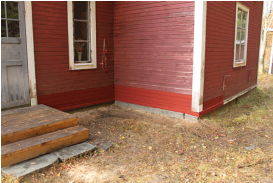
En bit av syllbrädan längre bort i bild har målats röd, den skulle dock ha målats vit, detta får återställas när man målar om samtliga fasader på byggnaden
