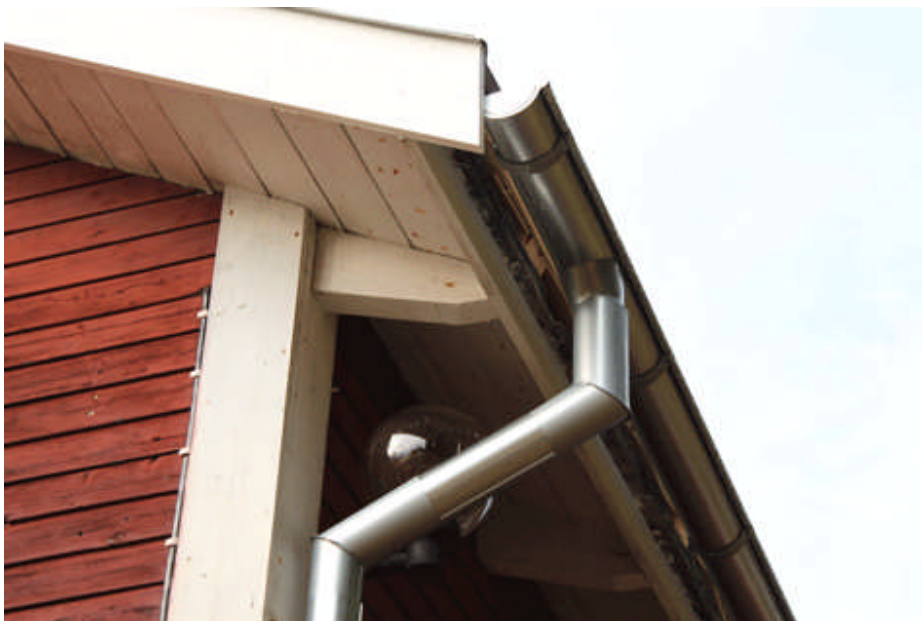
Nymonterat stuprör med skarpa vinklar
