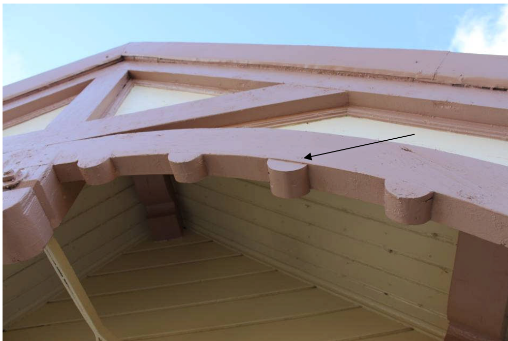
Frontespisens utsmyckning i form av halva cylindrar, den tredje till höger (som pilen visar) är utbytt samt den första och den femte till vänster. IMG_2106 Foto: Jenny Brantestad
