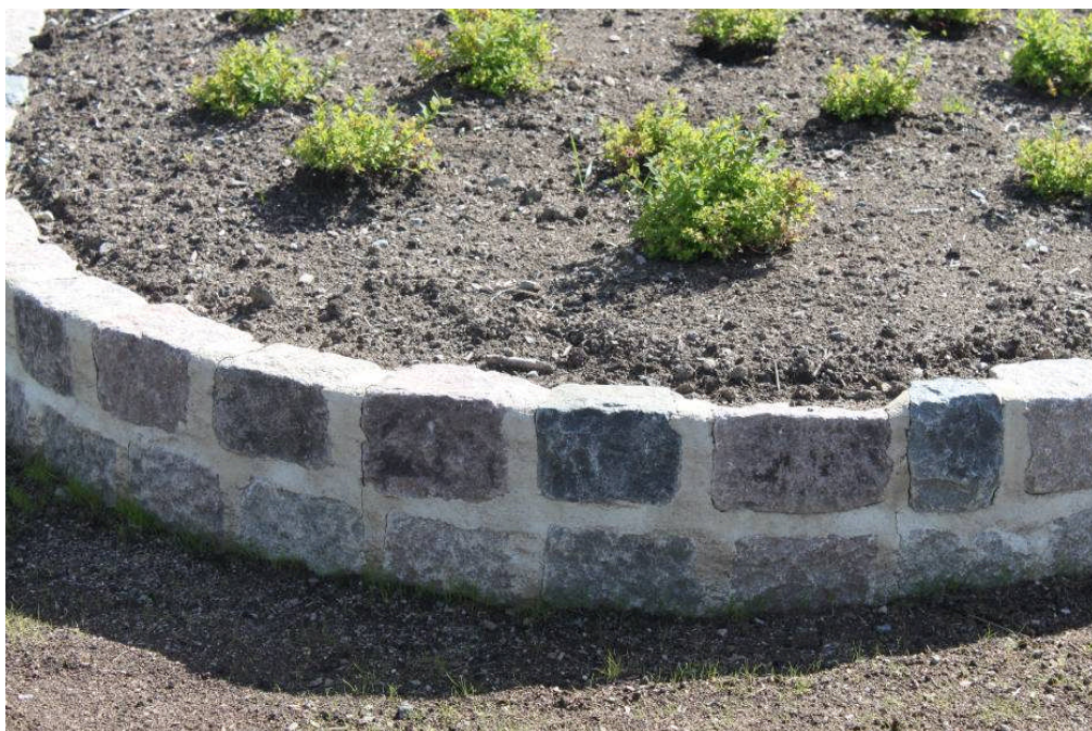
Bild 37: Planteringar med buskväxten Alpspirea. Sprickor i bruket mellan stenarna kunde ses vid slutbesiktningen men var till var till största delen åtgärdat till efterbesiktningen. (Digital bild nr.9167)
