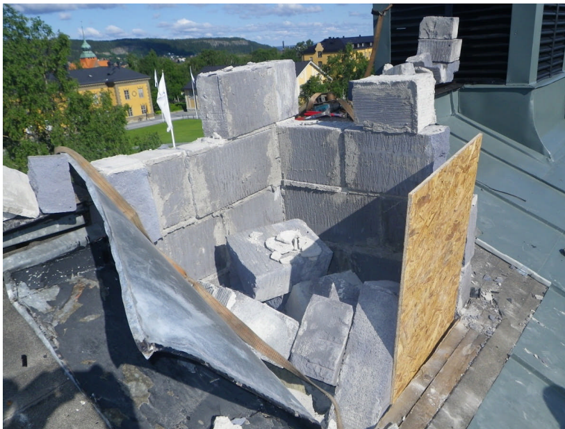
Skorsten ej i bruk, troligen från 50-talet. Den var i dåligt skick och fick rivas Foto: Rogers plåtslageri
