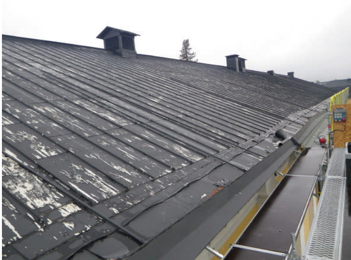
Färg har släppt från plåttäckningen
