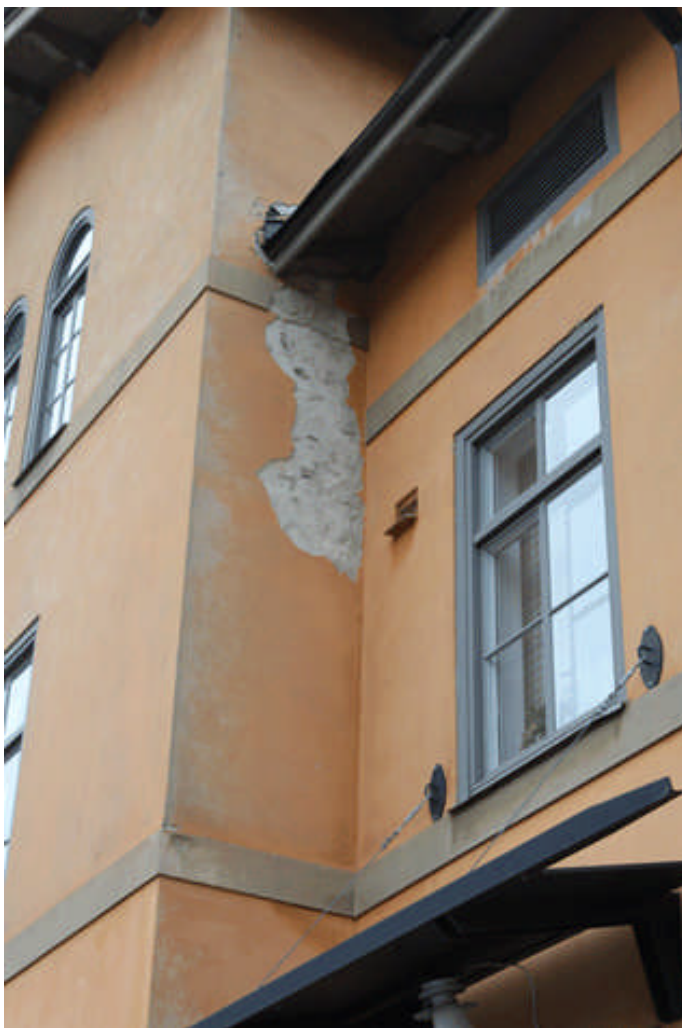
Putsskador på fasad mot norr
