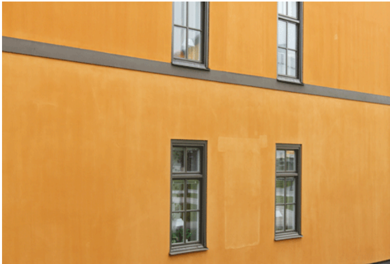
Igenputsade äldre fönsteröppningar, färgen har inte blivit lika mättad som övriga fasadytor
