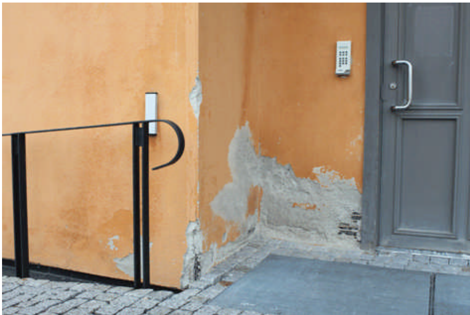
Putsskador vid entré på fasad mot norr
