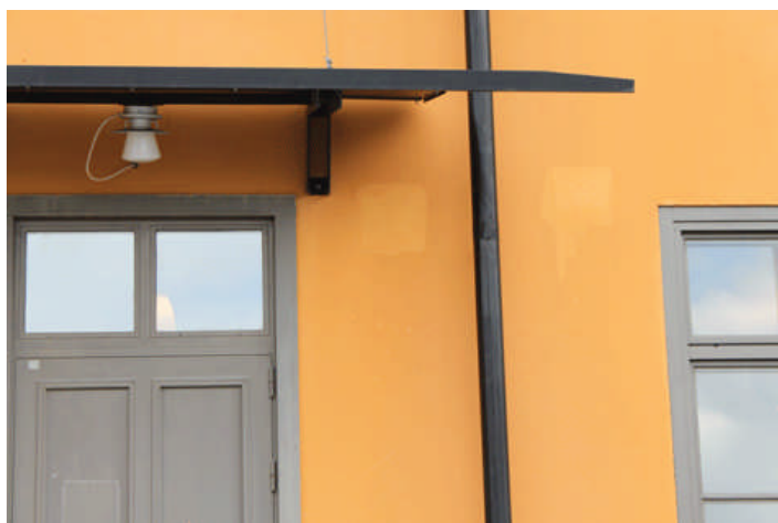
Igensatta ventiler på fasad mot norr, färgen har inte blivit mättad lika övriga fasadytor
