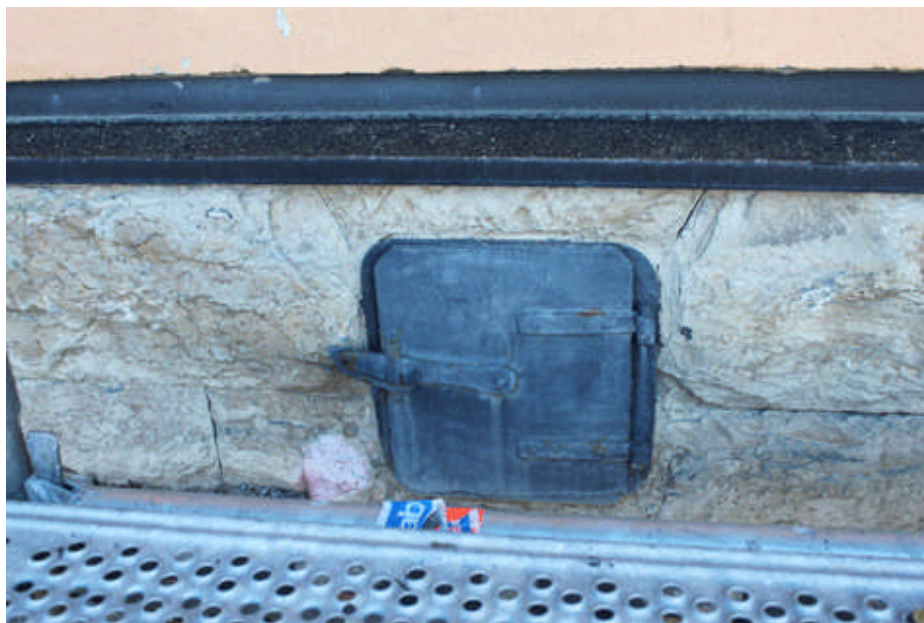
Ventilationslucka i stensockel, före målningsbehandling
