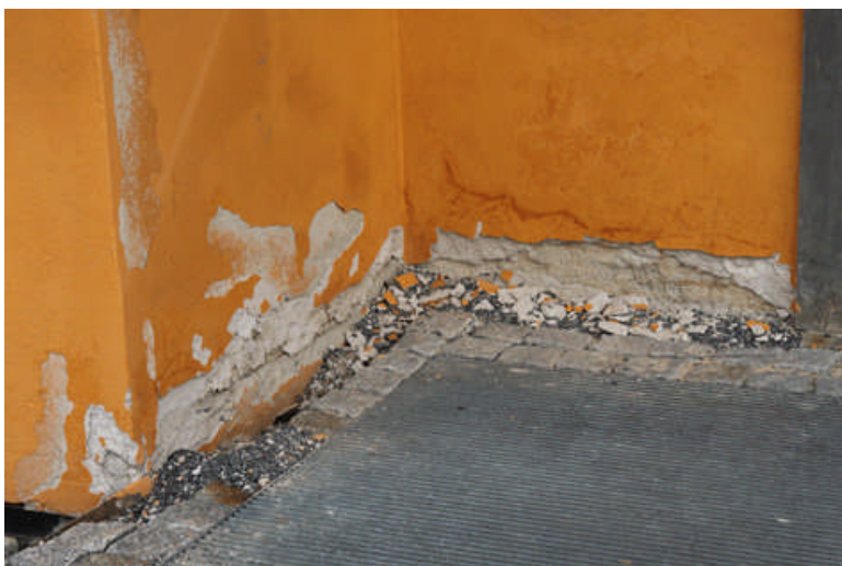
Putsskador som uppstått efter restaureringen av fasaden 2011
