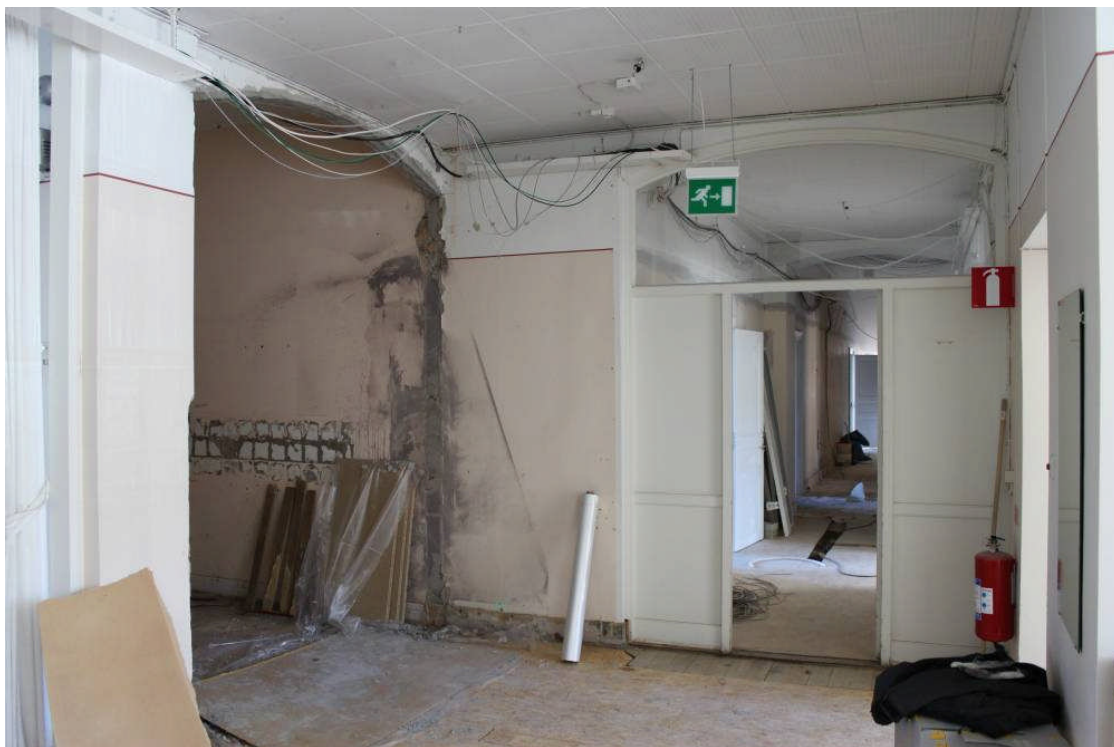
Bild 10. Väggen mellan de två rummen är riven och elkablarna hänger fritt sedan ”kabelhyllan” tagits bort. Linoluemattan är bortagen. Genom dörrglaspartiet syns korridor 36C.
