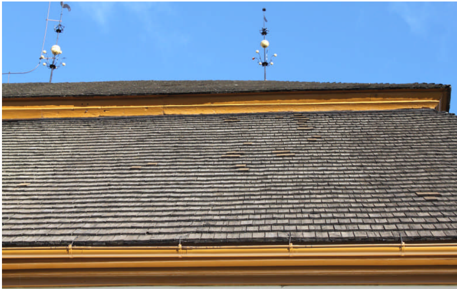
Bild 4. Del av långhusets tak där rötskadade spån bytts ut och tjärats två gånger med Claessons dalbrända trä tjära. Takfoten, hängrännor samt italianen har målats med linoljefärg pigmenterad med guldocker (digital bild nr 3153).
