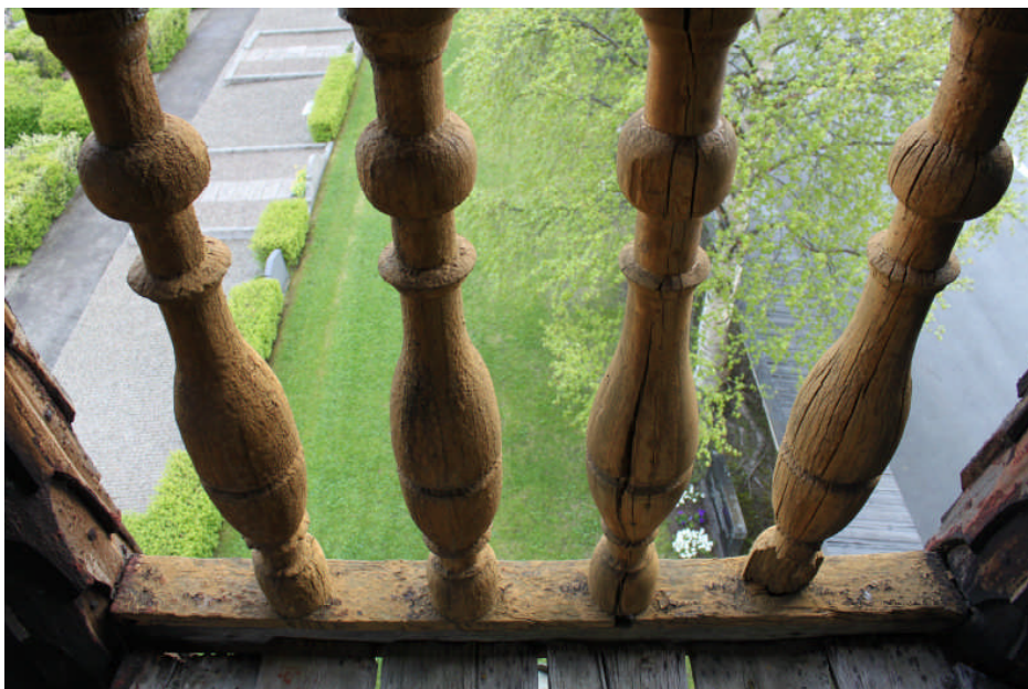
Bild 15. Balustraden före restaurering med skadade partier på balusterdockornas nedre del (digital bild nr 114)
