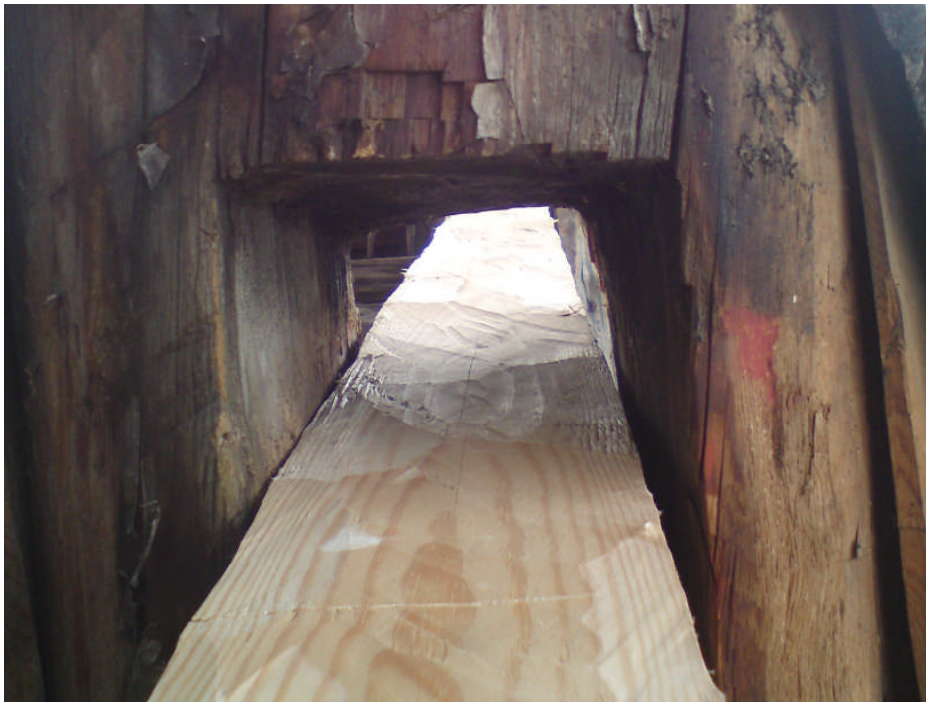
Bild 7. Den bärande bjälken som ligger i syd-västlig riktning, vid D-vägg, har bytts ut och skjutits igenom pelarna via urtag (Foto: Kyrktak Bygg & konsult AB).
