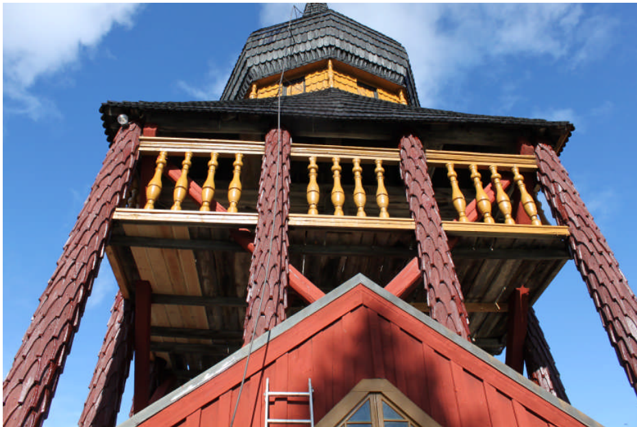
Bild 14. Klockboden samt snedsträvorna har målats med Äkta Falu rödfärg, pelarna har strykit med rödtjära (av märket Claesson) och balusterräcket, fönster, port och klockstapelns italian har målats med guldockra linoljefärg (Engwall och Claesson). Digital bild nr 3162
