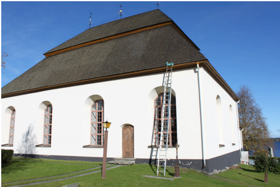
Bild 11. Kyrkan vid slutbesiktning efter byte av spån samt tjärning och målning av Italian, hängrännor och takfot (digital bild nr 3151)
