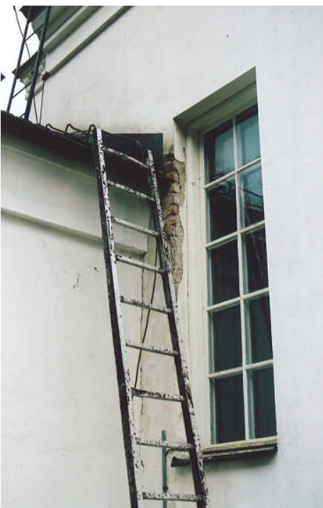
Putsskada där sakristia möter långhus
