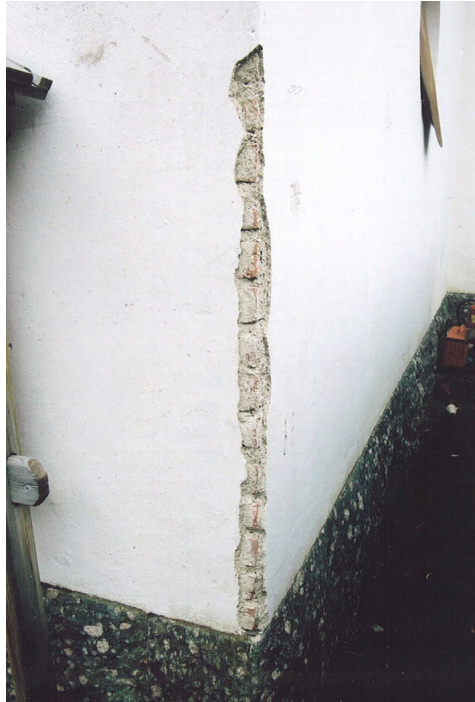
Putsskada på vapenhus
