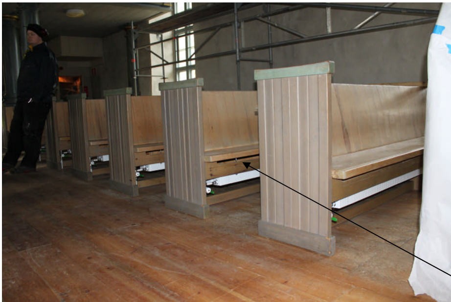
Golvet är återmonterat, bänkvärmare är monterade och skymtar under bänkarna, här syns ventilationsspringan i skyddsbrädan under bänksitsen
