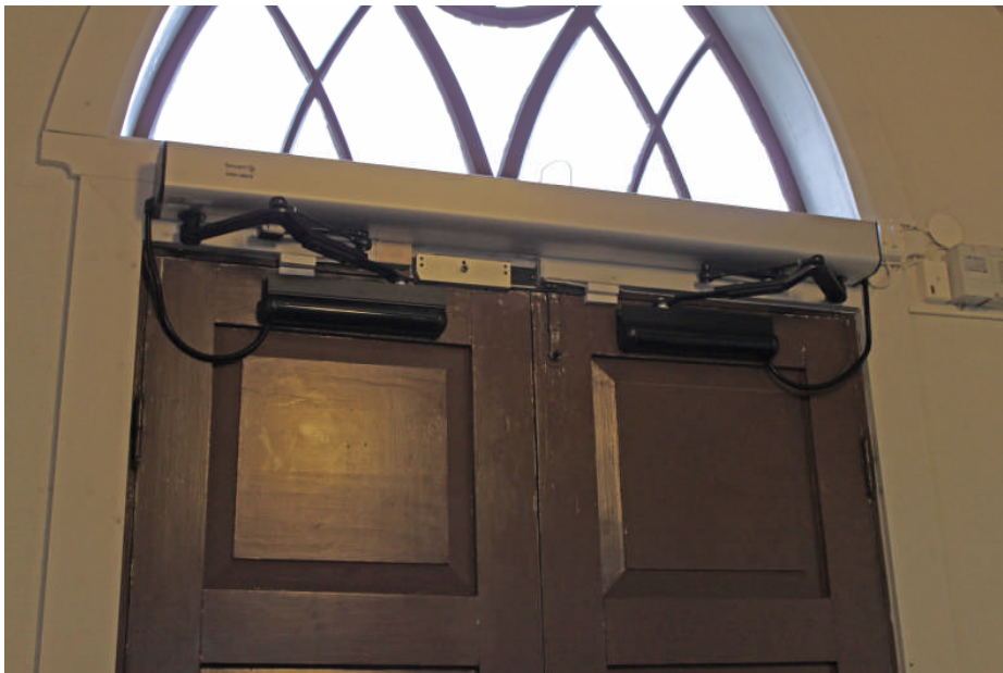
Automatisk dörröppnare på insidan av entrédörren
