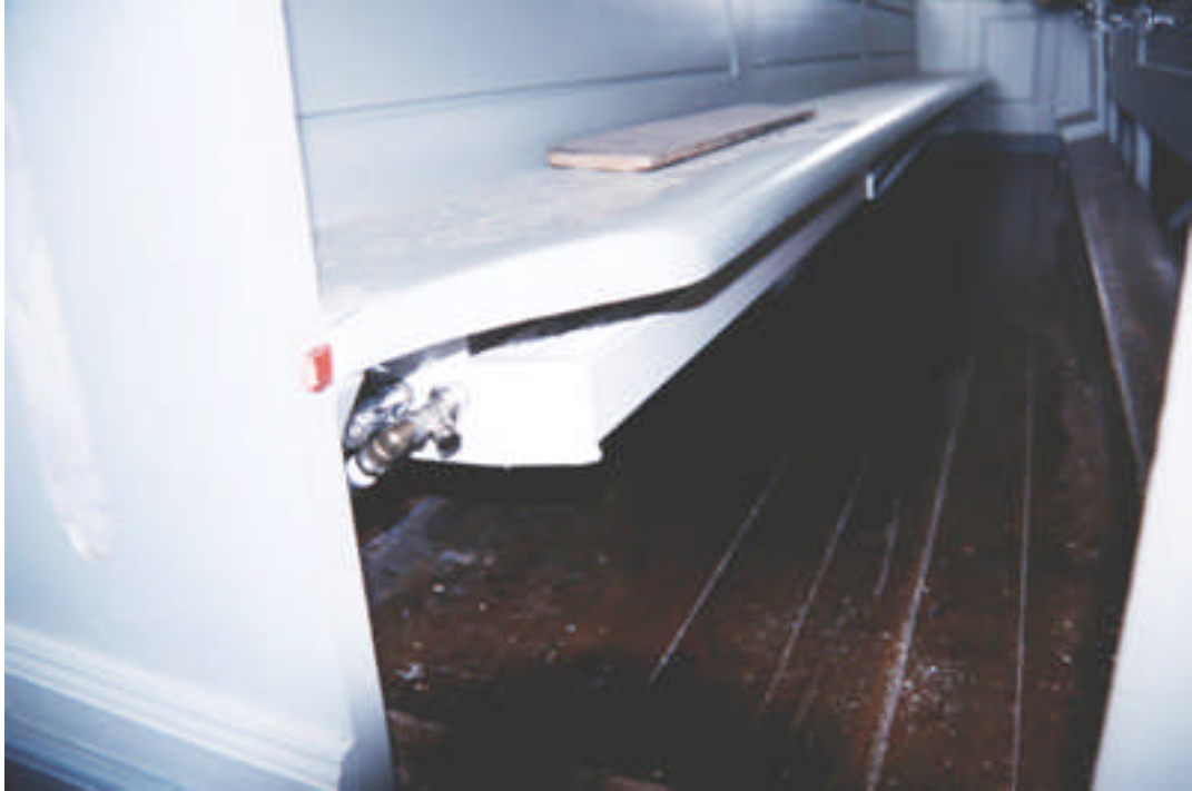
Bild 7: Radiatorer under bänkarna i långhuset.
