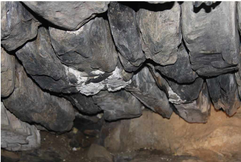
Bild 11. Jordkällare under rum D/sal. Den glugg som bildades när delar i valvet rasade vid arbete med bjälklaget har fyllts med sten och kalkbruk.
