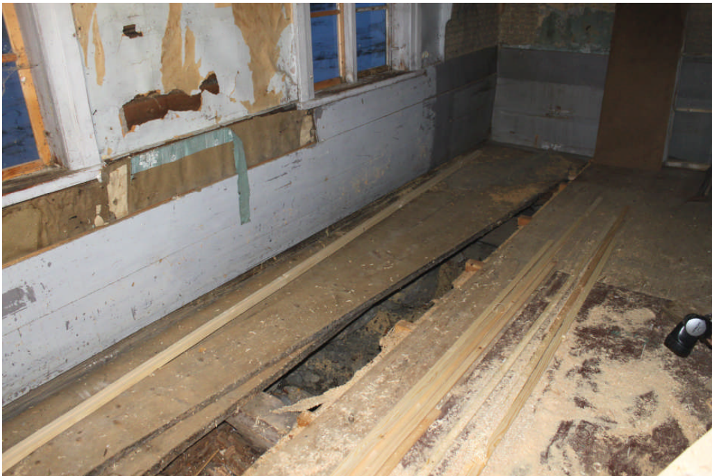
Bild 9. Rum B/kök. Golvet utmed A-väggen bröts upp under 2010 för att undersöka golvbjälklagets kondition. Detta har lämnats öppet för vidare åtgärder. IMG_6921
