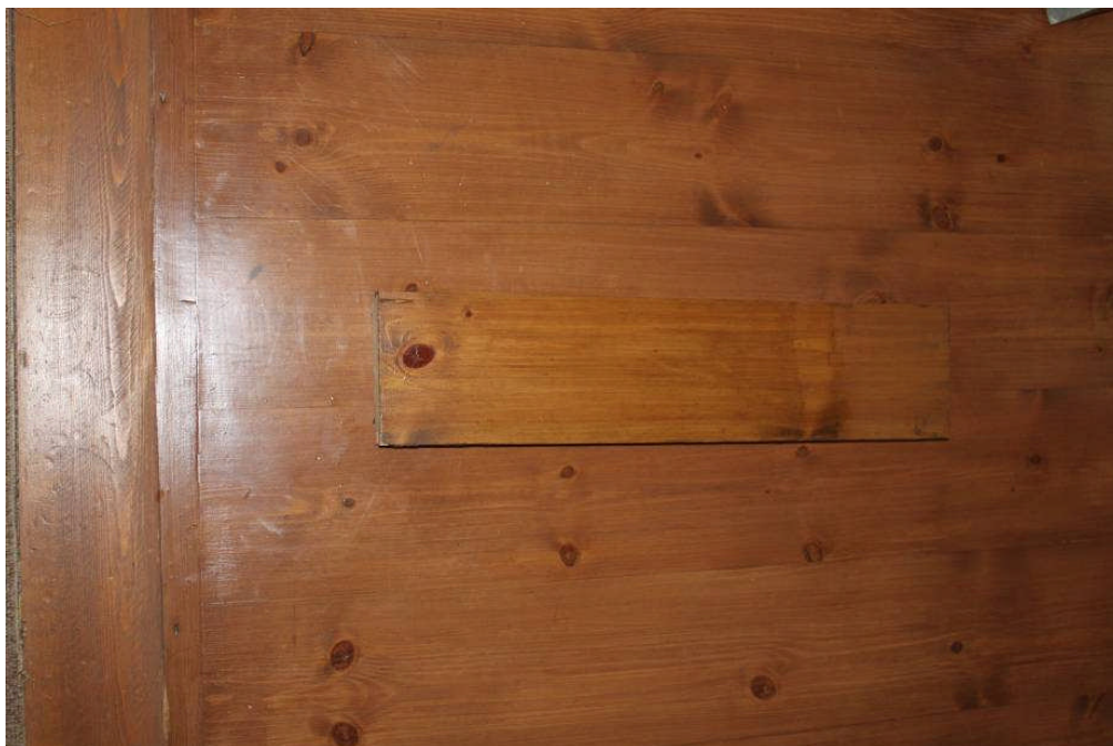
Bild 5. Uppstrykningsprovet passade bra mot befintliga golv, medan det mot det nylagda golvet syns att det har en annan nyans.
