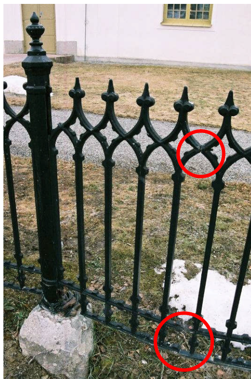
Bild 5. Sektion 12 var kraftigt böjd och hade brott i gjutjärnet. Byttes ut mot ny sektion som fanns lagrad. Stenen är gjord av betong.
