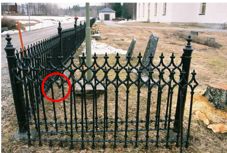
Bild 13. Några staketsektioner var i så dåligt skick att de byttes ut. Här är sektion 27 i det nordvästra hörnet (som står lutad mot sektion 26) där flera delar saknades.
