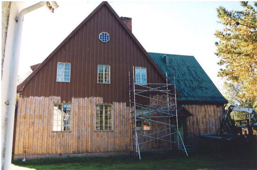
A-vägg efter att delar av fasaden skrapats (bild nr 02m099/02).
