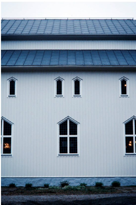
Här ser vi den nymålade fasaden och sockeln (Bild nr Jlm 09D0144)
