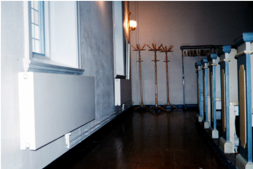
Nya element har monterats och rör har målats in i samma kulör som bakomliggande vägg (Bild nr Jlm 09D0123)
