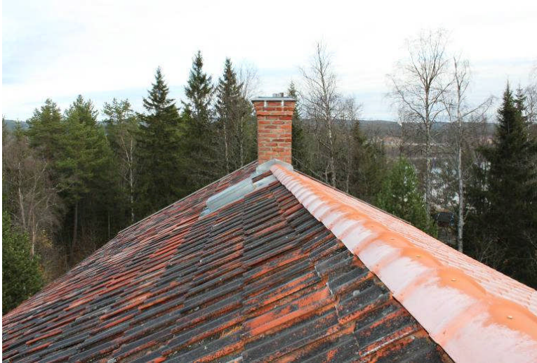
Bild 12. Restaureringen är klar och nockpannorna på plats. Det norra takfallet har gamla takpannor och det södra nya.
