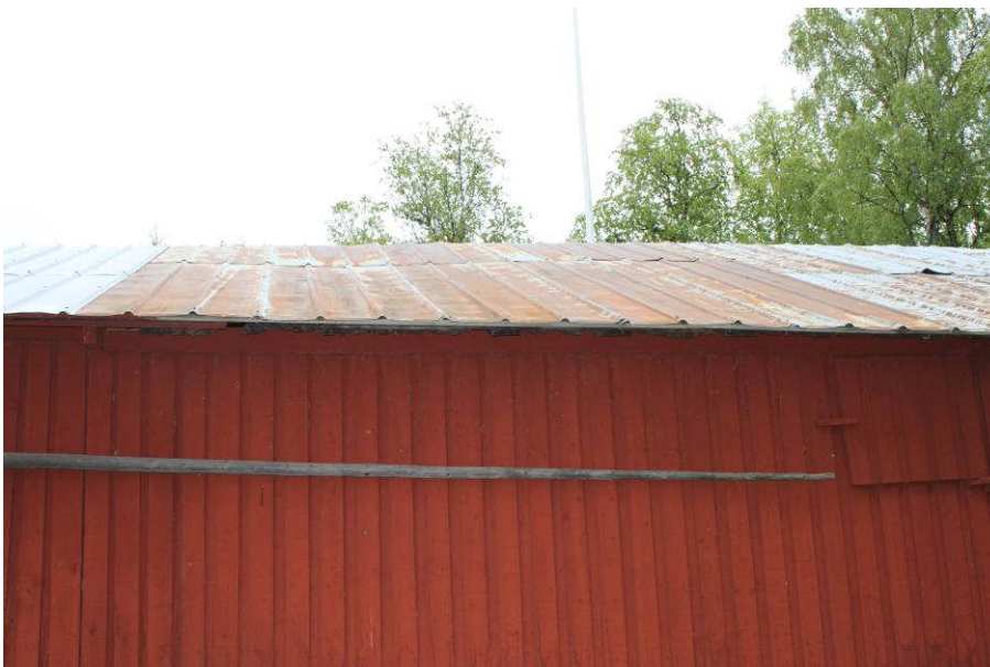
Bild 3. Pannplåten på ekonomibyggningen var mycket rostig.
