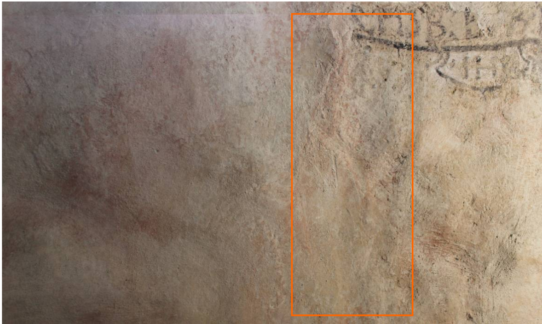
Södra långhusväggen, spricka som är lagad med målarlim och krita. Sprickan är retuscherad med pigmenterad kalkfärg.
