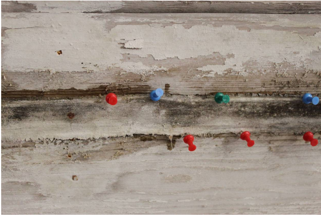
En gammal remsa av bomull som satt löst har limmats fast med fisklim, limmet är vattenlösligt och torkar relativt långsamt. Bilden visar även flagnande färglager.
