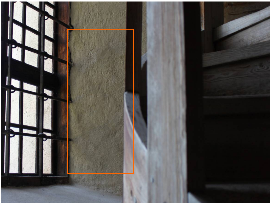
Lagad spricka i fönsternisch vid västra kortsidan. Putslagning är retuscherad med pigmenterad kalkfärg
