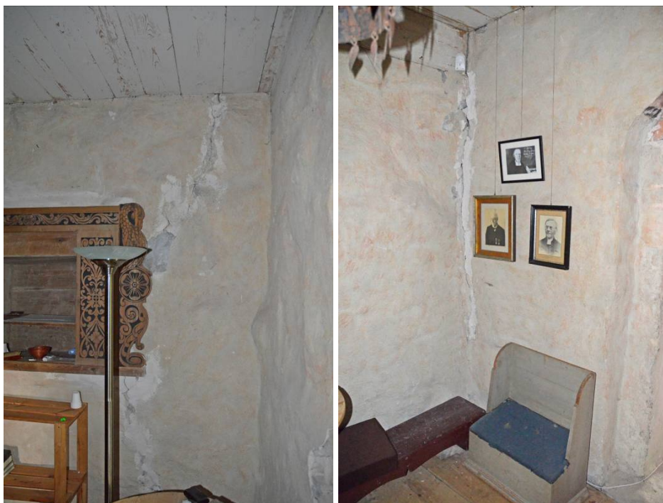
Putsskador i sakristian. Foto Erik Olsson
