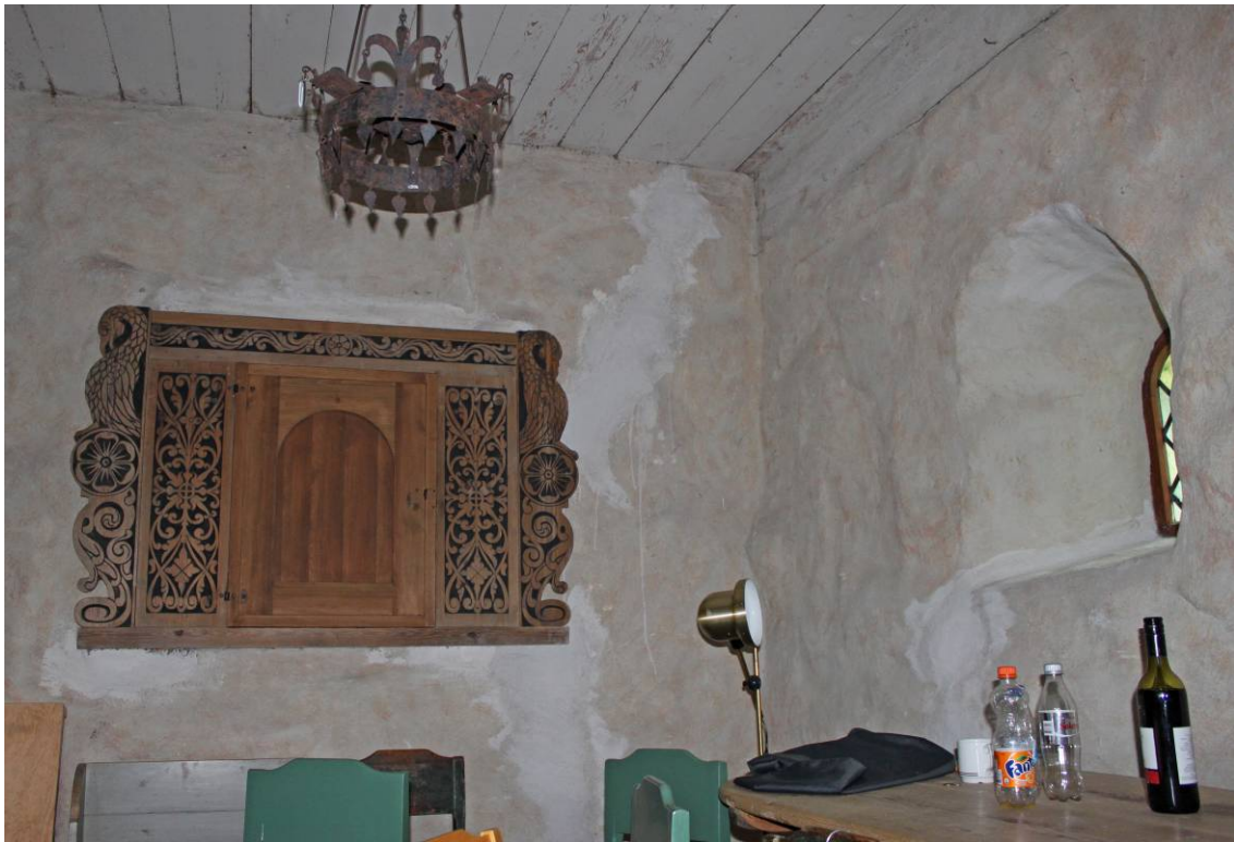
Putslagningar i sakristian, norra innerväggen
