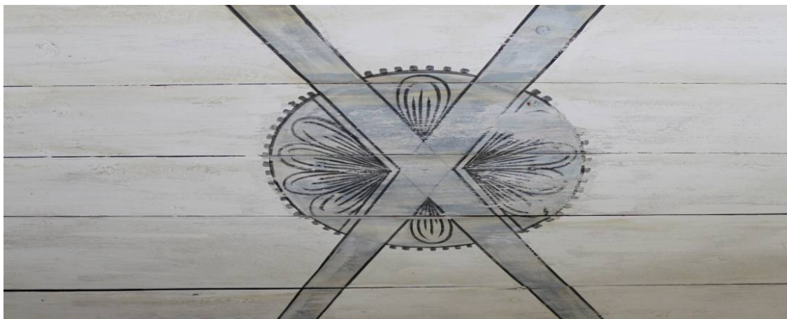
Takrosett före åtgärd. Här ser vi att färgskikten bleknat/lossnat.
