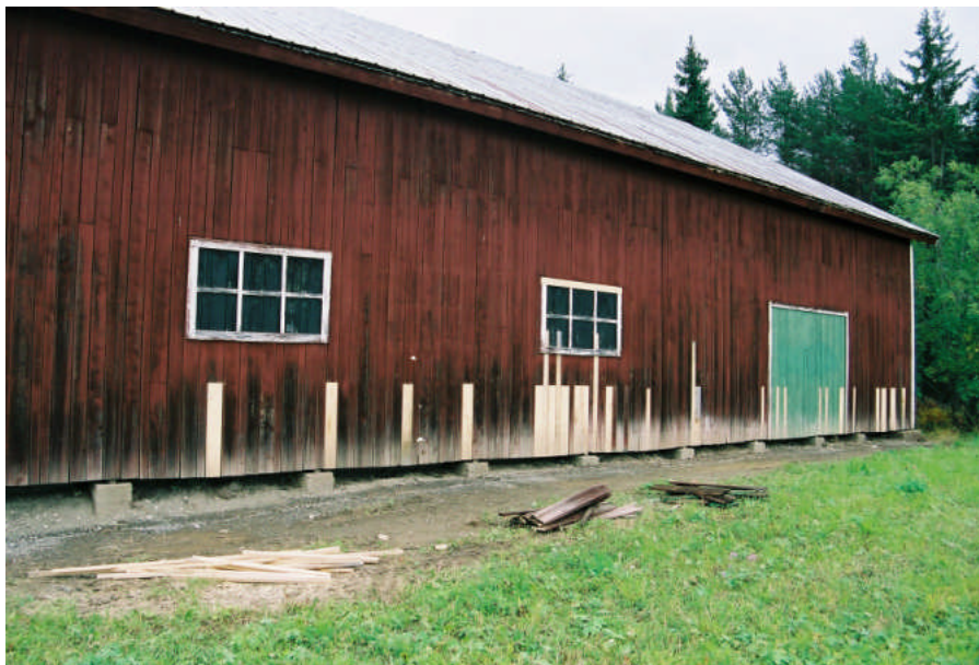
Ilagningar på den västra väggen (bild nr 04m131/26).
