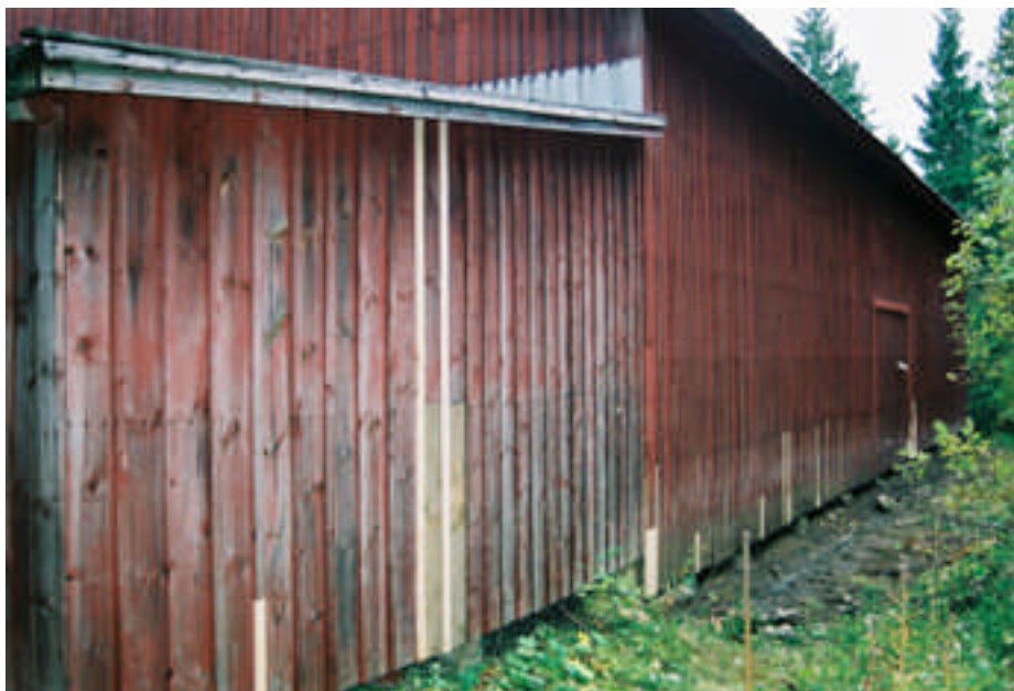
Ladans norra vägg där stolpen närmas utbyggnaden skarvades i längst ned mot mark (bild nr 04m131/06)
