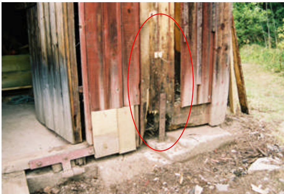
Vid den södra fasaden fanns i stolpen till höger om dörren angrepp av hästmyror (bild nr 04m132/26).
