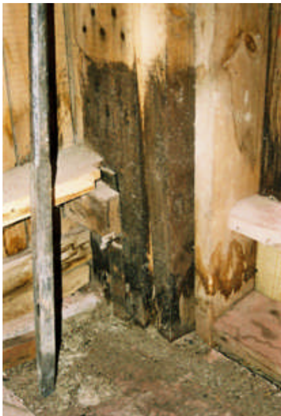
Angreppet av hästmyror sett från insidan av byggnaden (bild nr 04m132/30).
