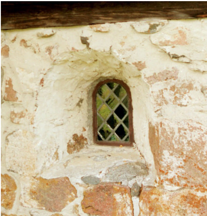
Sakristians fönster innan fönstret målats och solbänken kommit på plats.
