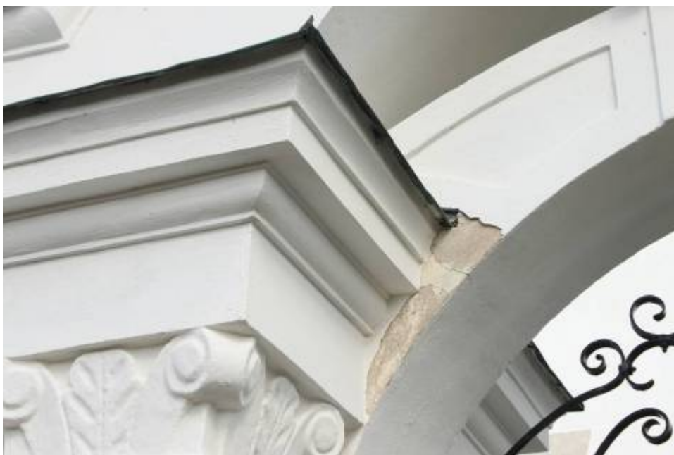
Putsskada på den undre bågen, fasad mot väster
