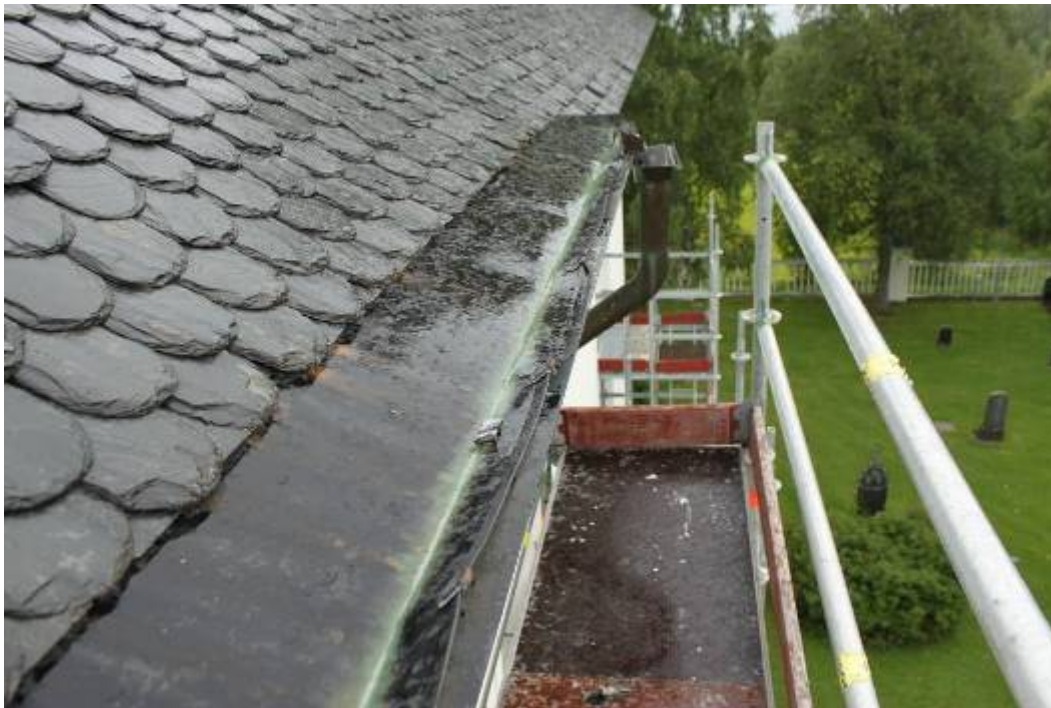
Kopparplåten på bilden är från 1970-talet. Plåten som sitter ovanför entrén på långhusets södra fasadsida har bytts ut till ny under 2013 och stupröret har demonterats.
