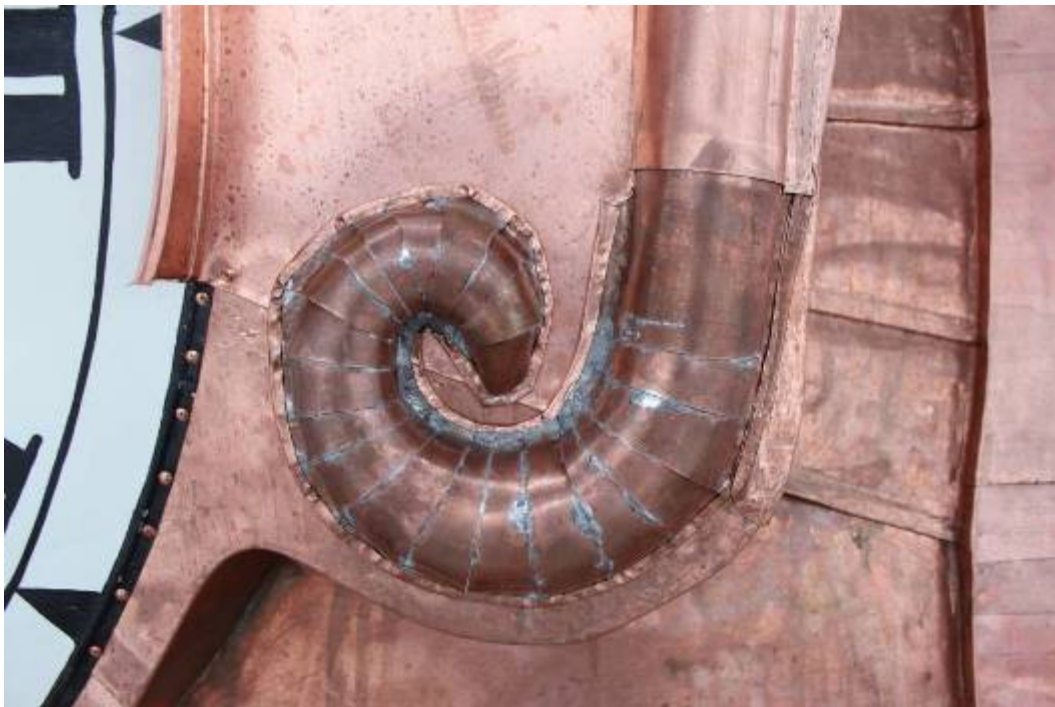
Detalj av plåtutförande på tornuren. De mindre bitarna har fått lödas ihop
