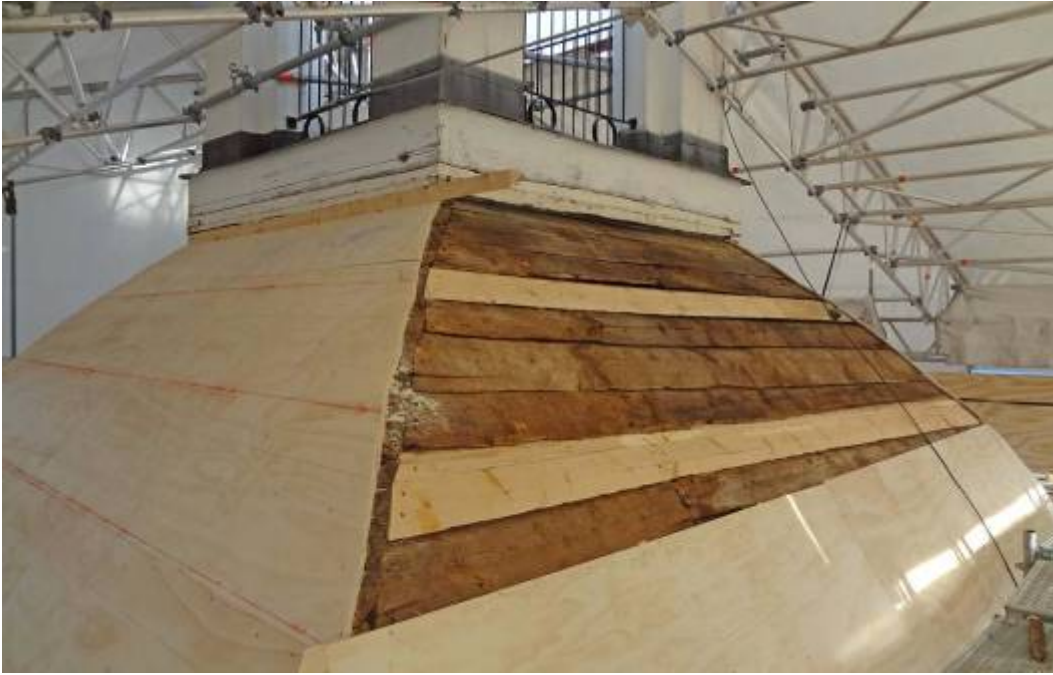
Furuplywoodskivor i färd att monteras. Här ser vi även att ett par rotebrädor har bytts ut, fasad mot söder. Foto: Melker Halvarsson
