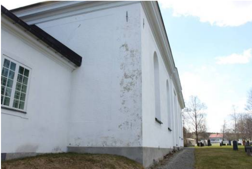
Färgbortfall på långhusfasadens östra fasad. Bortfallet är koncentrerat till det slätputsade parti som ramar in de spritputsade ytorna. En spricka ovanför sakristians norra takfall skymtar också fram.
