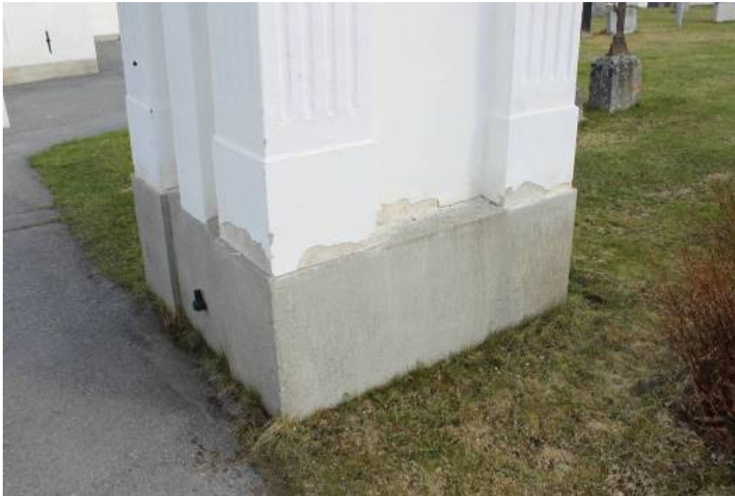
Sjok av ytputs har fallit av längst ned mot sockeln
