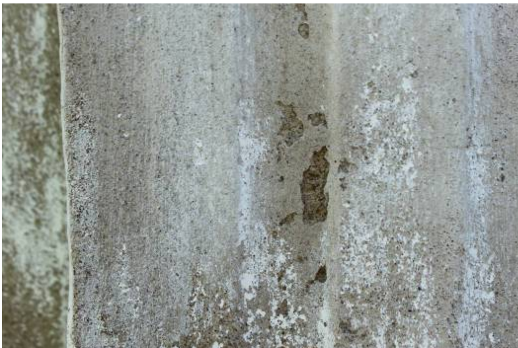
Detalj av högtryckstvättad pilaster på stigporten. Högtryckstvätten kan riskera att ytputsen delvis slås sönder, här hade några urslag skett
