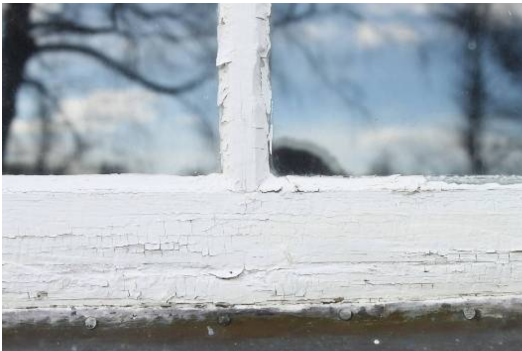
Samtliga fönsterbågar och karmar uppvisade kracklerade färglager på långhusfasaden mot söder
