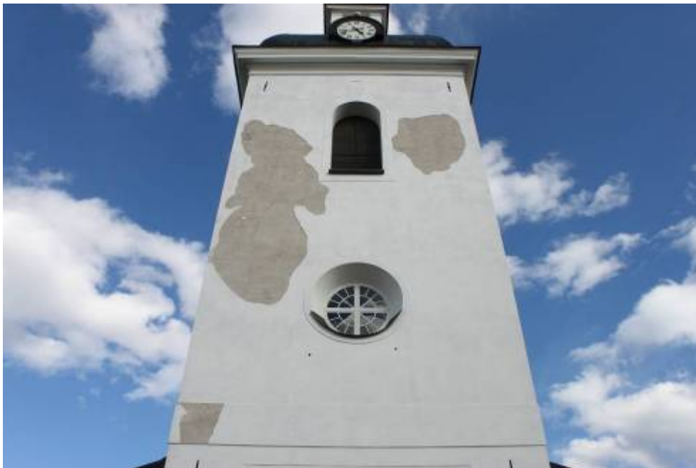
Tornfasad mot väster, stora sammanhängande sjok av ytputsen har lossnat
