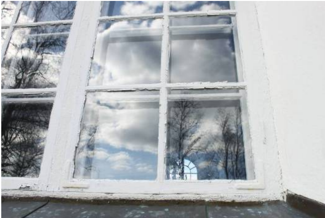
Kittet har spruckit, fönster på fasad mot söder
