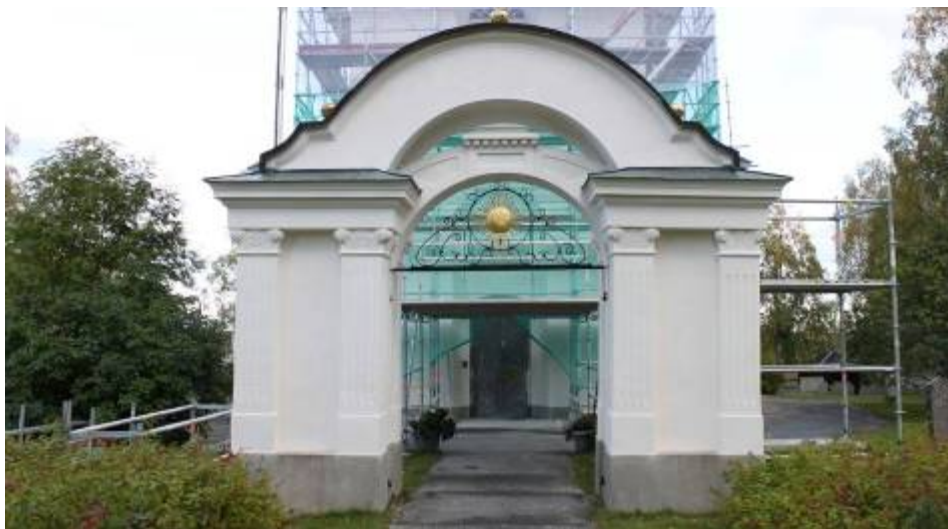
Stigport, fasad mot väst, avfärgning är utförd
