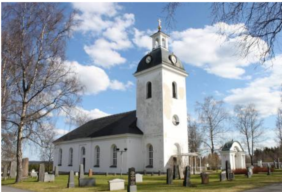
Torn och långhusfasad mot norr. Här syns färgbortfallet på tornets norra fasad.
