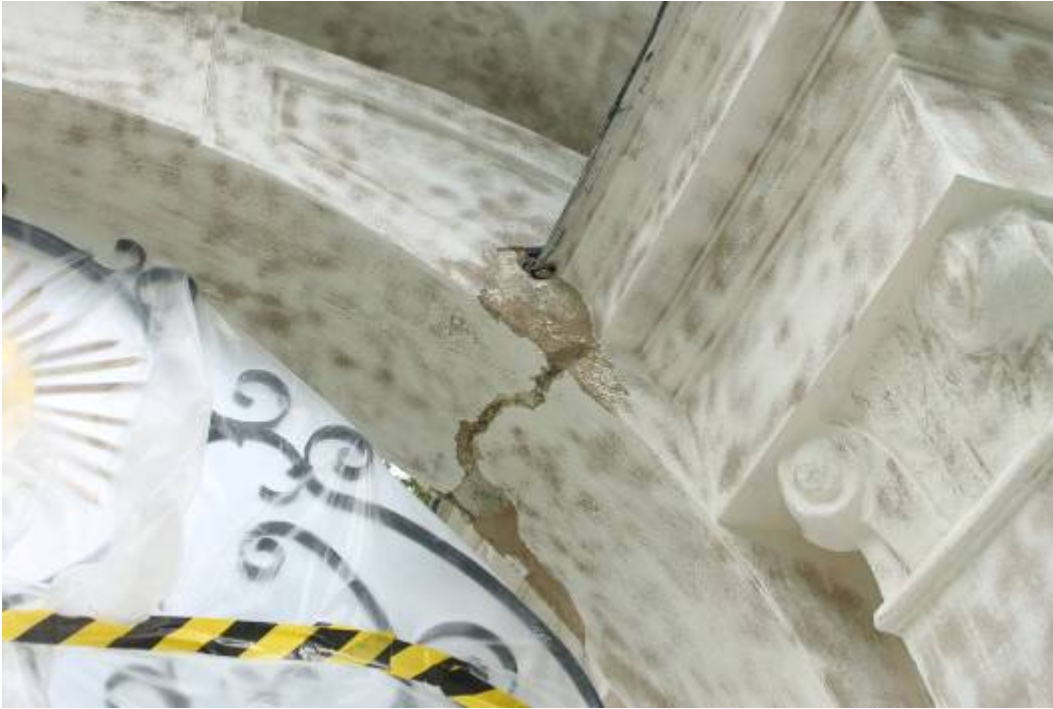
Putsskada i stigportens undre båge
