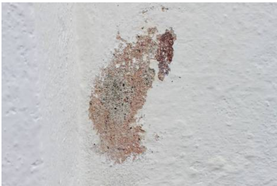
Bild tagen 2013, rosa och röd kulör framskyntar på slätputsat parti precis till höger om den igenmurade entrén på långhusets norra fasadsida. Om detta är ett äldre färglager eller möjligen en utfällning av något slag har inte undersökts.
