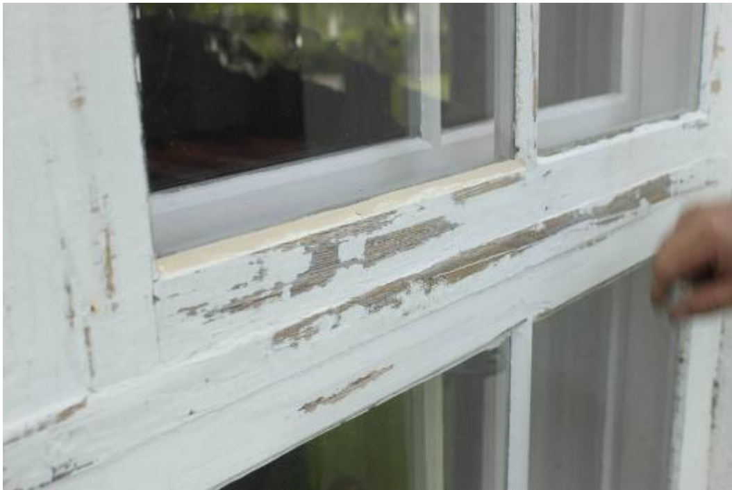
Falsen har nu kompletterats med nytt kitt. Lösa färglager har tagits bort, det mesta av de äldre färglagren kunde sitta kvar inför målning av bågar och karmar på den norra långhusfasaden.
