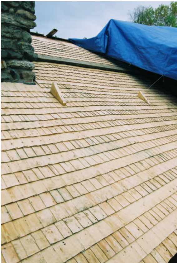
Spånen är lagda med varannan rad åt höger respektive vänster (bild nr 04m139/30).
