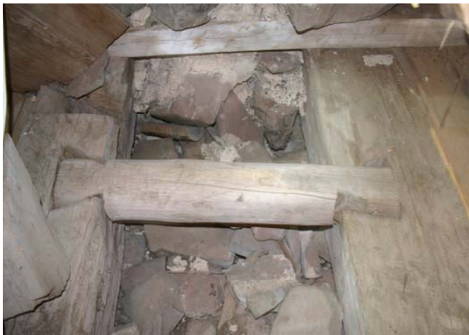
Bild 7. Bindbjälke mellan yttre och inre murrem på södra väggen. Bjälken är läst med laxar i ändarna.
