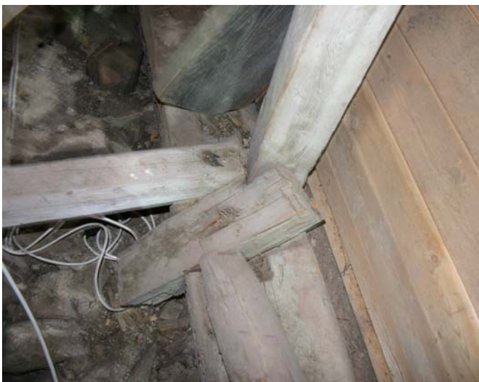
Bild 8. På södra murremmen intill knäbocken på takstol nummer 5 sitter en avkapad bjälke som kan antas vara en rest av ett äldre valv i kyrkan.
